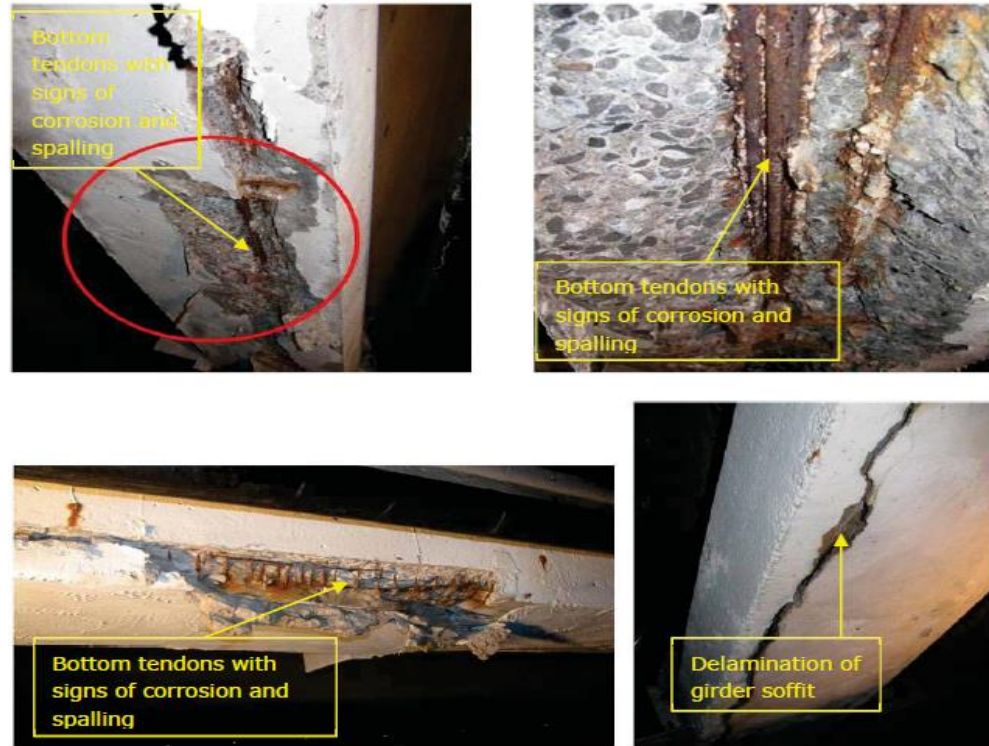
Figure 5 - Signes de détérioration observés sur les poutres de rive
