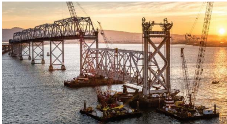
Figure 52 – Le pont Oakland Bay à San Francisco – Dépose d'une travée de 504 pi (source : avec la permission de Foothills Bridge Co (photo de Sam Burbank))
