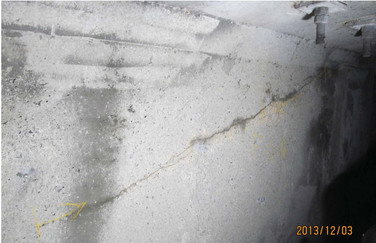
S5.PC.28W-29W.P1.a – 6549 (câble #16 – extrémité ouest face aval)
