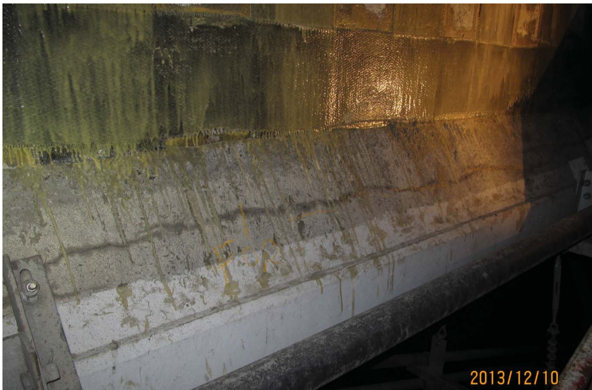
S5.PC.6W-7W.P1.c – 6713 (fissure horizontale semelle inférieure – extrémité est face aval)
