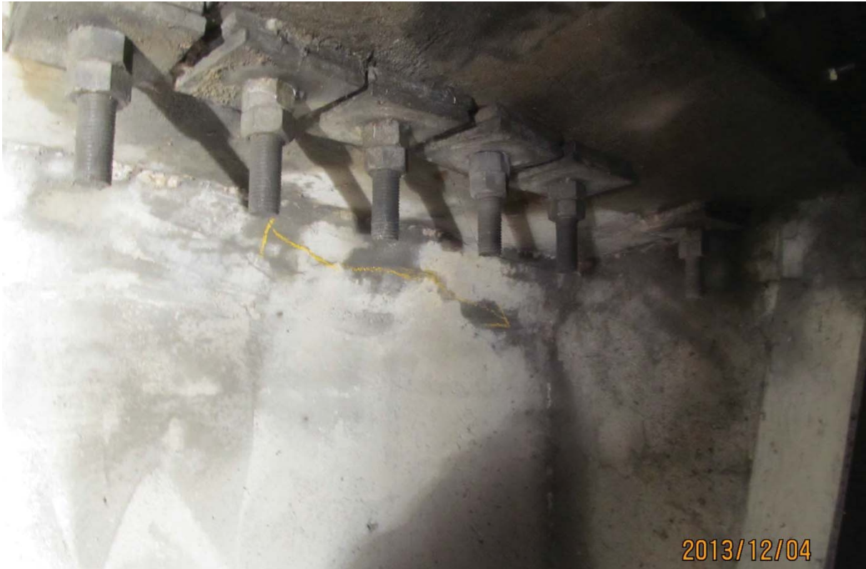
S5.PC.13W-14W.P1.c – 6569 (câble #24 - extrémité est face amont)
