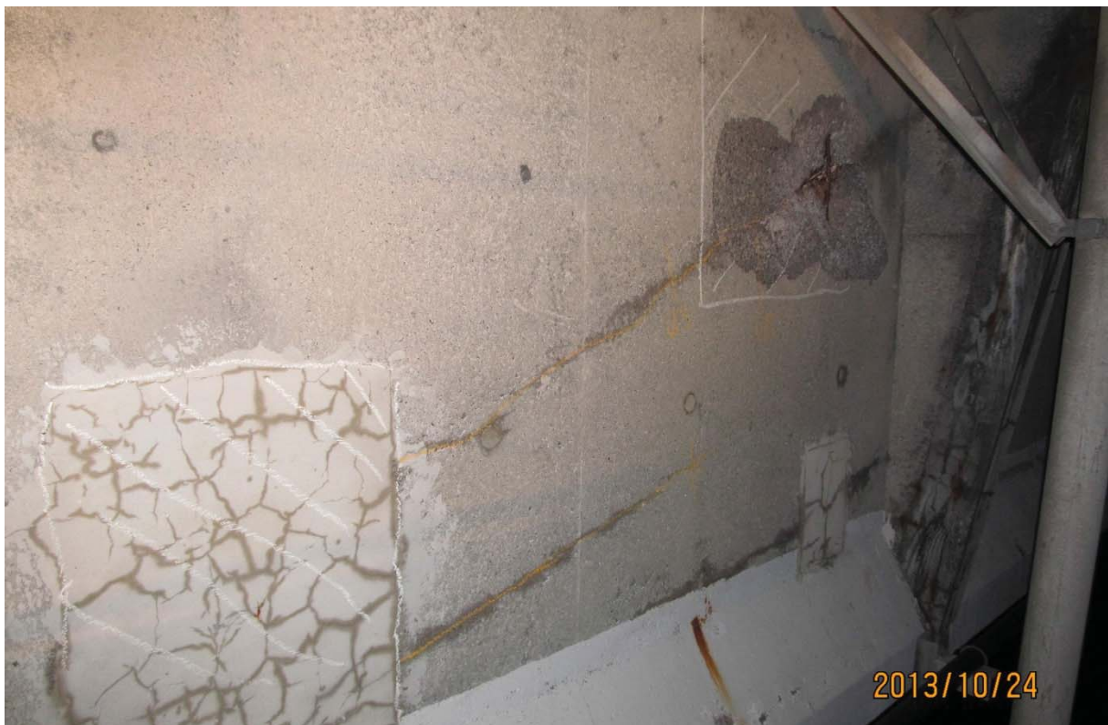
S5.PC.39W-38W.P7.b – 5903 (câbles #23 et #24 – centre est face amont)
