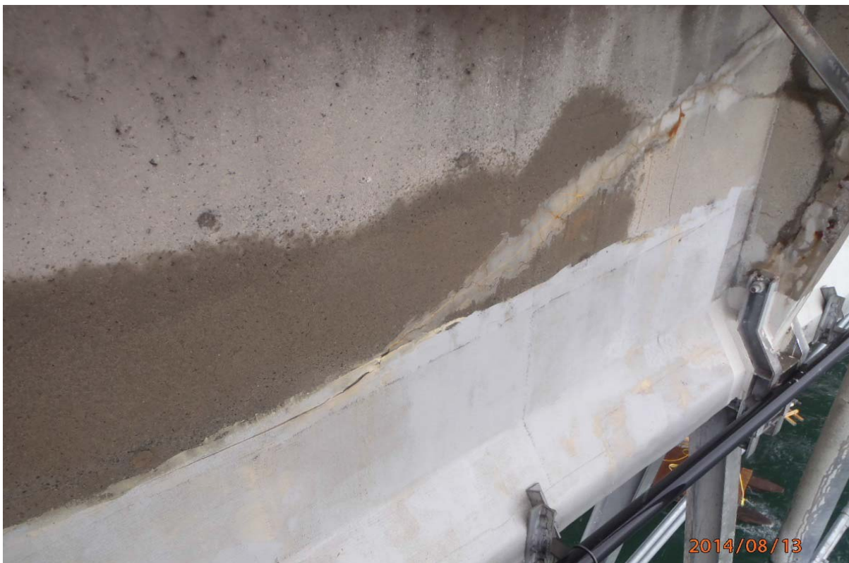
S5.PC.31W-32W.P7.g – PH.20140813_P7_31W-32W_061 (câble #24 - extrémité centre face amont)
