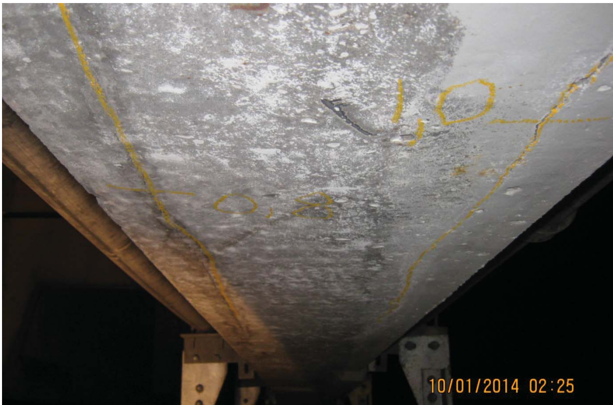
S7.PC.11E-12E.P1.b – 0263 (soffite - extrémité ouest)
