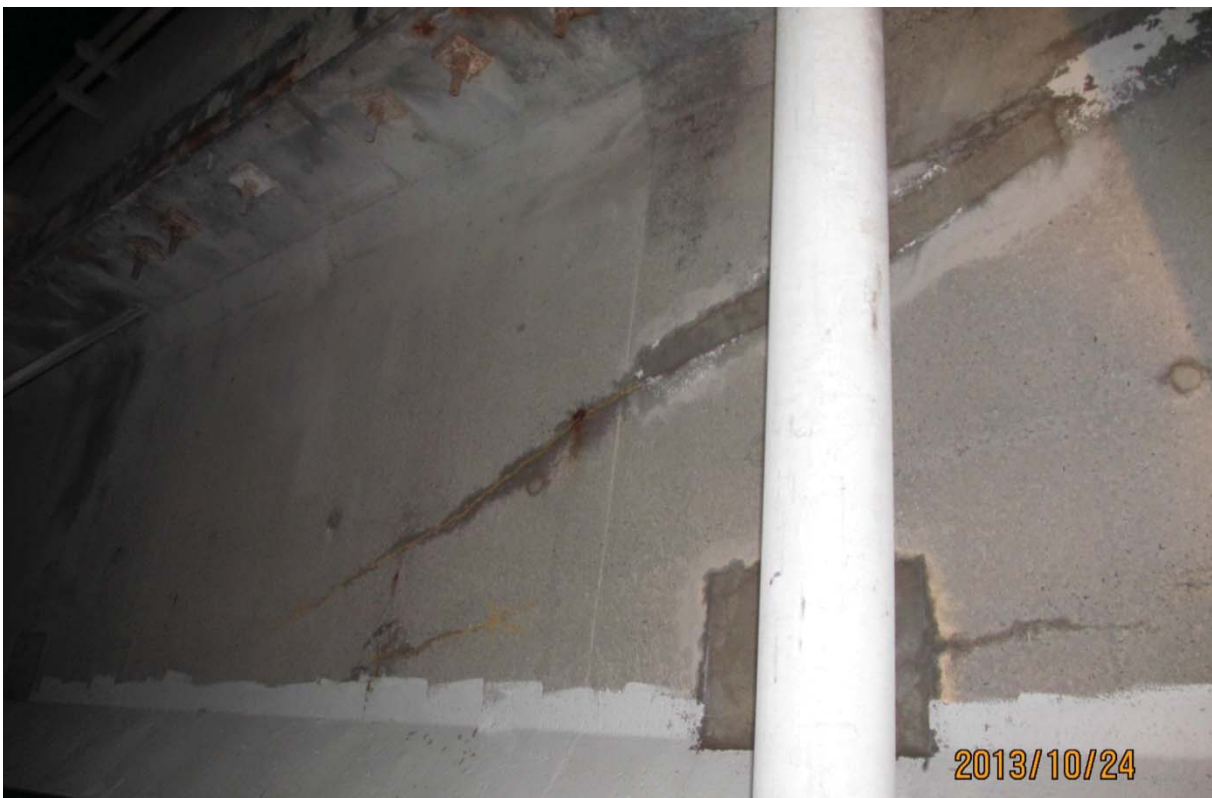
S5.PC.37W-38W.P7.b – 5916 (câbles #23 et #24 - centre est face amont)
