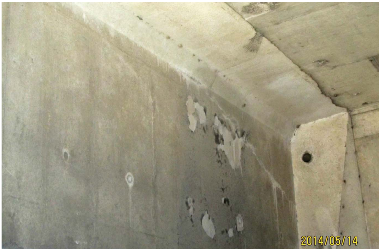
S5.PC.23W-24W.P1.c – 0489 (câbles #22 et 23 - extrémité ouest face amont)
