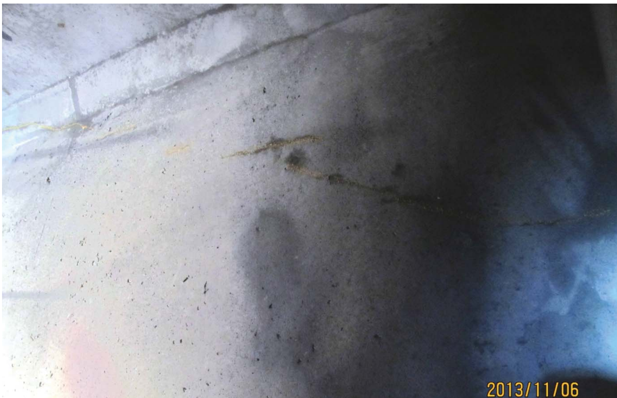
S5.PC.15W-16W.P7.b – 6148 (câble #23 – extrémité ouest face amont)
