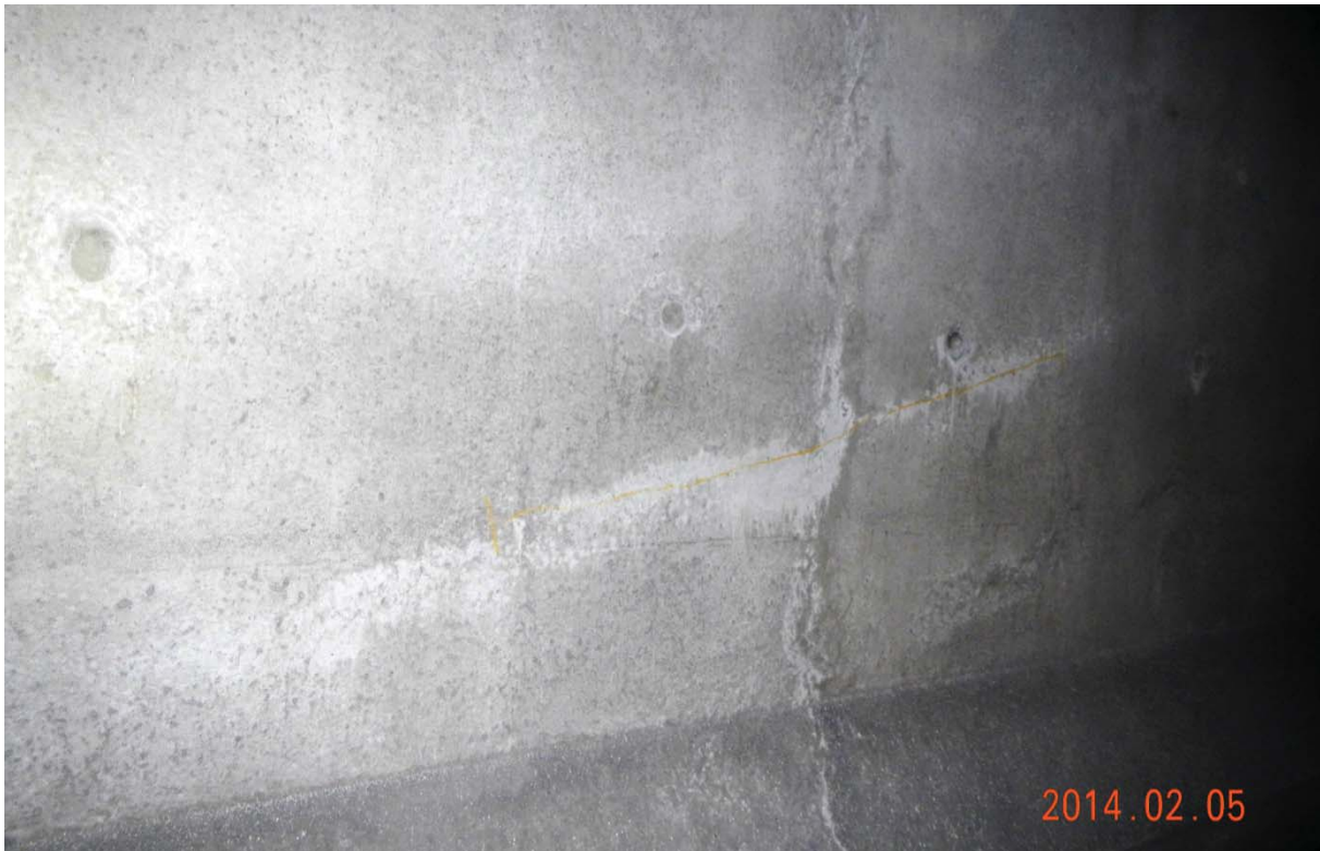
S5.PC.32W-33W.P4.d – 7511 (câble #20 – extrémité est face amont)
