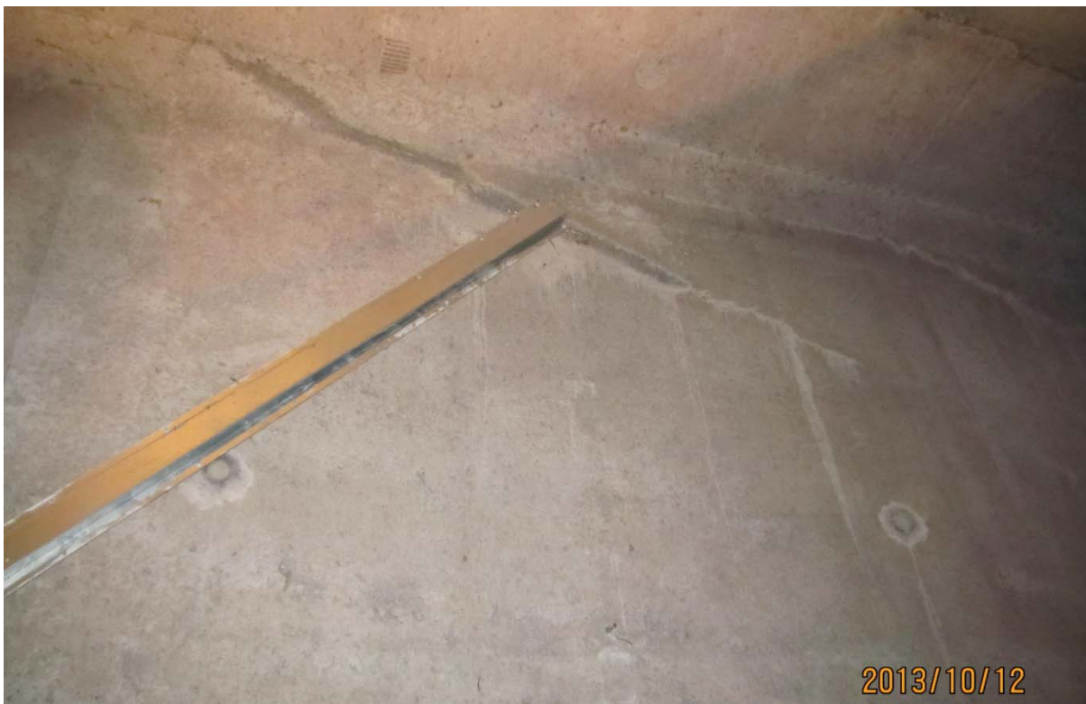
S5.PC.41W-42W.P1.g – 5765 (câble #19 - extrémité ouest face amont)
