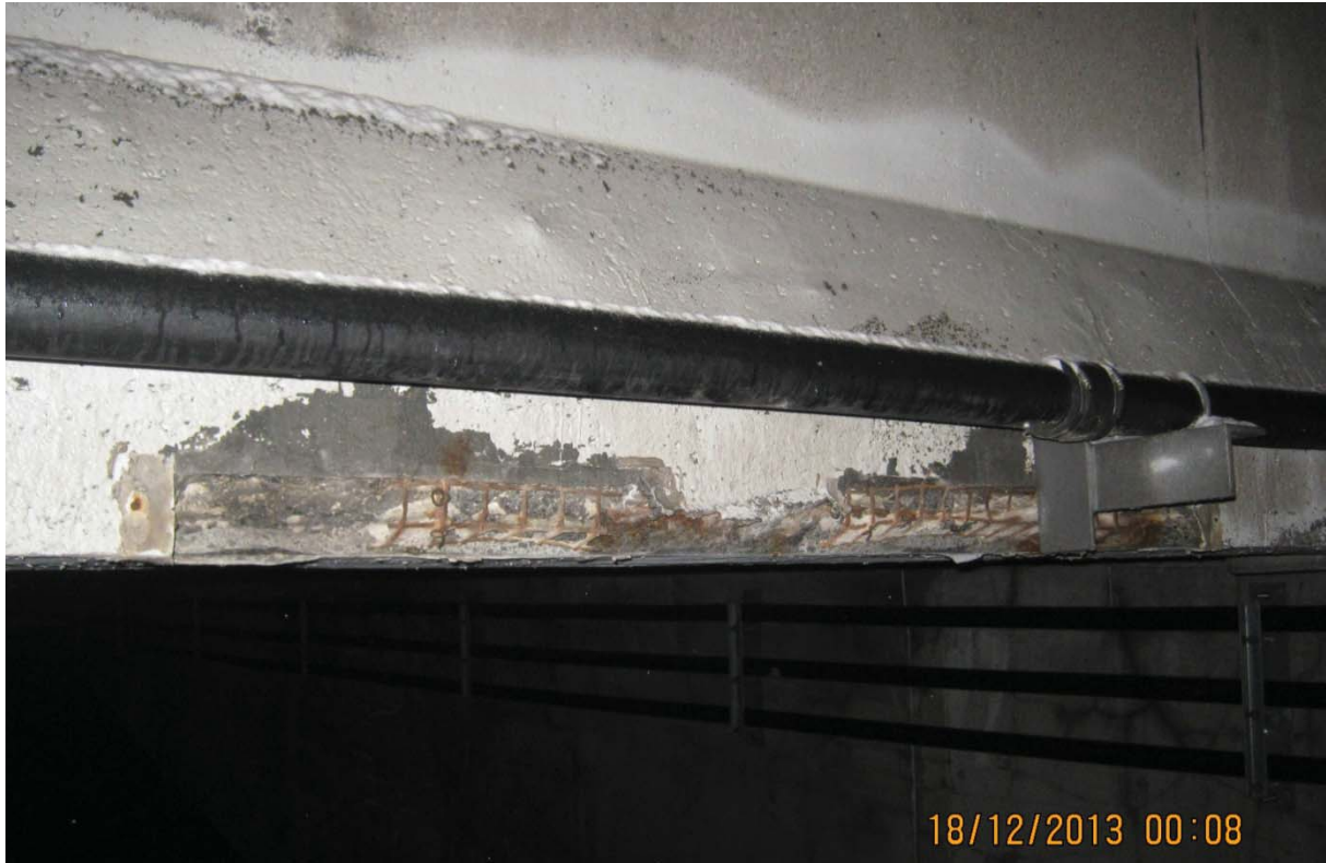
S5.PC.20W-21W.P1.a – 0240 (soffite - extrémité ouest)
