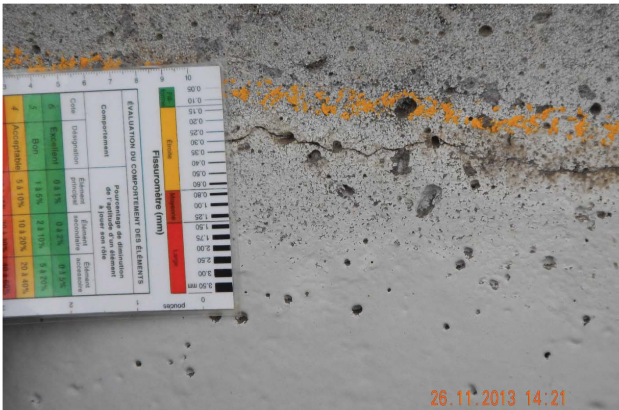
S5.PC.21W-20W.P7.b – 4361 (Fissure F4 détail - face amont)
