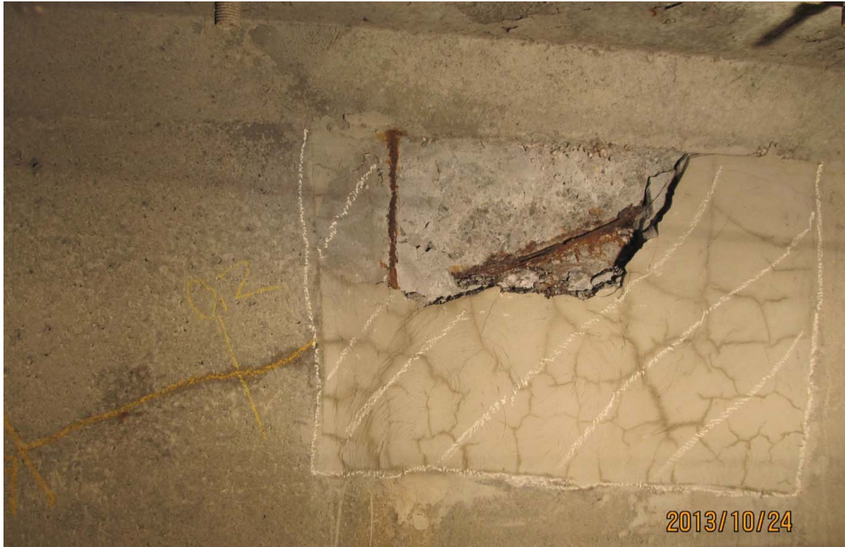
S5.PC.39W-38W.P7.c – 5905 (câble #20 – extrémité est face amont)
