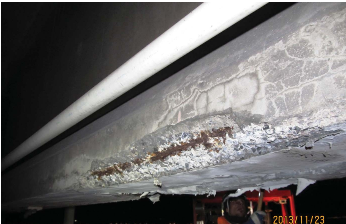
S5.PC.13W-14W.P7.k – 6402 (soffite – extrémité ouest face aval)
