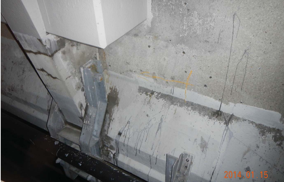
S5.PC. 12W-13W.P7.c – 7371 (câble #21 - extrémité est face amont)
