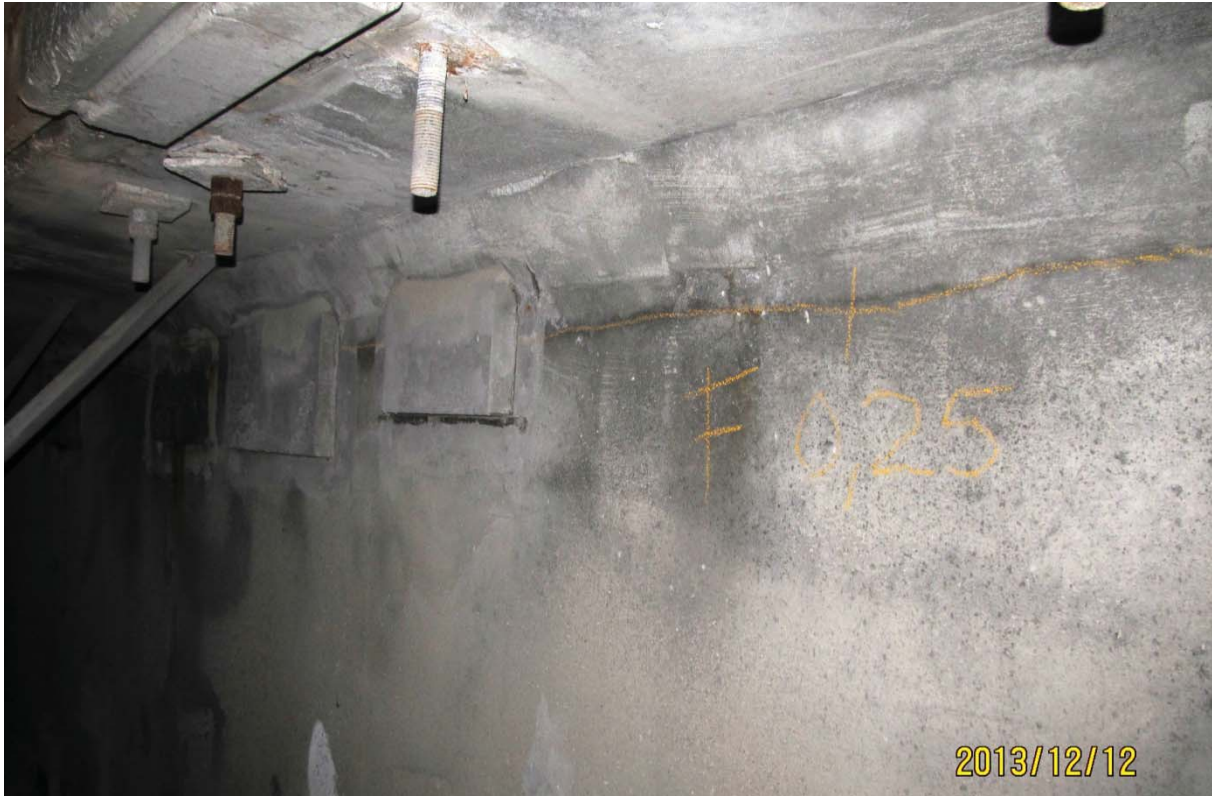
S5.PC.21W-22W.P7.e – 6772 (fissure horizontale âme – centre est face amont)
