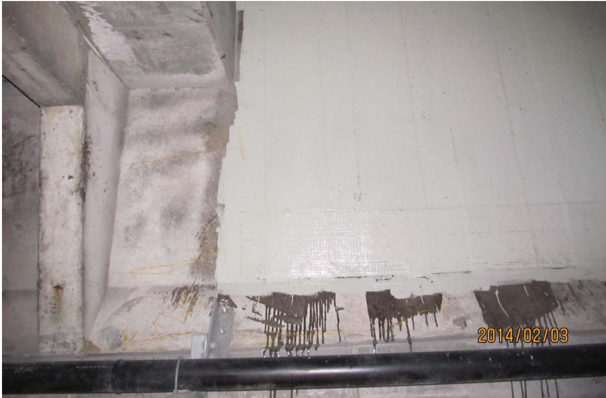
S7.PC.11E-12E.P7.e – 0225 (câbles #21 et #20 – extrémité ouest face aval)
