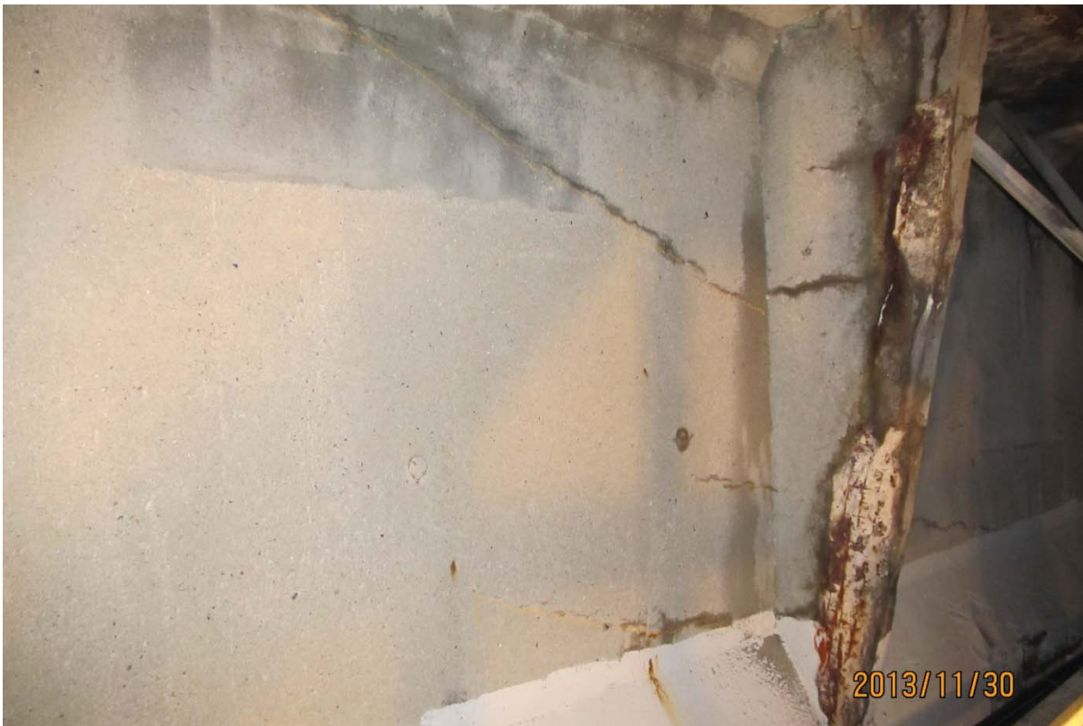
S5.PC.9W-10W.P7.b – 6498 (câbles #21 et #23 – extrémité ouest face amont)
