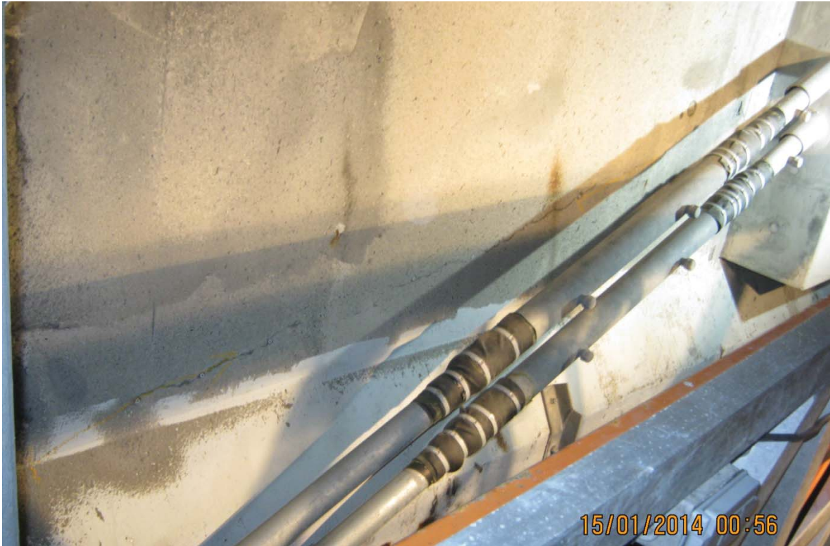
S5.PC.23W-24W.P7.e – 0284 (câble #12 – extrémité est face amont)
