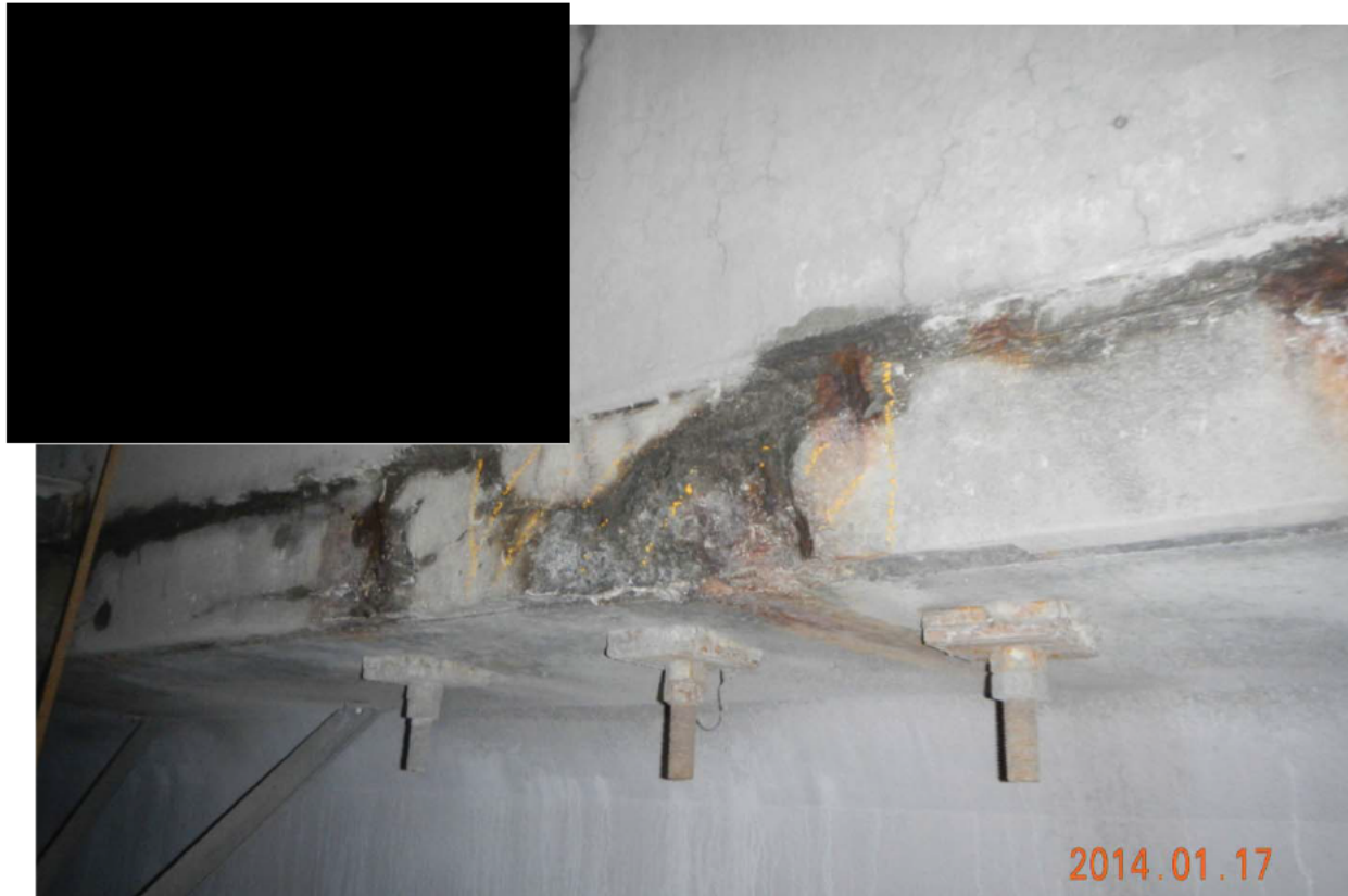
S5.PC.26W-27W.P1.b – 7426 (semelle supérieure - extrémité est face aval)
