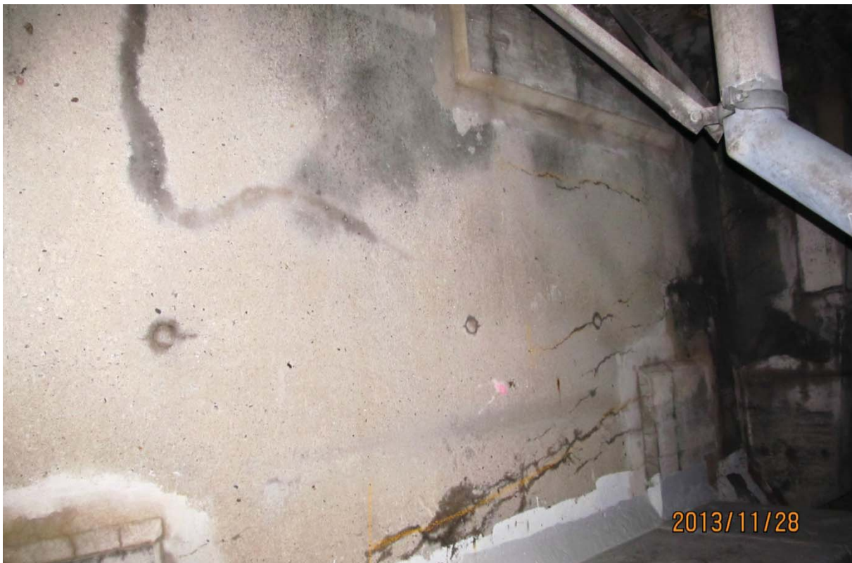
S5.PC.11W-12W.P7.f – 6496 (âme – extrémité est face amont)
