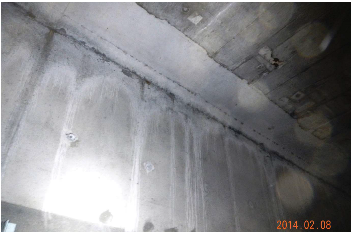
S5.PC.5W-6W.P7.f – 7561 (fissure horizontale au gousset supérieur – centre face aval)
