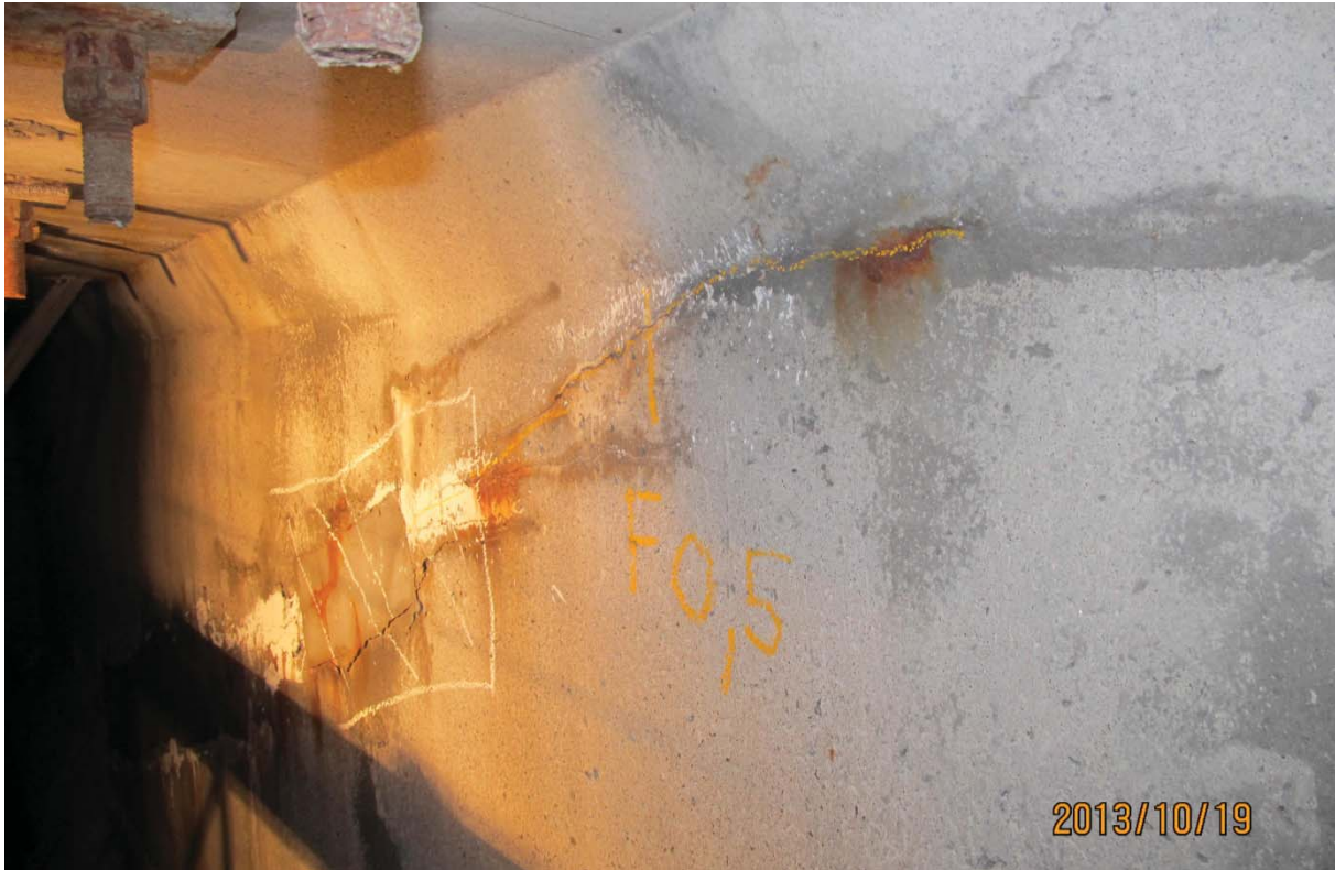
S5.PC.35W-36W.P7.c – 5845 (câble #20 - extrémité est face amont)
