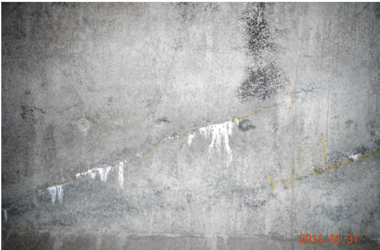
S5.PC.43W-44W.P4.b – 7483 (câbles #23 et #24 – centre est face amont)
