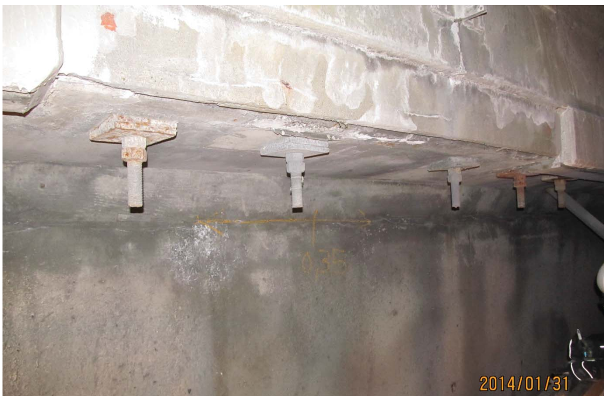
S5.PC.6W-7W.P7.b – 0199 (fissure horizontale au gousset supérieur - centre ouest face amont)
