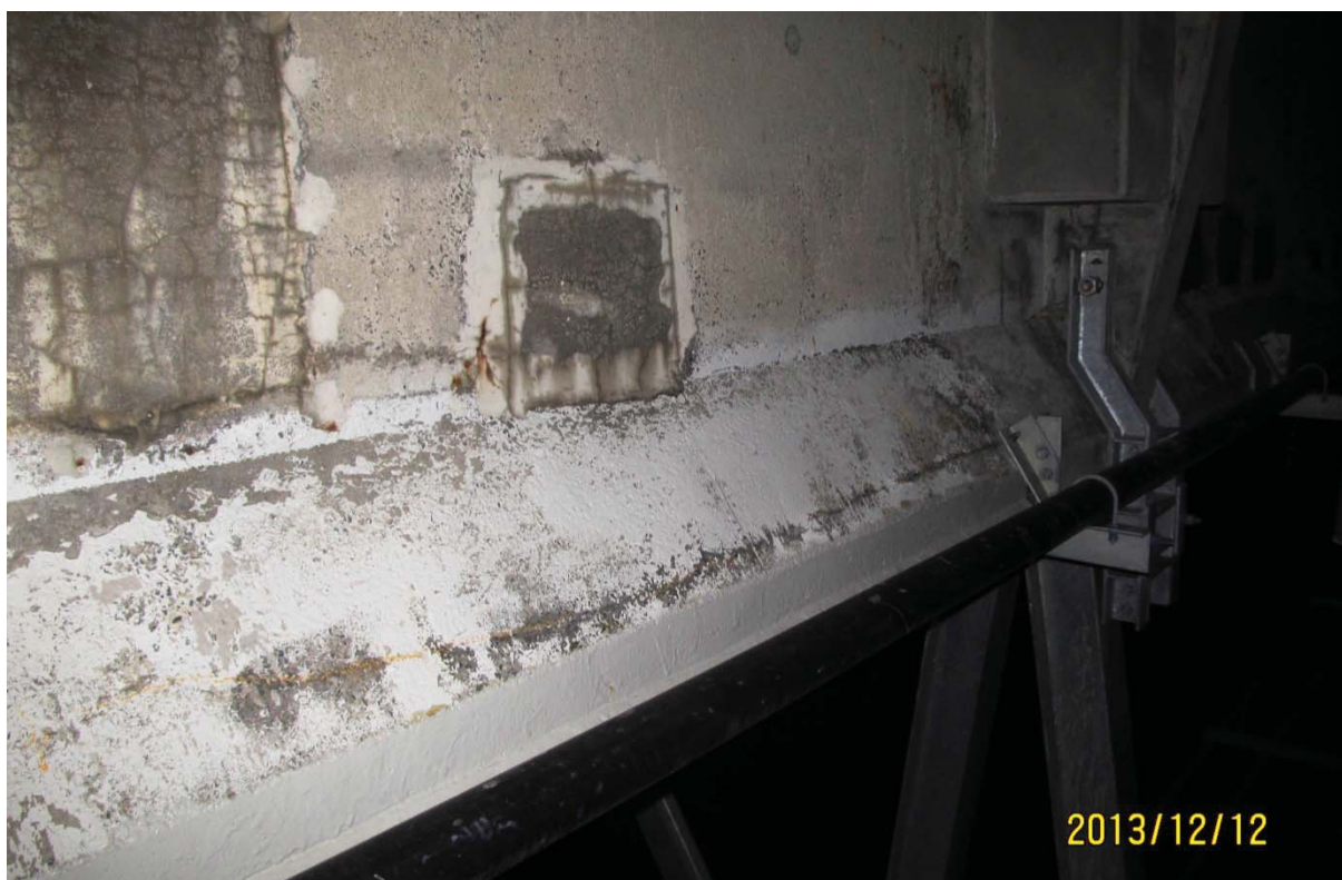
S5.PC.21W-22W.P7.d – 6765 (fissure horizontale semelle inférieure – extrémité ouest et centre ouest face amont)
