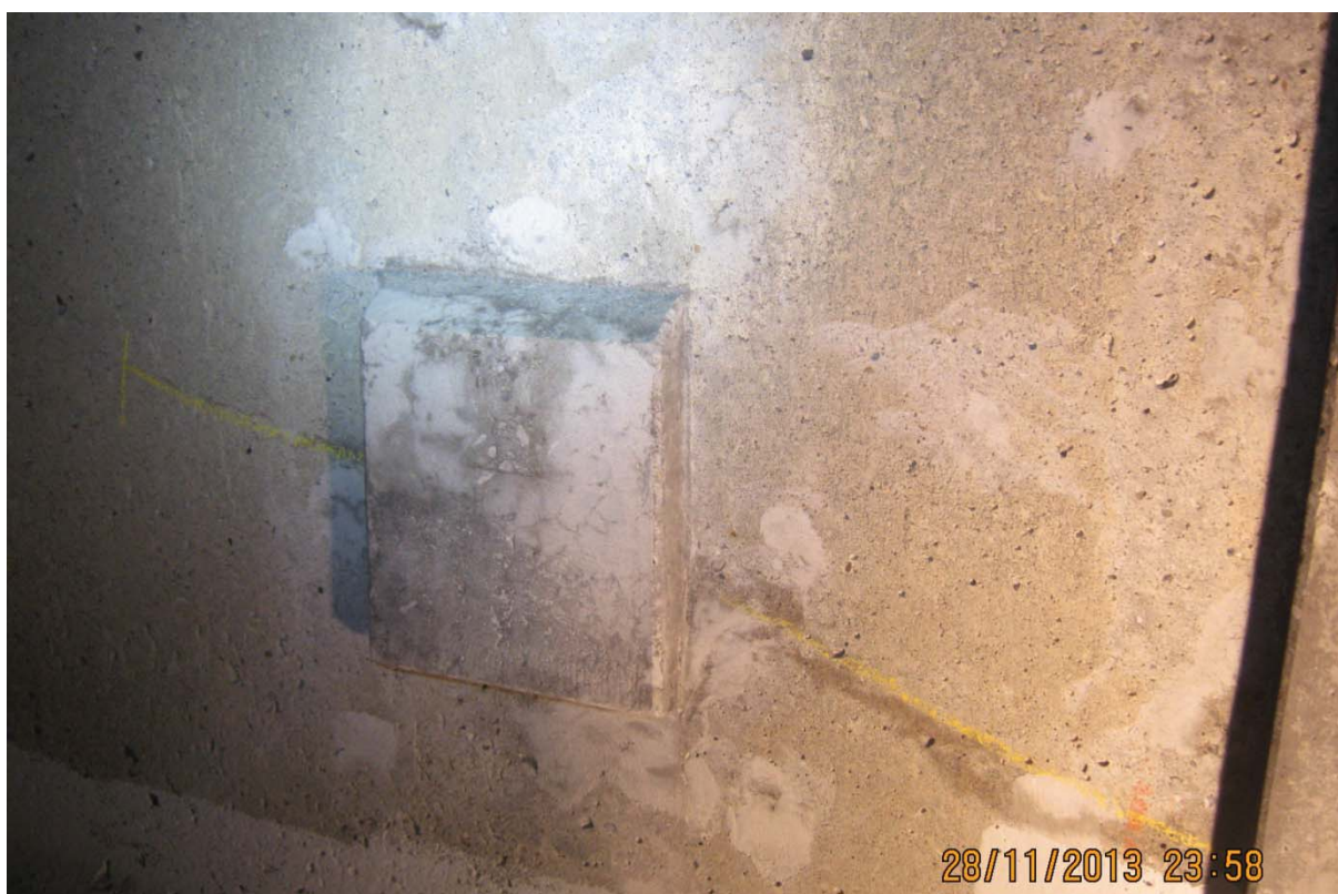
S5.PC.10W-11W.P7.b – 0102 (câble #21 – extrémité ouest face amont)
