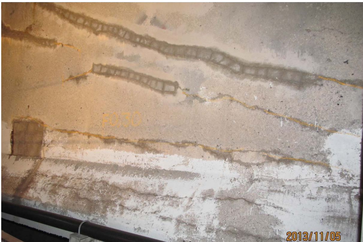
S5.PC.16W-17W.P7.b – 6101 (câbles #16 et #15 – extrémité ouest face amont)
