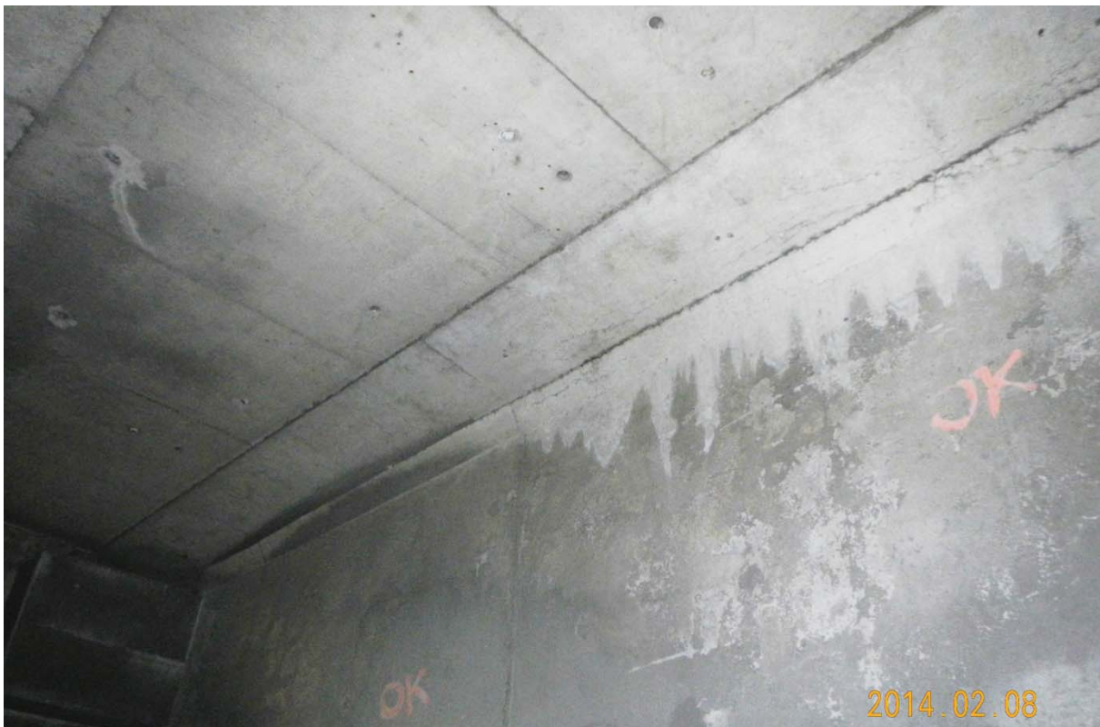
S7.PC.13E-14E.P7.k – 7580 (fissure horizontale au gousset supérieur – extrémité ouest face aval)
