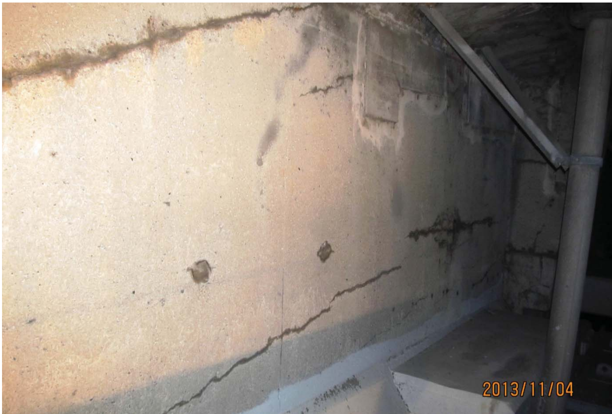
S5.PC.18W-19W.P1.f – 6090 (câbles #16, #15 et #10 - extrémité ouest face aval)
