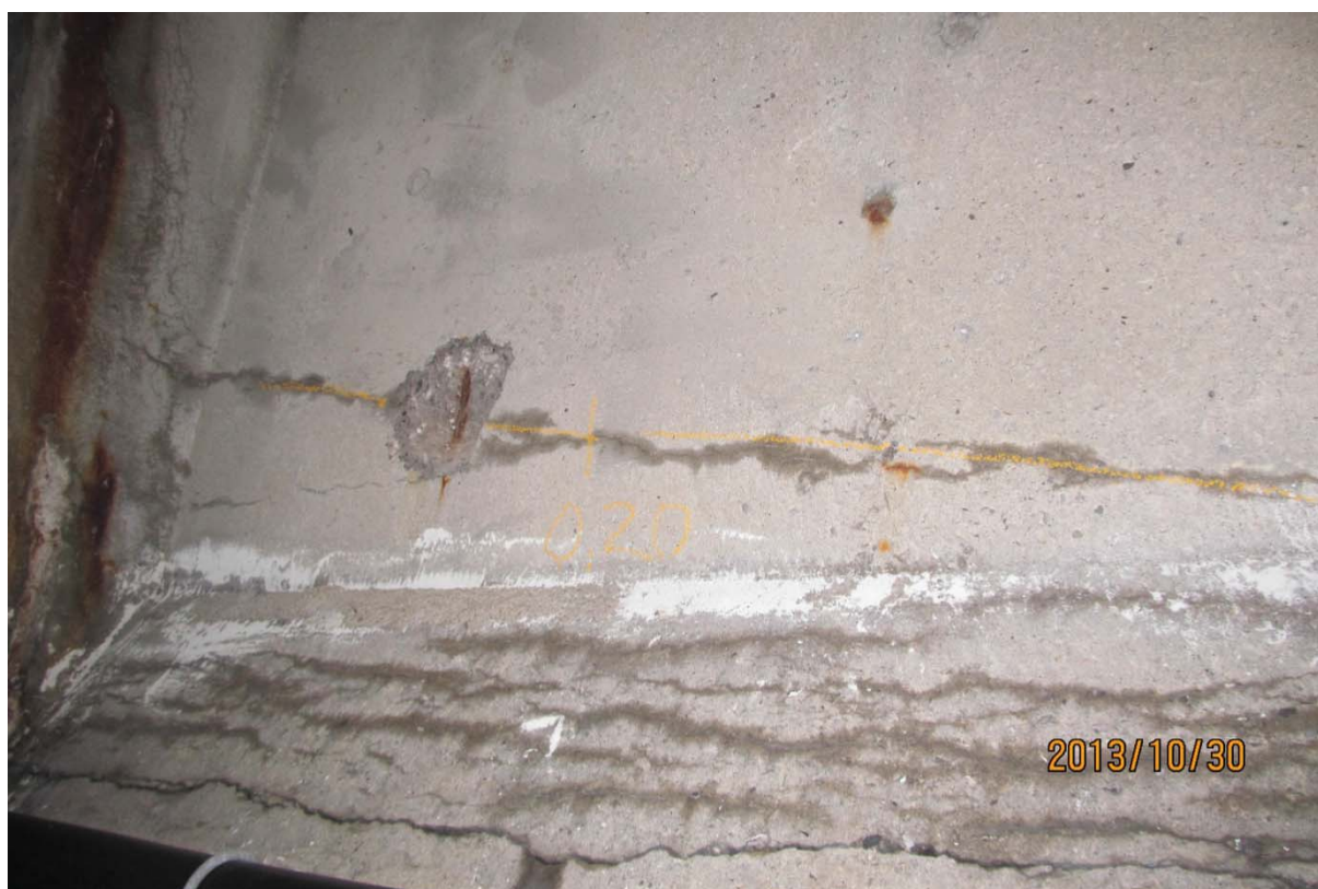
S5.PC.18W-19W.P7.d – 5991 (câble #22 – centre ouest face amont)
