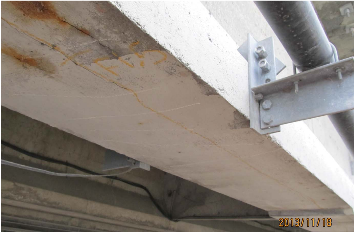
S5.PC.43W-44W.P1.a – 6324 (soffite - extrémité ouest)
