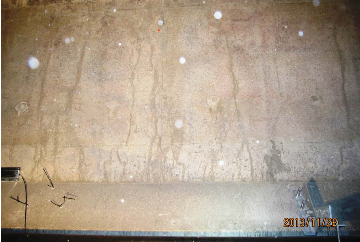
S5.PC.39W-40W.P7.c – 6466 (âme, défaut superficiel - centre ouest face aval)
