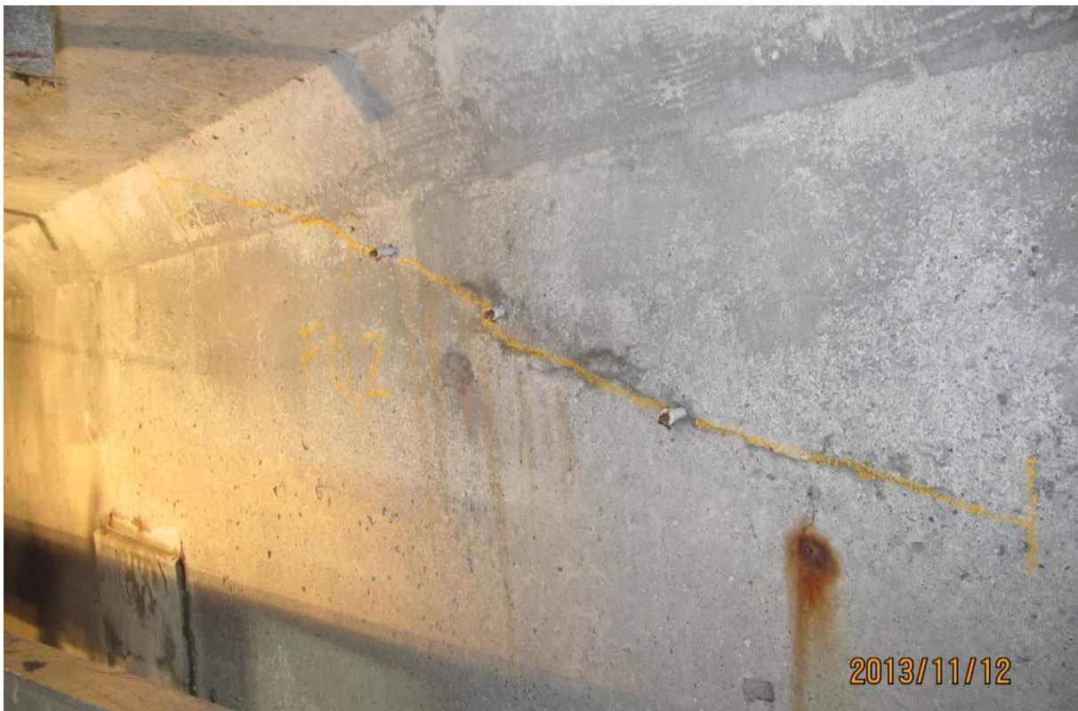
S5.PC.24W-25W.P7.b – 6268 (câble #18 – extrémité ouest face amont)
