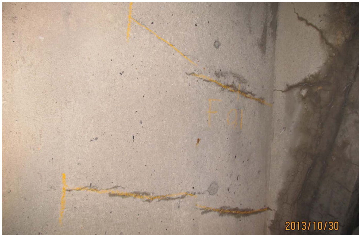
S5.PC.18W-19W.P7.c – 5981 (câbles #22 et #23 – extrémité ouest face amont)
