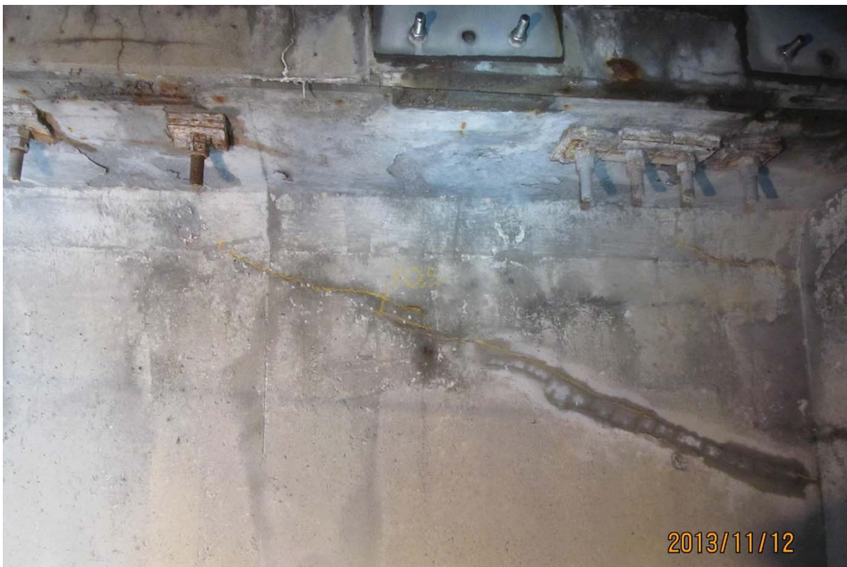
S5.PC.28W-29W.P7.b – 6230 (câbles #23 et #24 – extrémité ouest face amont)
