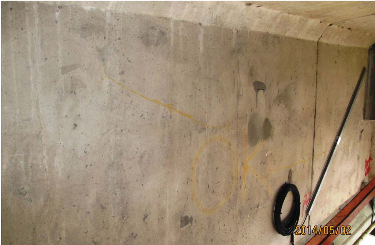
S7.PC.13E-14E.P7.g – 0471 (câble #16 – extrémité est face aval)
