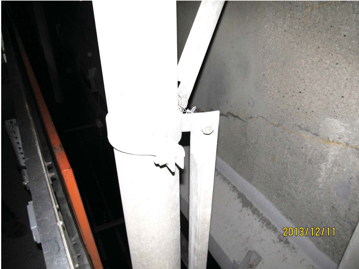
S5.PC.32W-33W.P1.g – 6729 (attache de drain dévissée – centre ouest face aval près du diaphragme 2)
