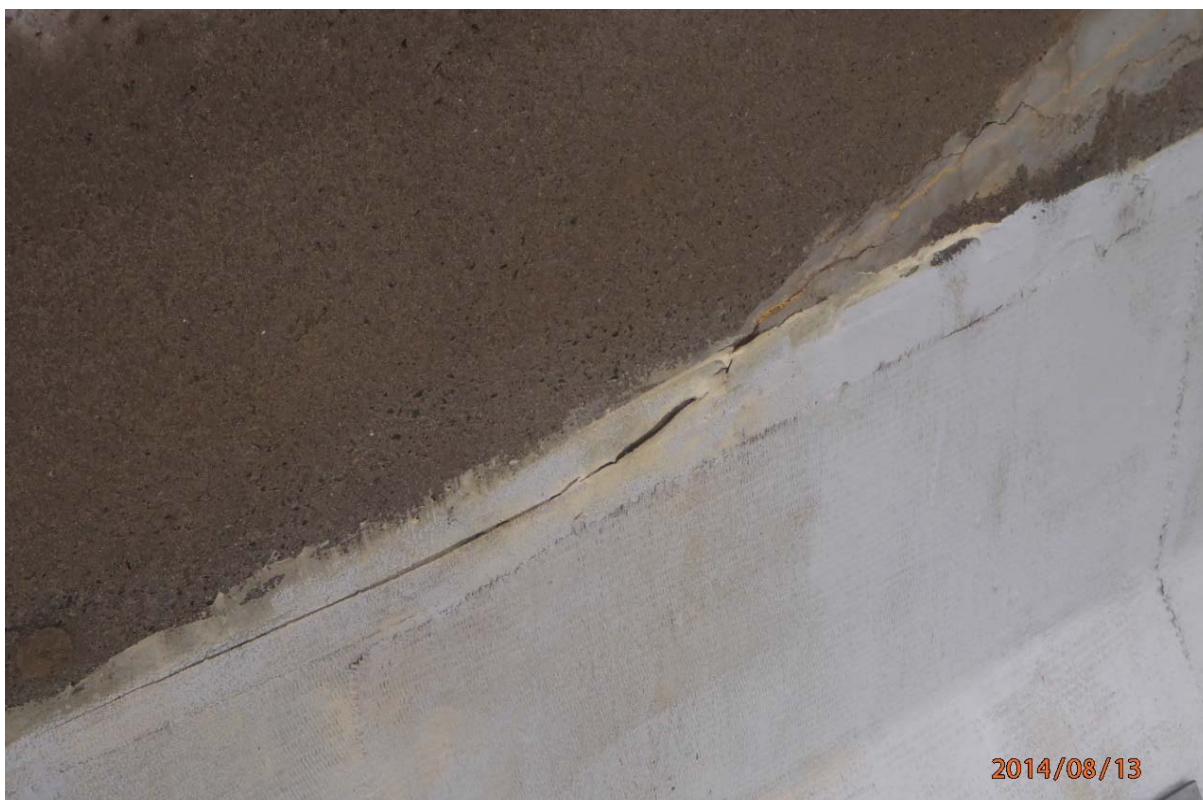
S5.PC.31W-32W.P7.h – PH.20140813_P7_31W-32W_062 (Décollement - extrémité centre face amont)
