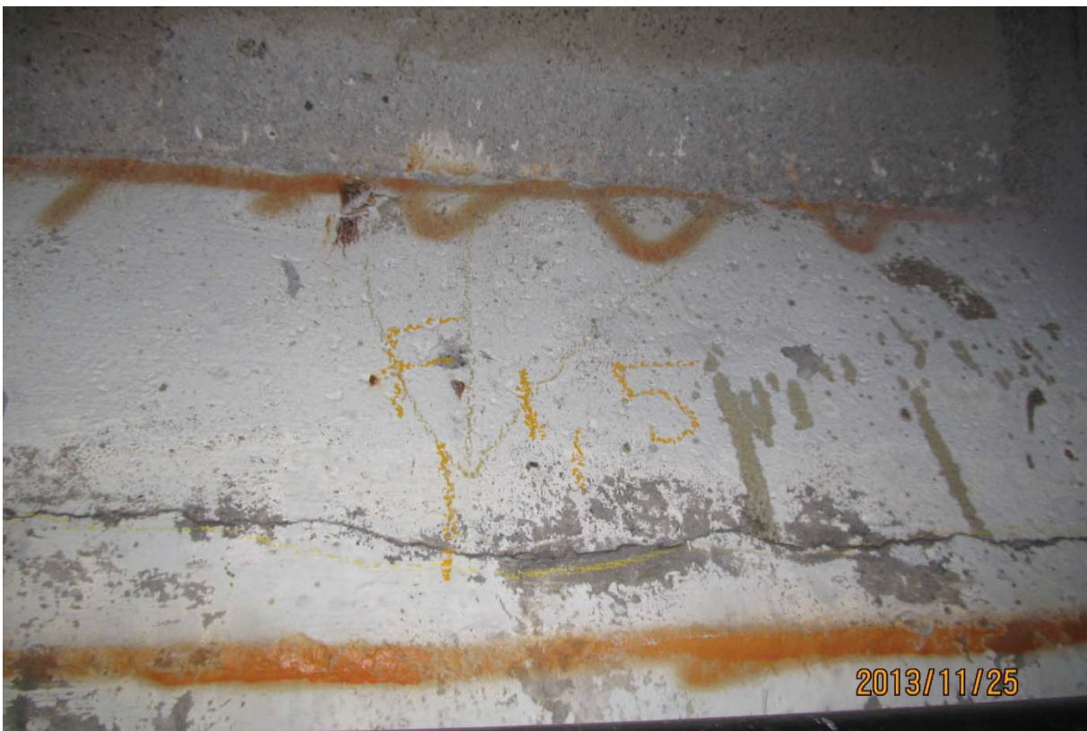
S5.PC.27W-28W.P7.d – 6421 (fissure horizontale semelle inférieure – centre face amont)
