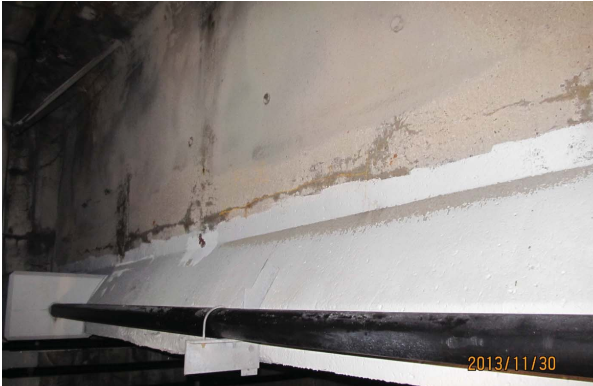
S5.PC.8W-9W.P7.a – 6520 (fissure horizontale – extrémité ouest face amont)
