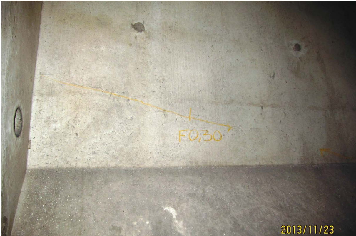
S5.PC.13W-14W.P7.g – 6411 (câbles #22 – centre est face aval)
