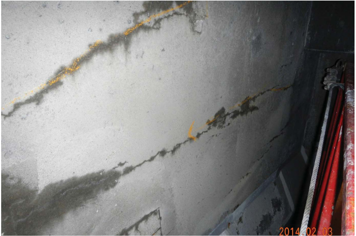
S7.PC.12E-13E.P7.g – 0802 (câbles #19 et #17 – extrémité est face amont)
