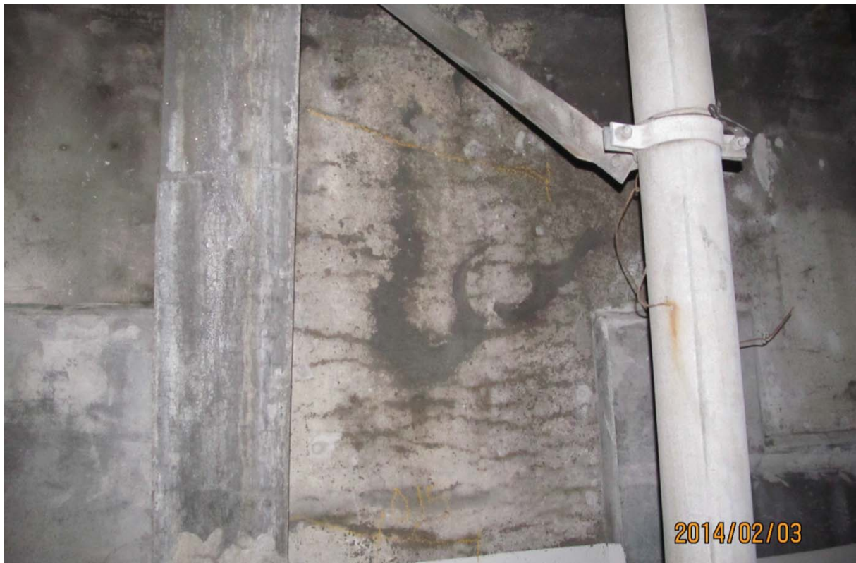
S7.PC.6E-7E.P7.b – 0220 (câbles #22 et #24 - extrémité ouest et centre ouest face amont)
