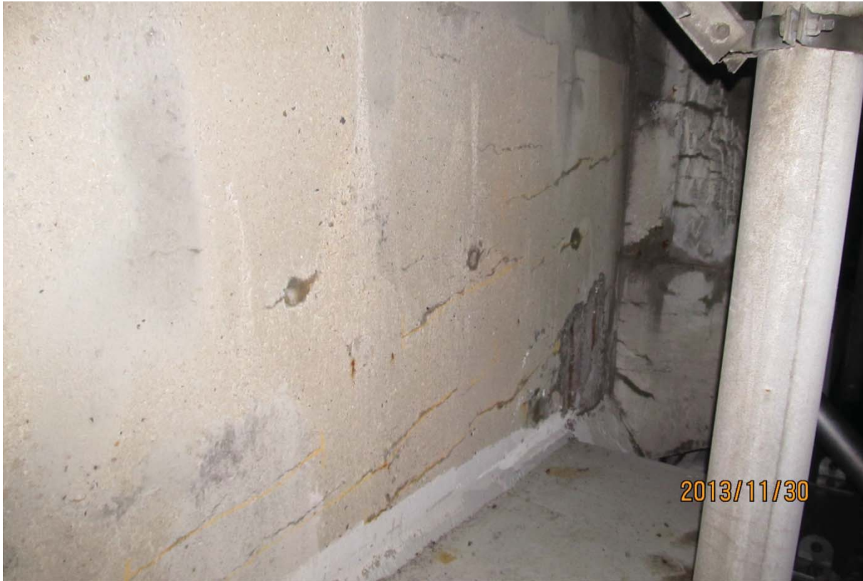
S5.PC.9W-10W.P7.e – 6514 (âme – extrémité est face amont)
