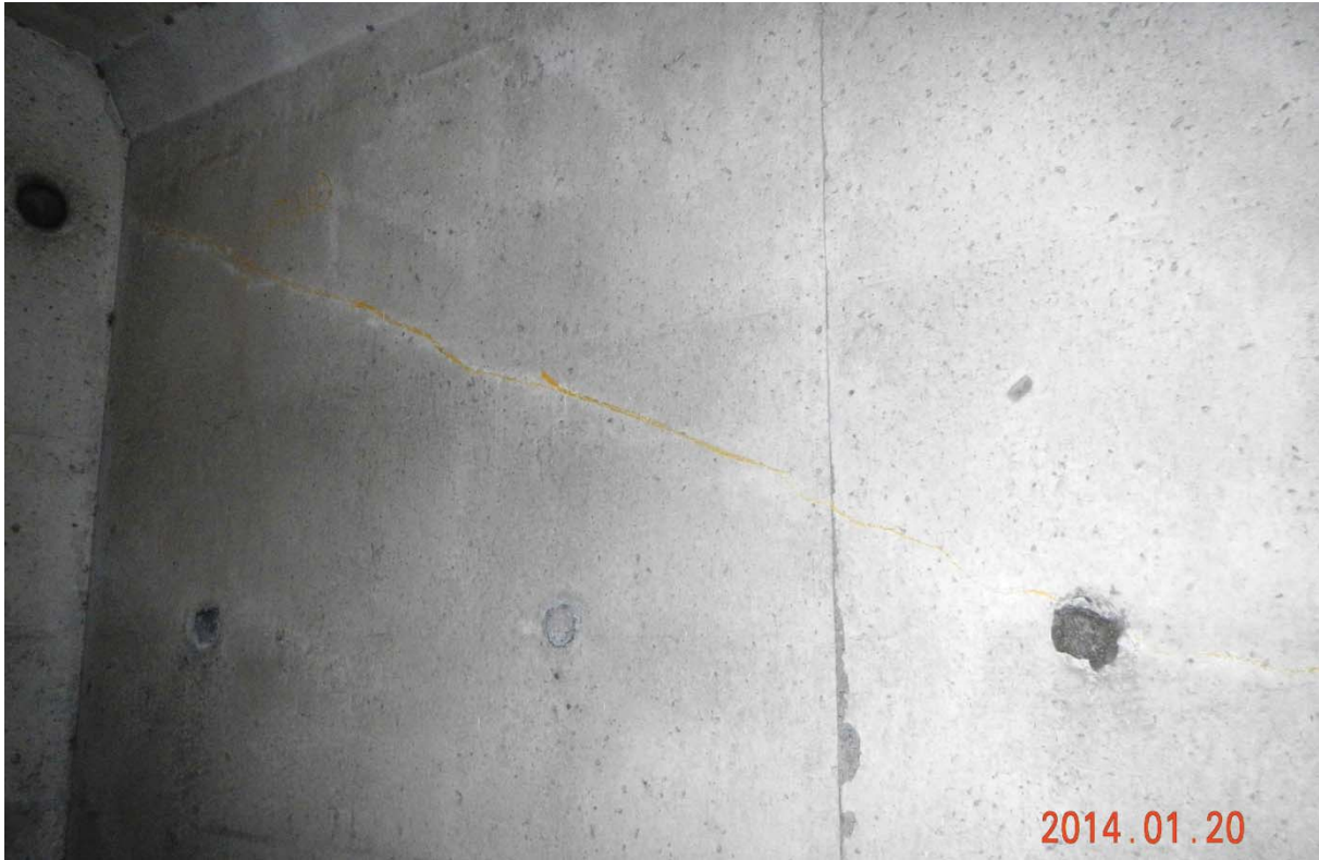
S5.PC.28W-29W.P4.e – 7448 (câble #24 – centre est face aval)
