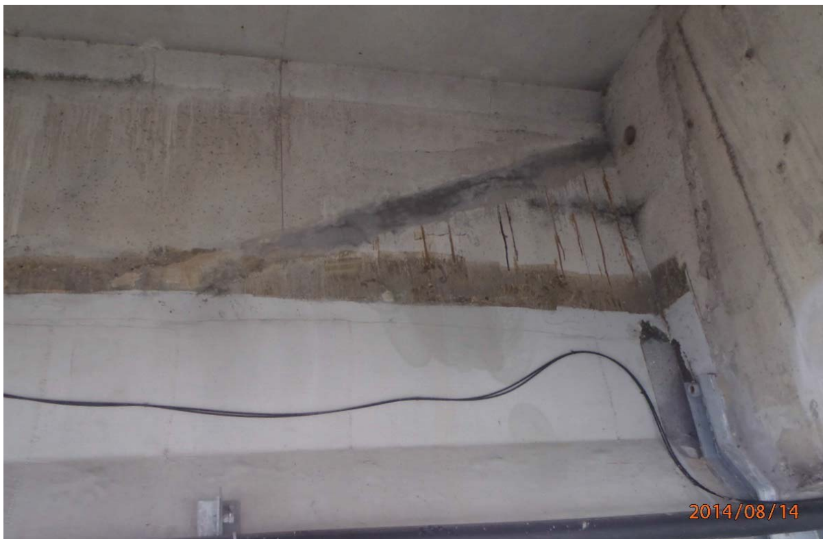
S5.PC.31W-32W.P7.k – PH.20140814_P7_31W-32W_017 (câble #24 - extrémité centre face aval)
