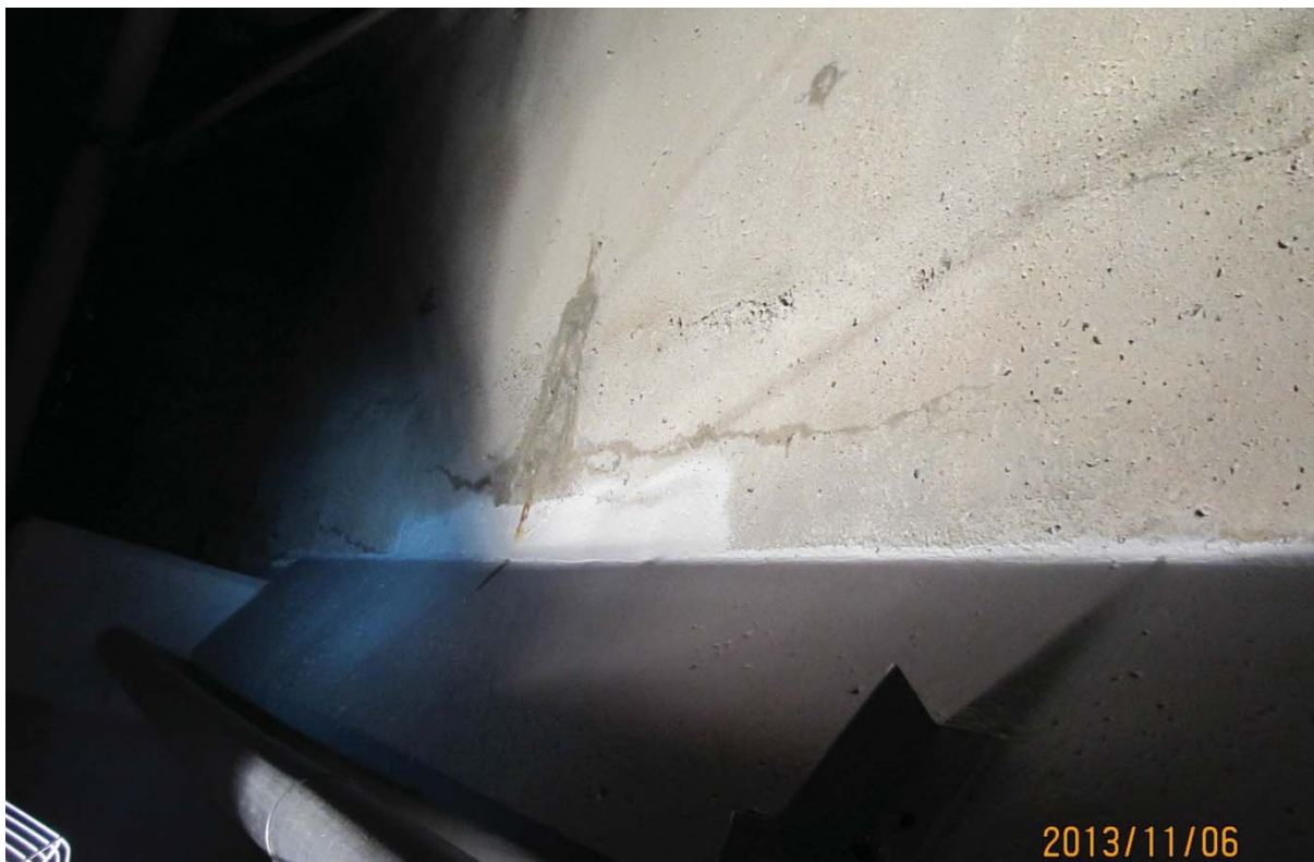
S5.PC.17W-18W.P7.c – 6130 (âme – extrémité ouest face amont)
