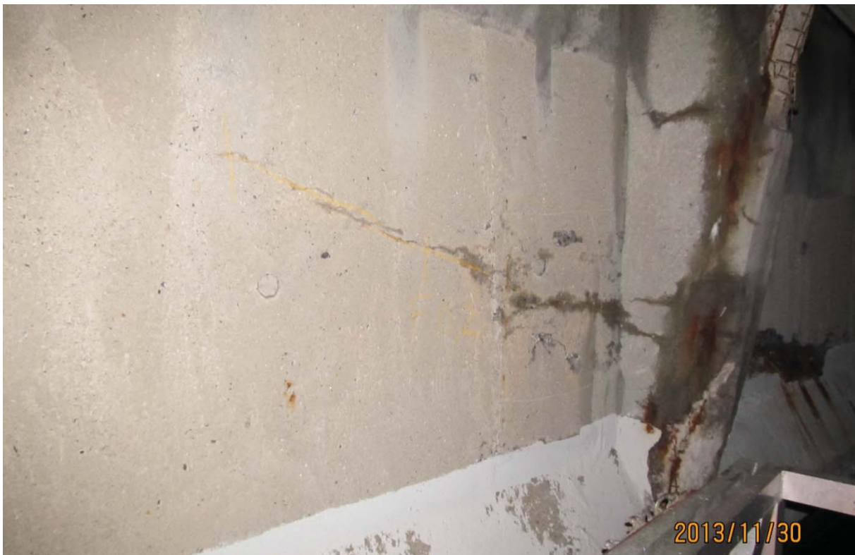
S5.PC.8W-9W.P7.b – 6515 (câble #22 – extrémité ouest face amont)
