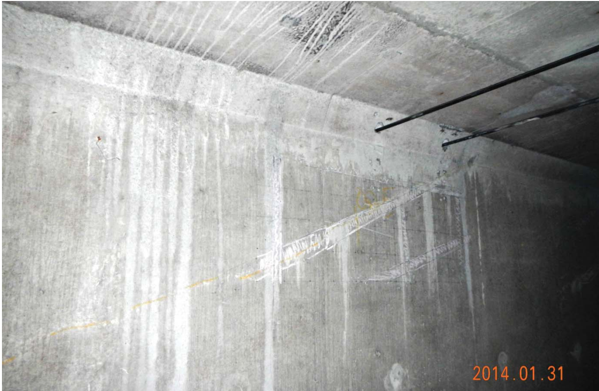
S5.PC.43W-44W.P4.c – 7473 (câble #18 – extrémité est face amont)
