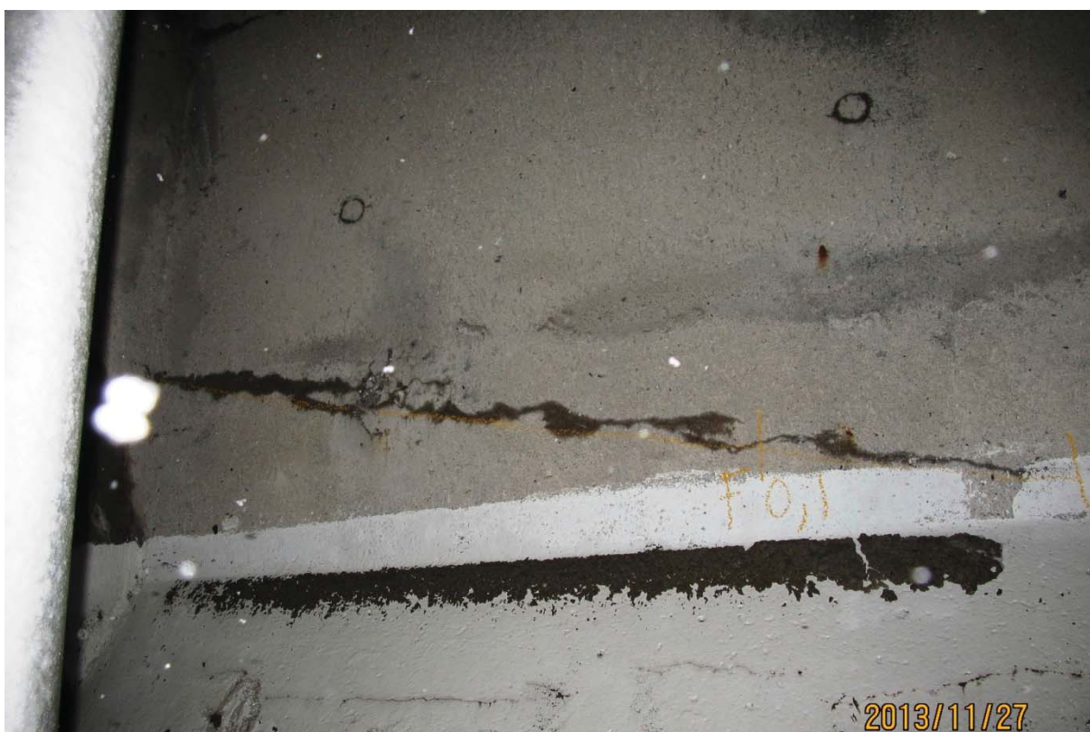
S5.PC.19W-20W.P7.d – 6436 (câble #22 – centre ouest face amont)
