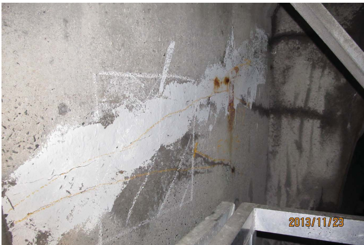
S5.PC.29W-30W.P7.h – 6395 (câble #24 – centre est face amont)
