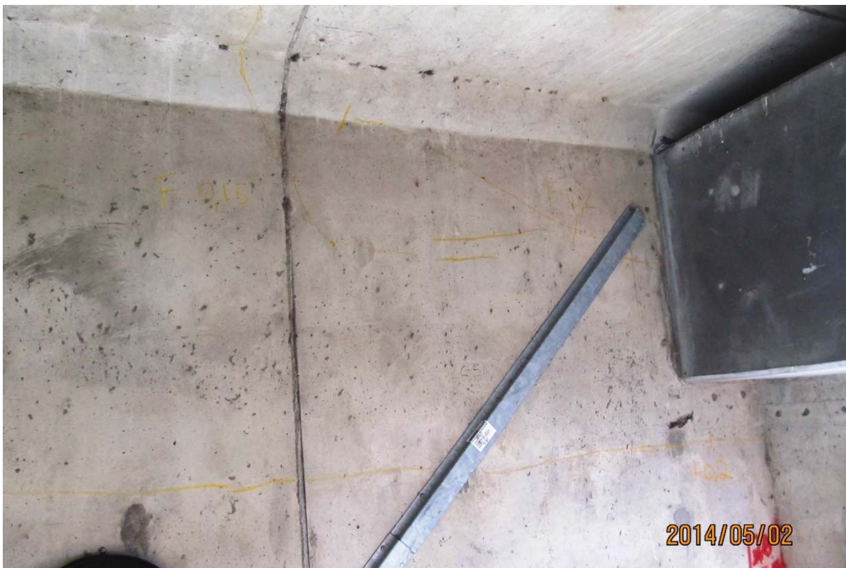
S7.PC.13E-14E.P7.h – 0474 (âme – extrémité est face aval)
