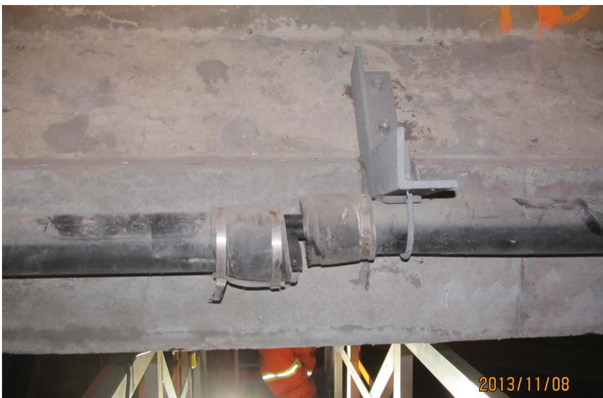
S7.PC.10E-11E.P7.b – 6188 (jonction de gaine – extrémité ouest face aval)
