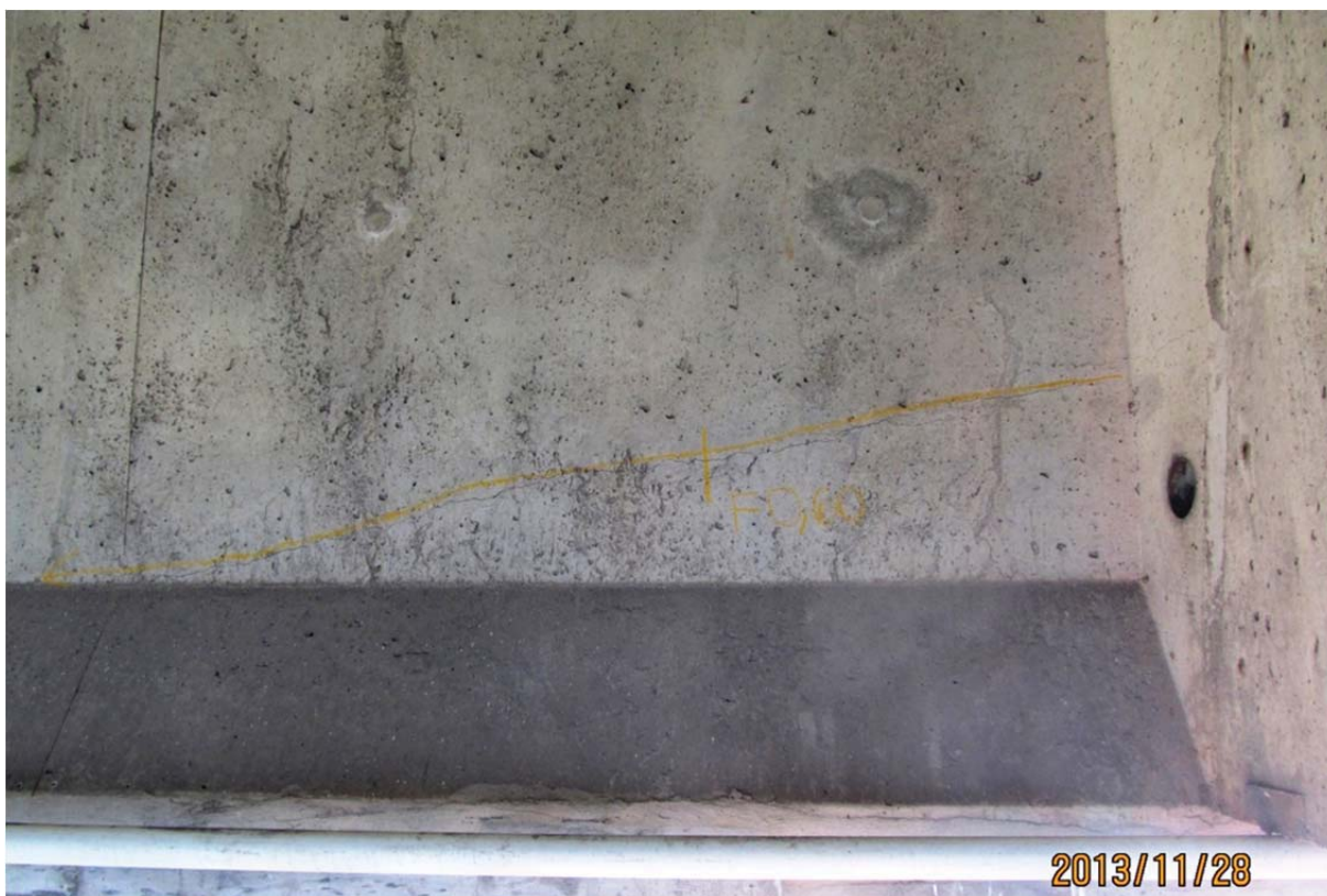
S5.PC.14W-15W.P7.k – 6473 (câble #22 – centre ouest face aval)
