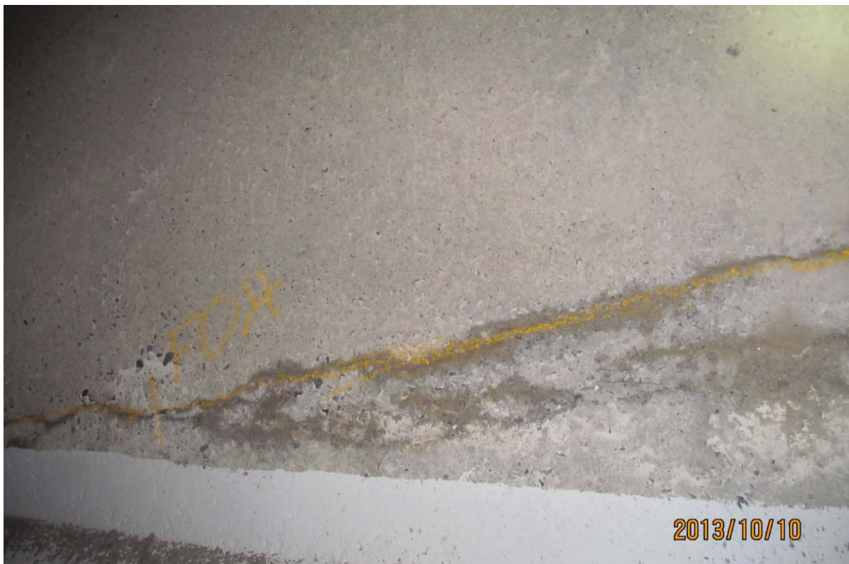
S5.PC.40W-41W.P7.e – 5702 (câble #22 - extrémité est face amont)
