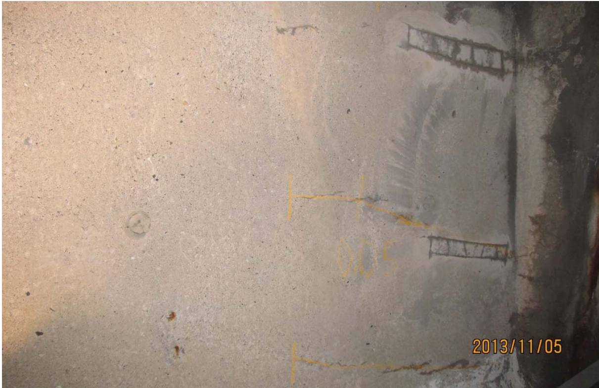
S5.PC.16W-17W.P7.e – 6098 (câbles #22 et #21 – extrémité ouest face amont)
