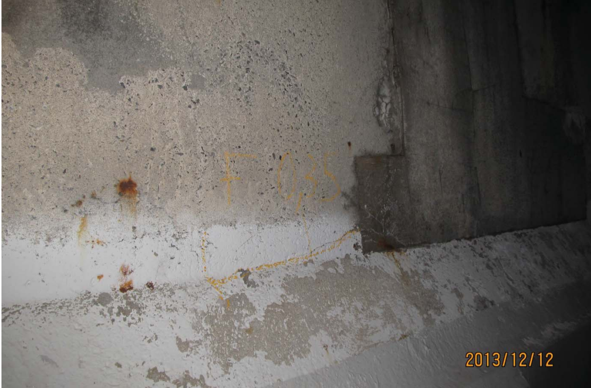
S5.PC.21W-22W.P7.g – 6775 (câble #15 – extrémité est face amont)
