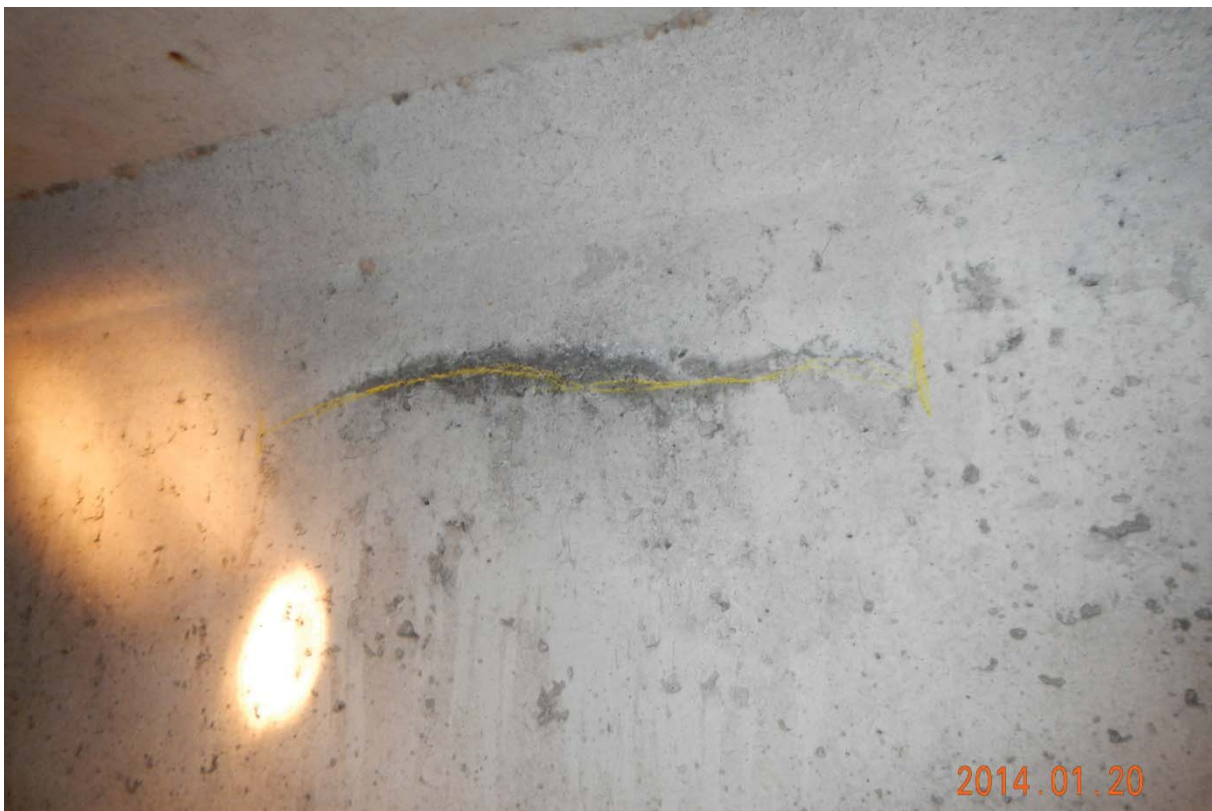
S5.PC.28W-29W.P4.b – 7446 (âme – centre est face amont)
