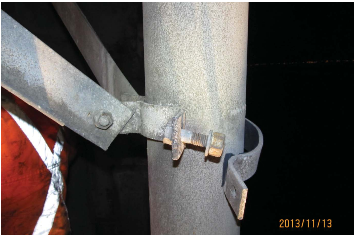
S5.PC.24W-25W.P7.d – 6275 (Attache de drain – extrémité est face amont)
