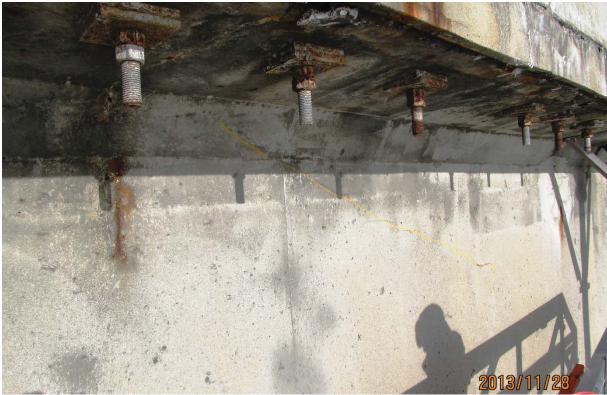
S5.PC.14W-15W.P7.b – 6469 (câble #20 – extrémité ouest face amont)
