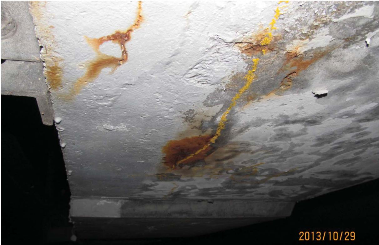
S5.PC.25W-26W.P7.e – 5962 (soffite – extrémité ouest)
