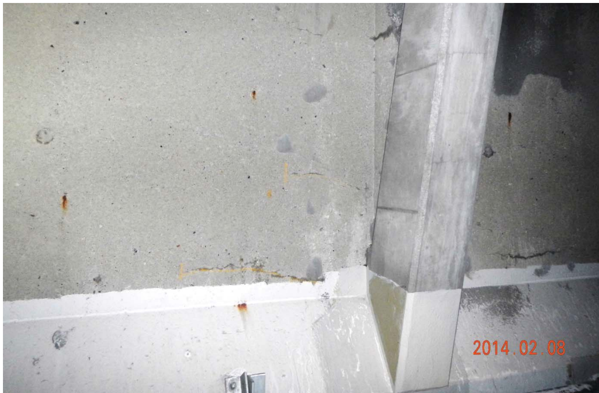
S5.PC.5W-6W.P7.b – 7554 (câbles #21 et #22 – extrémité ouest face amont)
