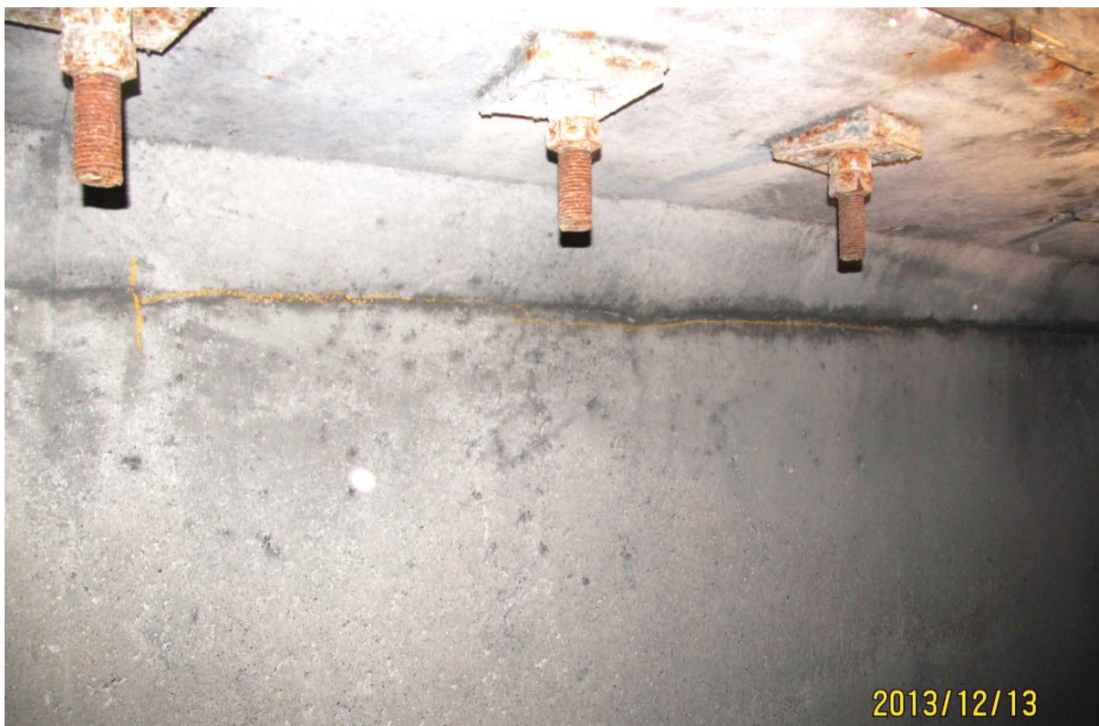
S5.PC.31W-32W.P7.d – 6792 (fissure horizontale au gousset supérieur - centre face amont)
