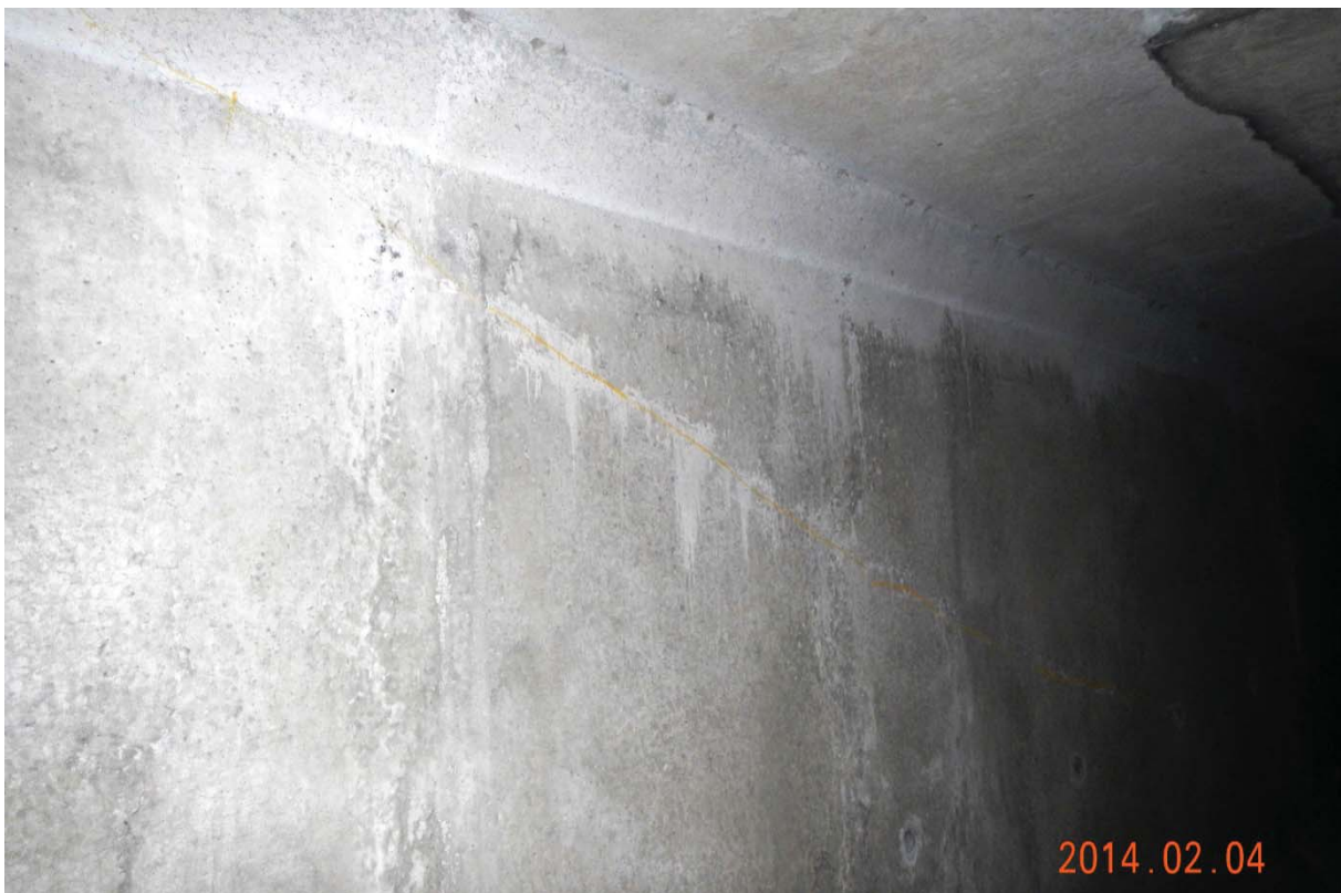
S5.PC.31W-32W.P4.b – 7506 (câble #19 – extrémité ouest face amont)
