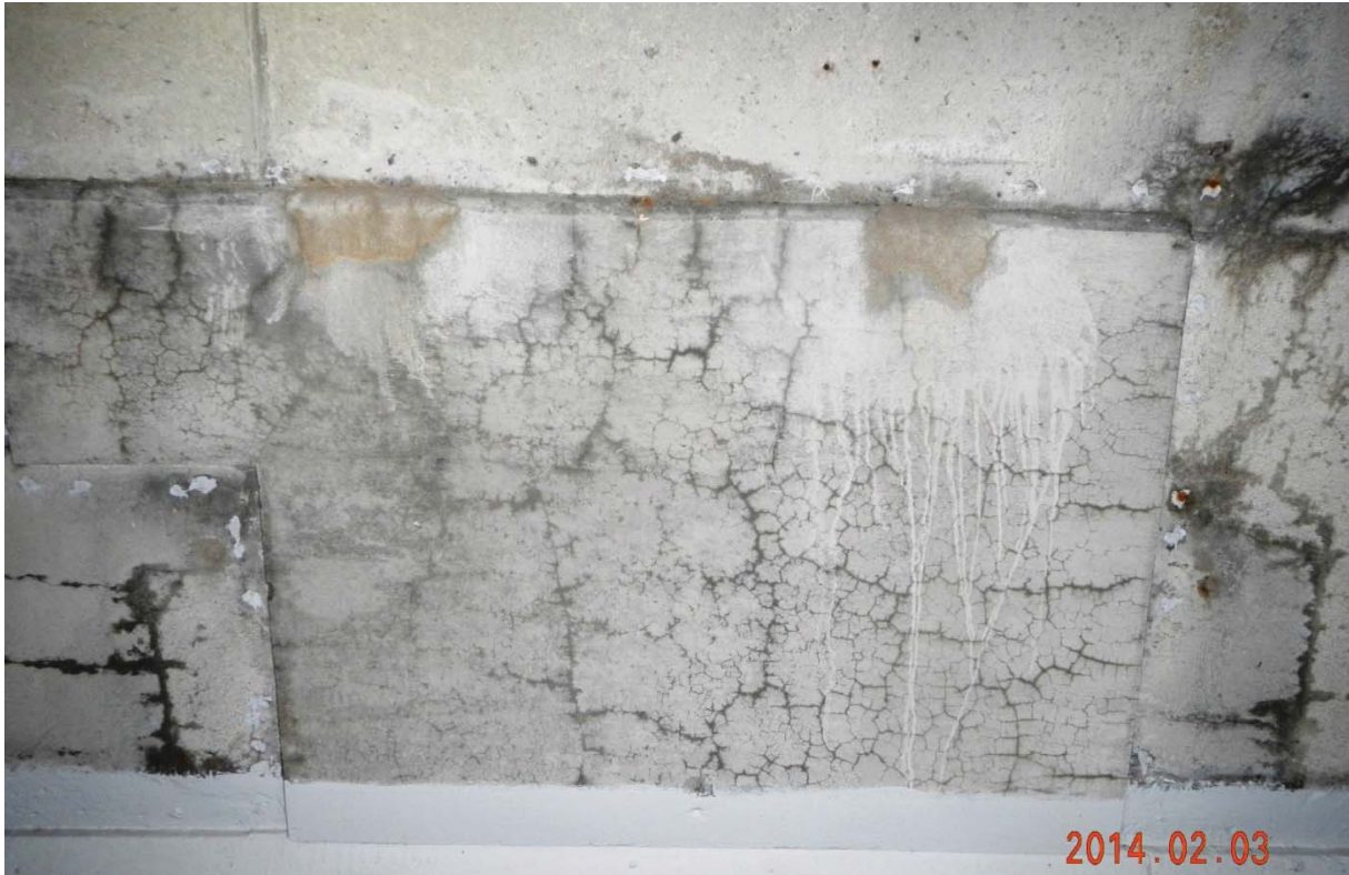
S7.PC.12E-13E.P7.c – 0792 (fissures polygonales filiforme – extrémité ouest face amont)
