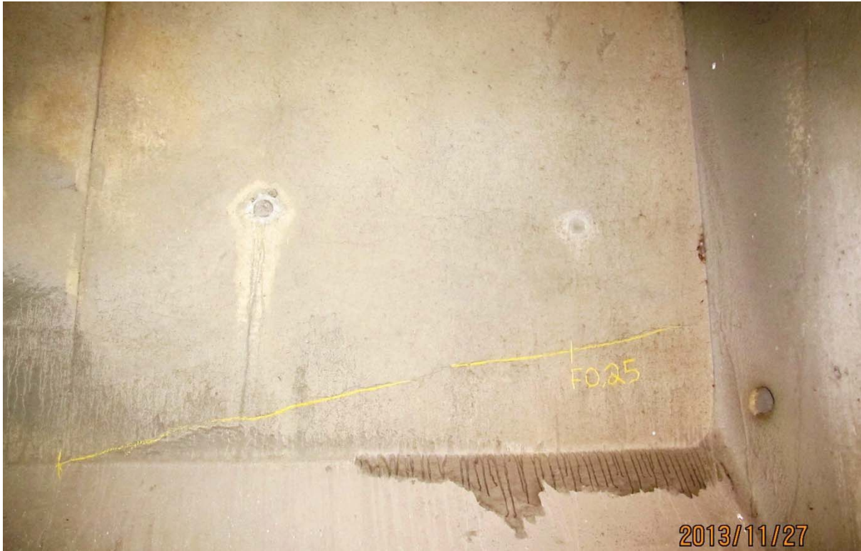
S5.PC.19W-20W.P7.l – 6432 (câble #22 – centre ouest face aval)
