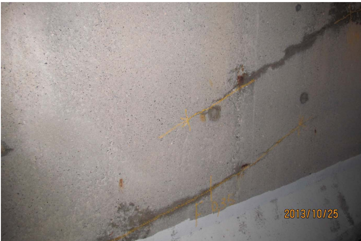
S5.PC.36W-37W.P7.b – 5925 (câbles #24 et #23 - centre est face amont)
