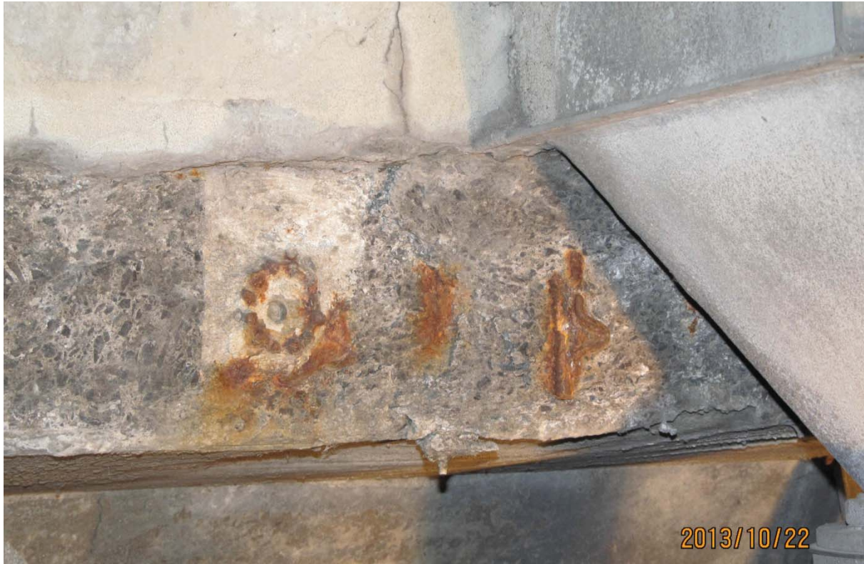
S7.PC.4E-5E.P1.g – 5892 (semelle supérieure – ancrage de la post-tension de la dalle face aval)
