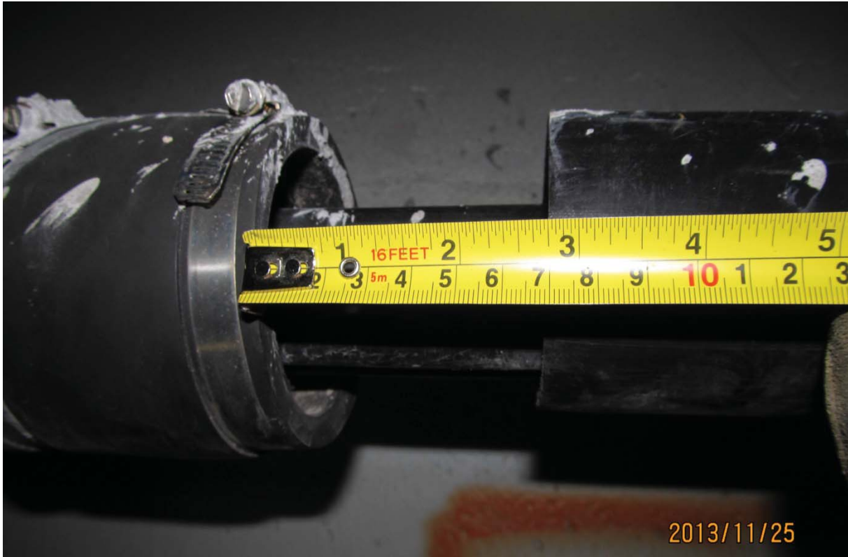
S5.PC.27W-28W.P7.a – 6415 (Post-tension extérieure gaine détachée – extrémité ouest face amont)
