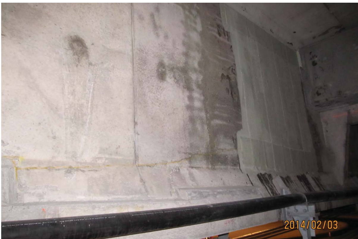
S7.PC.11E-12E.P7.d – 0226 (câble #22 – centre ouest face aval)
