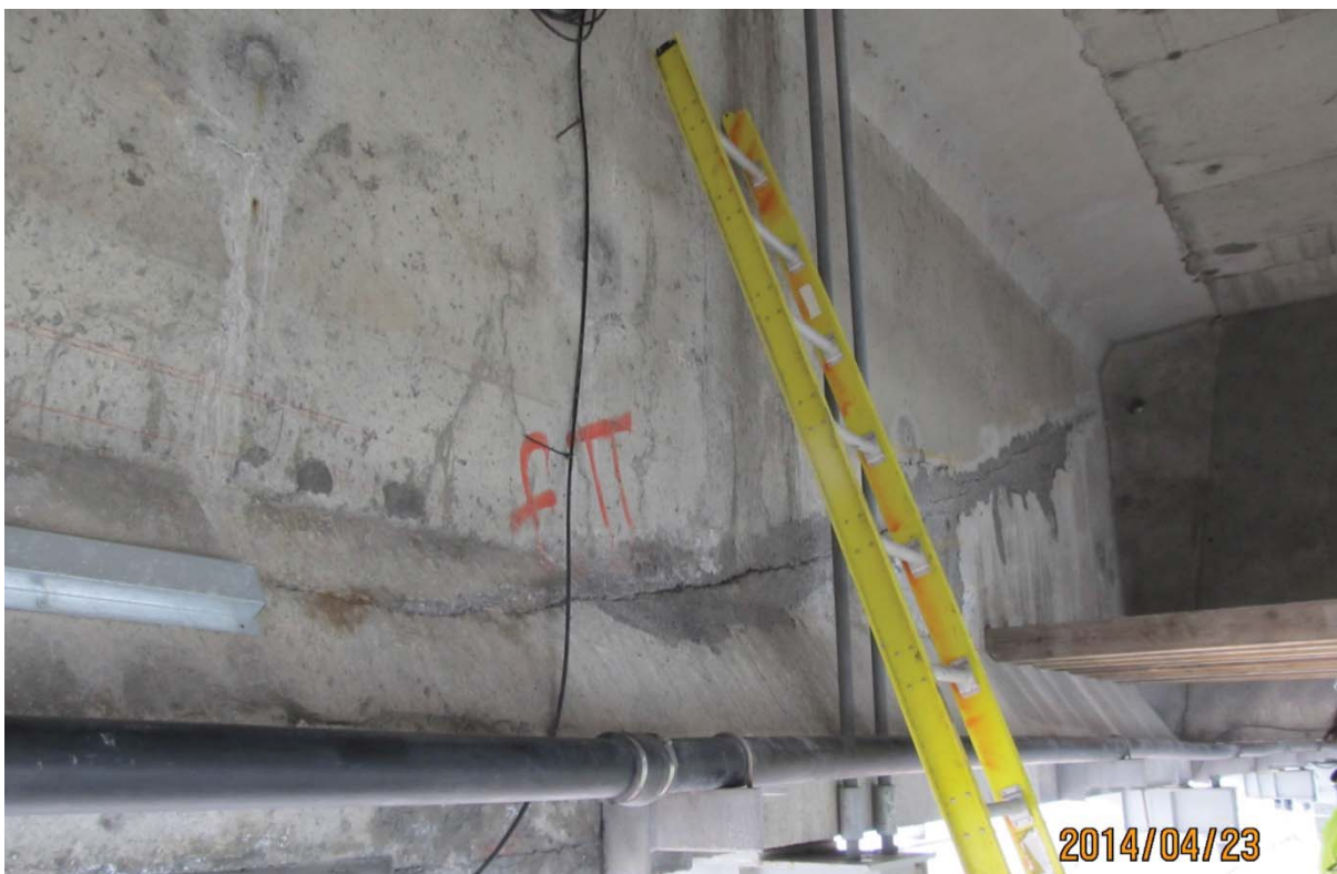
S5.PC.28W-29W.P7.h – 0438 (câble #24 – centre ouest face aval)
