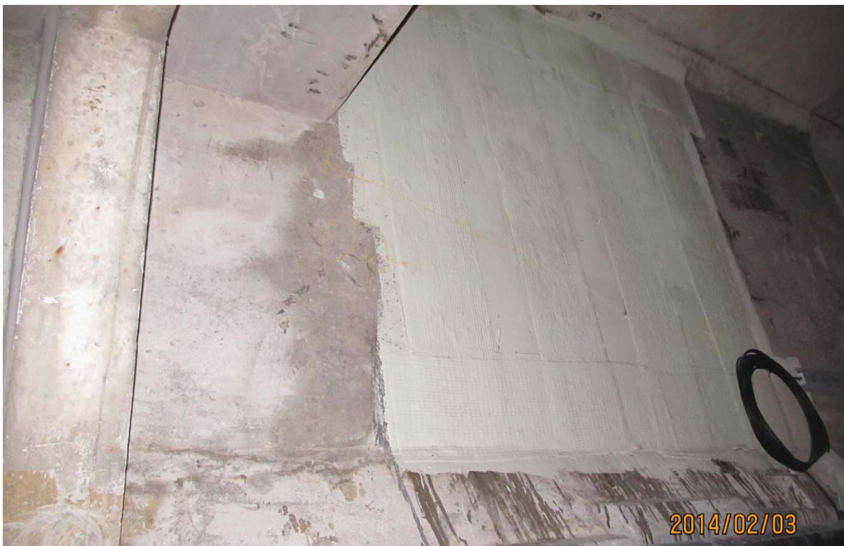
S7.PC.11E-12E.P7.c – 0230 (câble #22 – centre est face aval)
