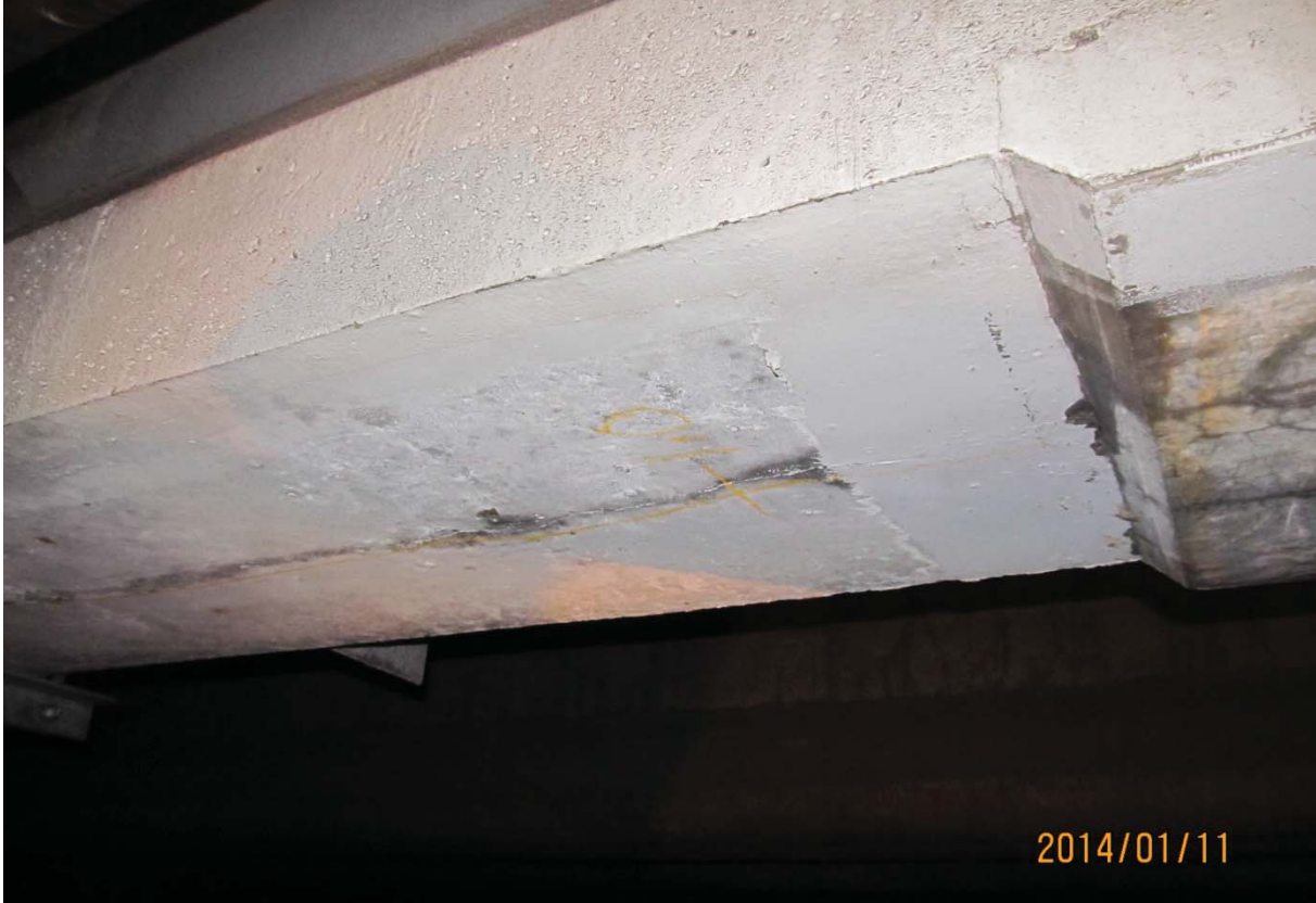
S5.PC.27W-28W.P1.e – 0136 (soffite - centre ouest)
