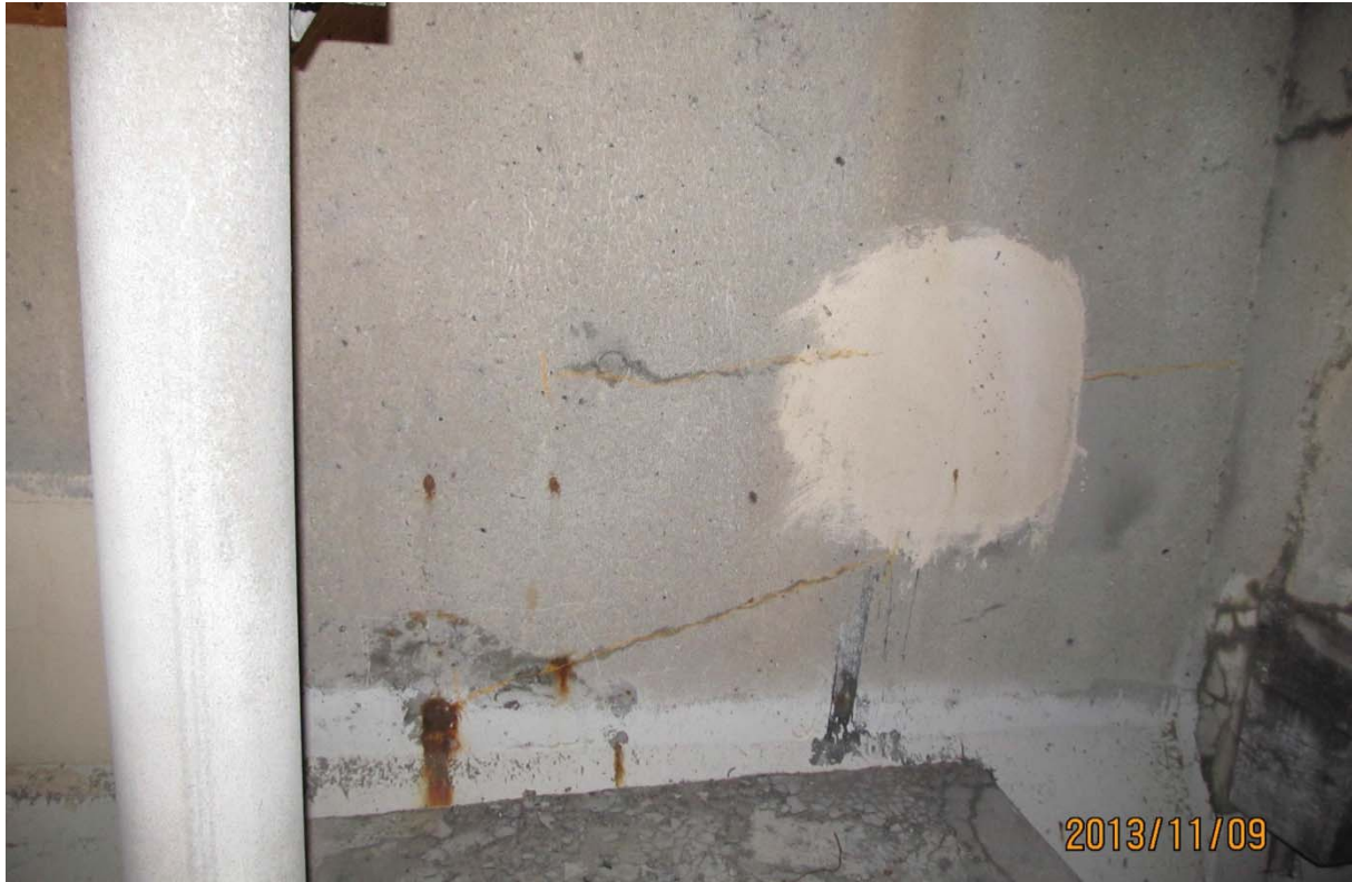
S5.PC.4W-5W.P1.c – 6208 (Fissures F5 et F6 - extrémité ouest face aval)
