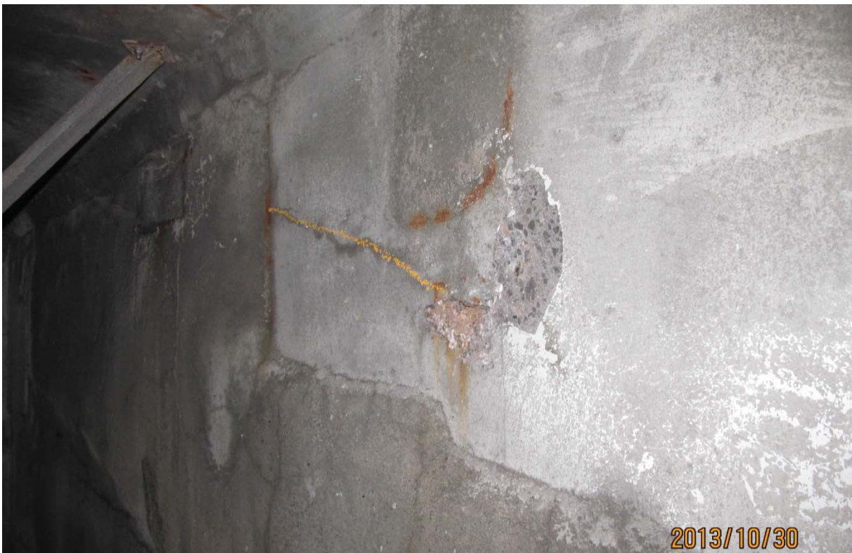
S5.PC.18W-19W.P7.b – 5982 (câble #18 – extrémité ouest face amont)
