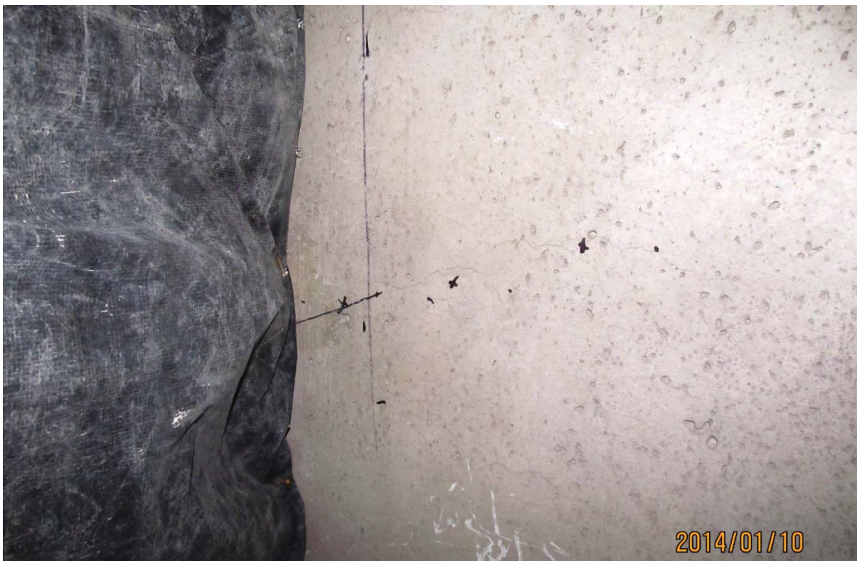
S7.PC.8E-9E.P1.b – 0097 (câble #22 - extrémité est face amont)
