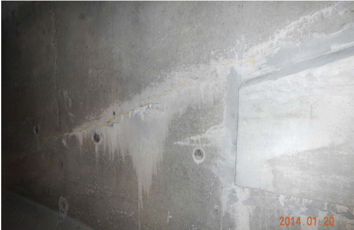
S5.PC.28W-29W.P4.c – 7440 (câble #17 – extrémité est face amont)
