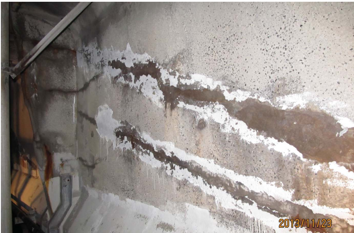
S5.PC.29W-30W.P7.f – 6392 (câbles #23 et #24 – centre ouest face amont)
