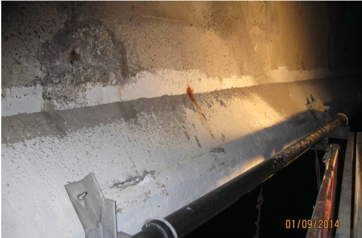
S5.PC.23W-24W.P7.c – 0470 (fissure horizontale semelle inférieure – centre ouest face amont)
