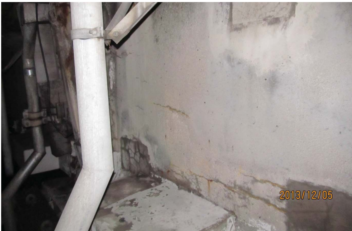
S5.PC.04W-05W.P7.a – 6596 (câble #6, #8 et #9 – extrémité ouest face amont)
