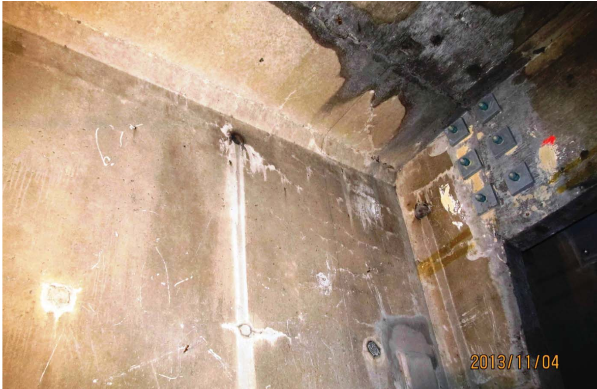
S5.PC.18W-19W.P1.c – 6084 (âme - extrémité ouest face amont)
