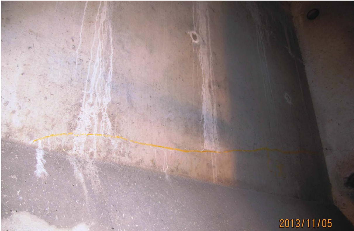
S5.PC.16W-17W.P7.l – 6108 (câble #22 – centre ouest face aval)
