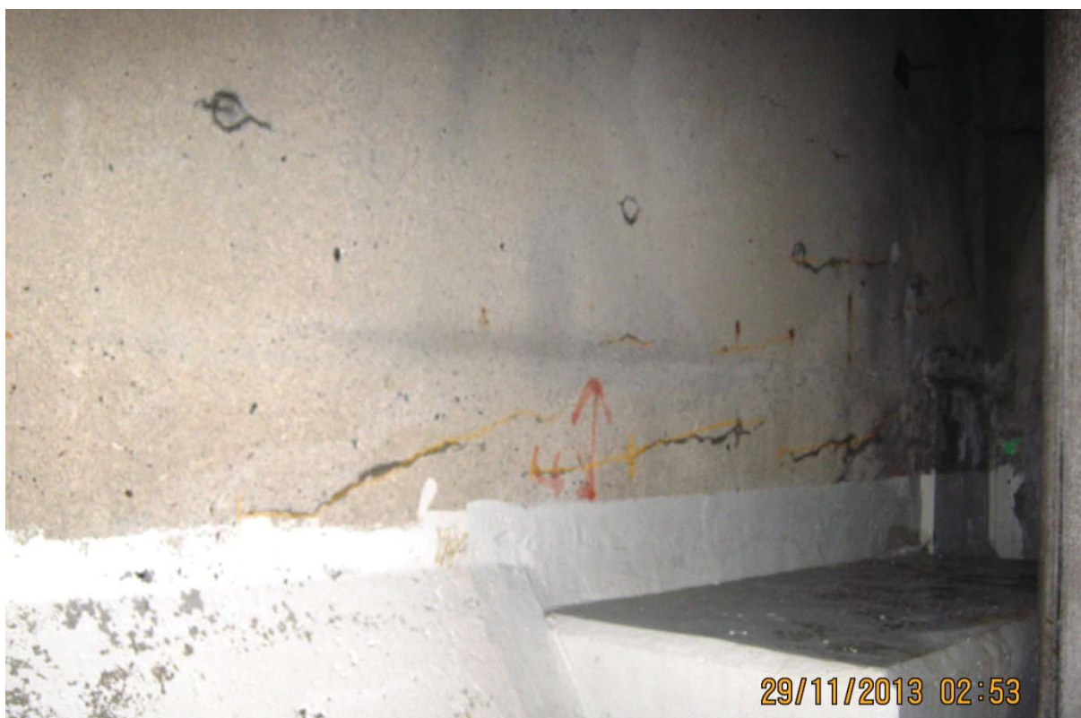
S5.PC.10W-11W.P7.f – 0116 (âme – extrémité est face amont)
