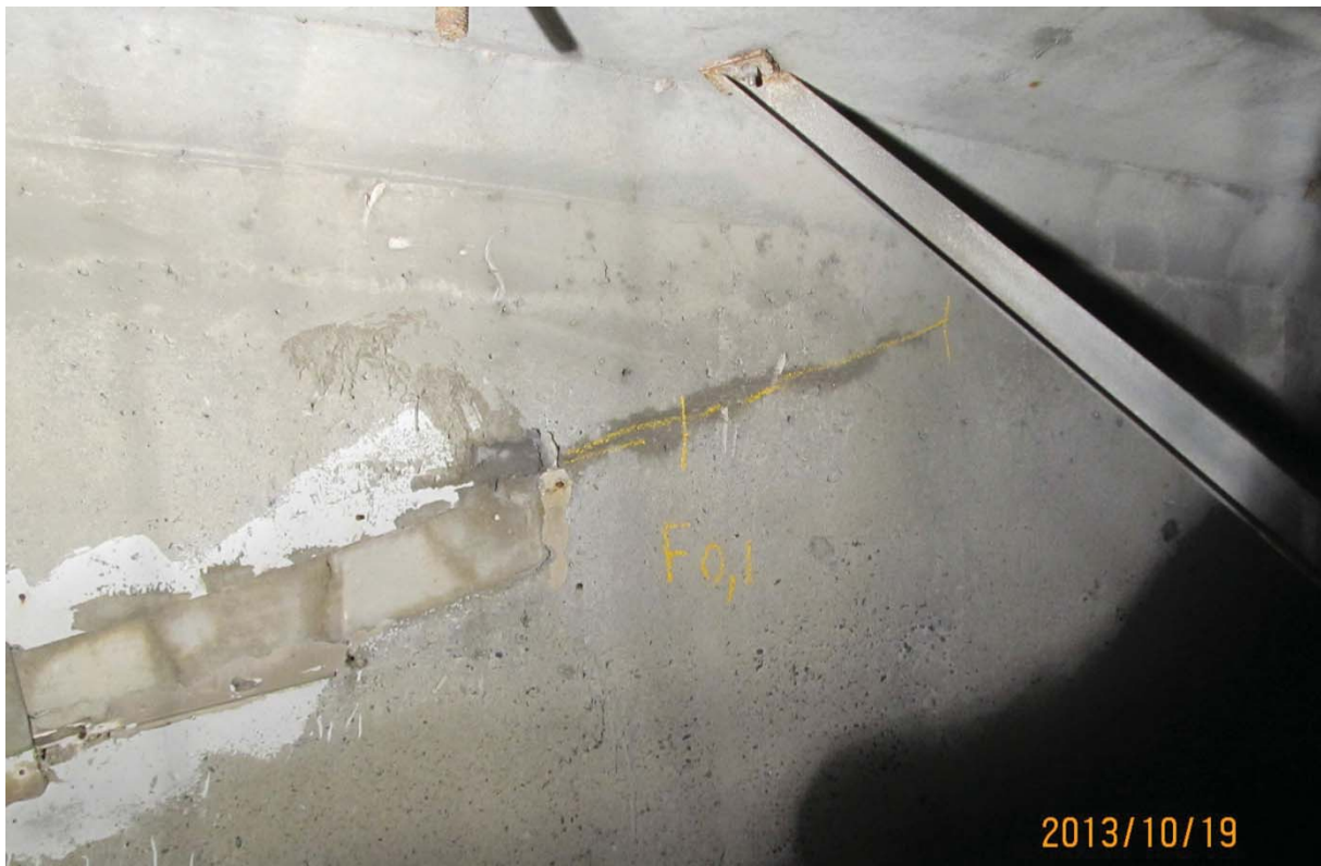
S5.PC.30W-31W.P7.d – 5863 (câble #19 - extrémité est face amont)
