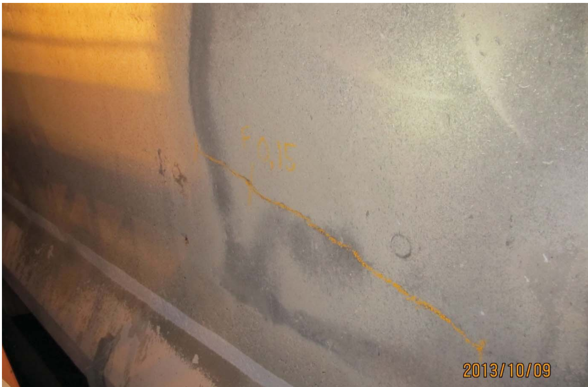
S5.PC.40W-41W.P7.b – 5688 (câble #16 - extrémité ouest face amont)
