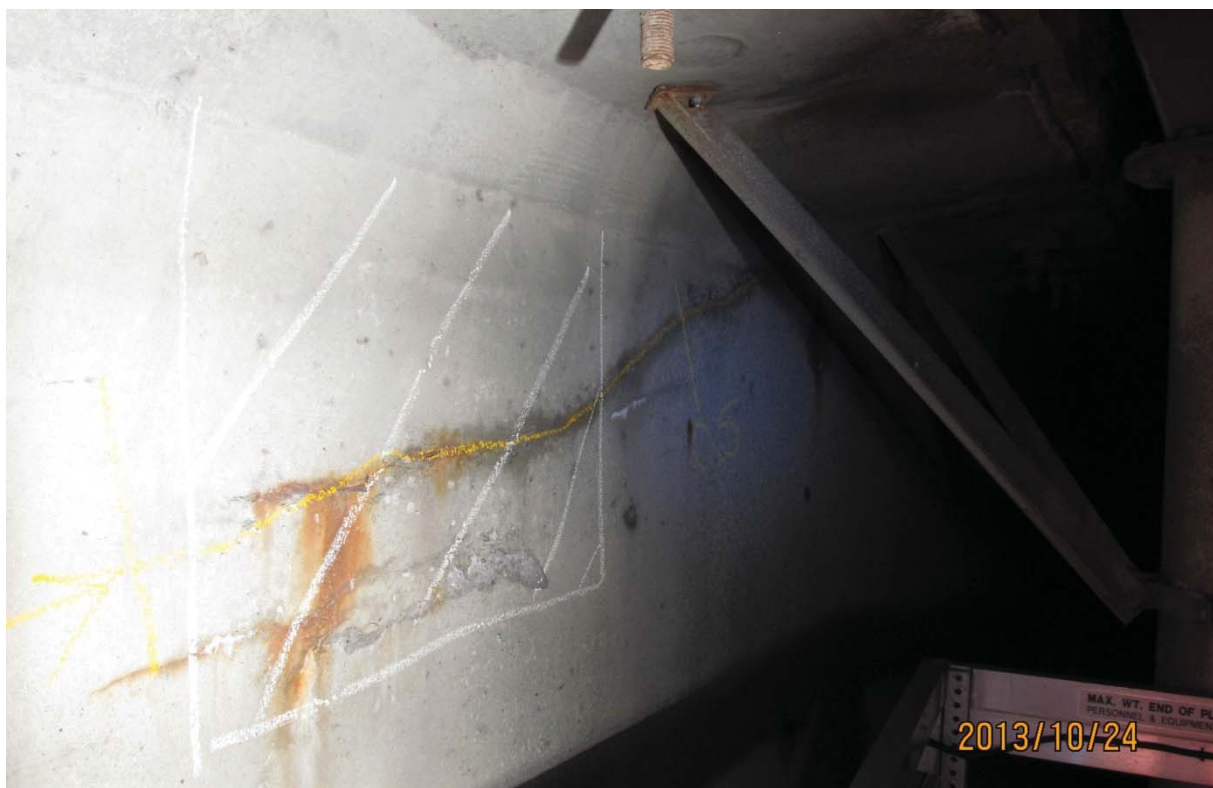
S5.PC.39W-38W.P7.d – 5906 (câble #19 – extrémité est face amont)
