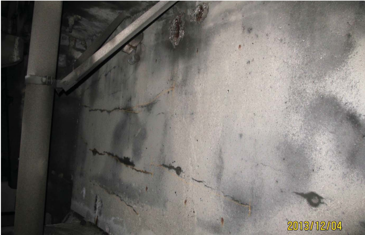
S5.PC.14W-15W.P1.a – 6582 (fissures F1 à F3 – extrémité est face aval)
