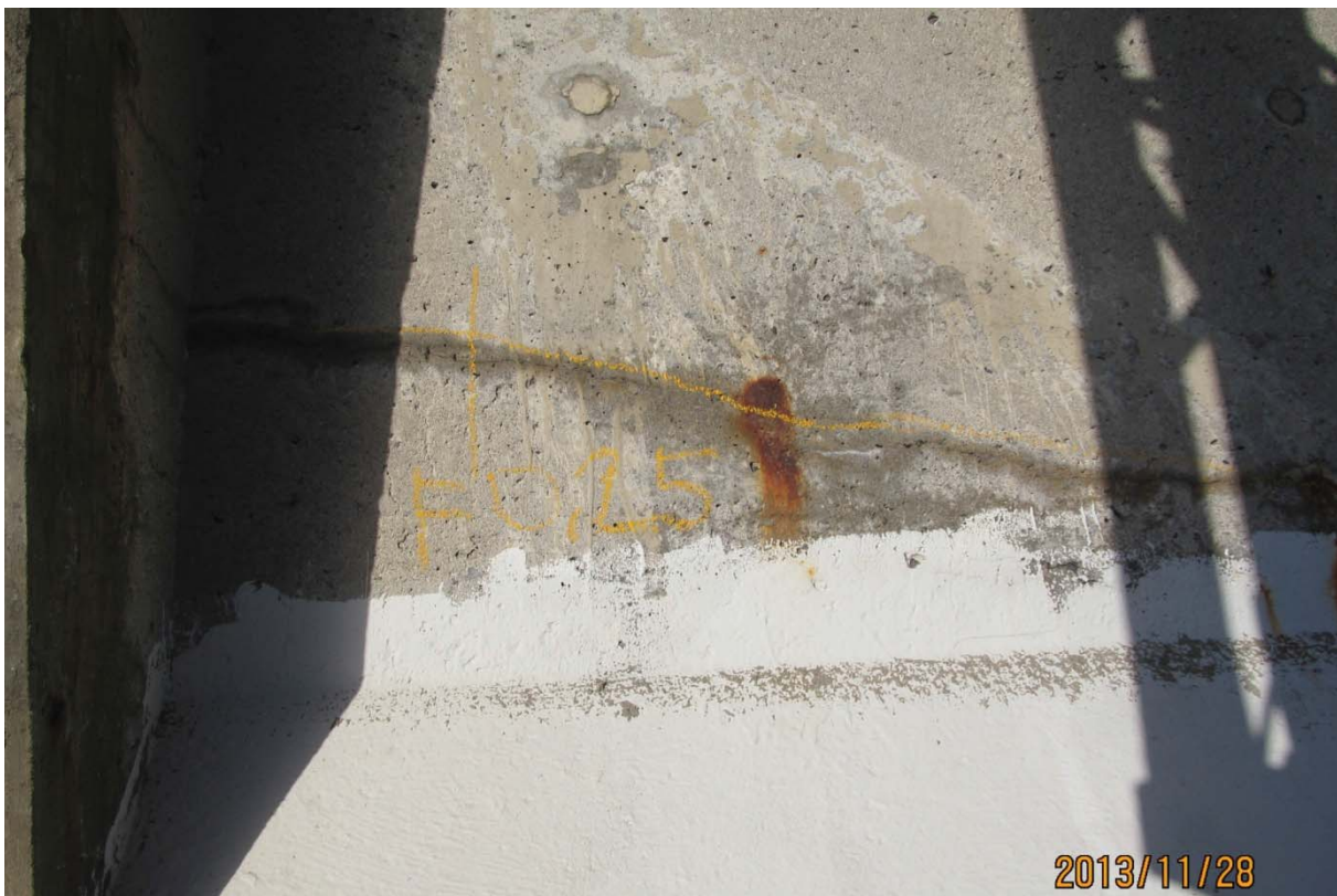
S5.PC.14W-15W.P7.d – 6474 (câble #22 – centre ouest face amont)
