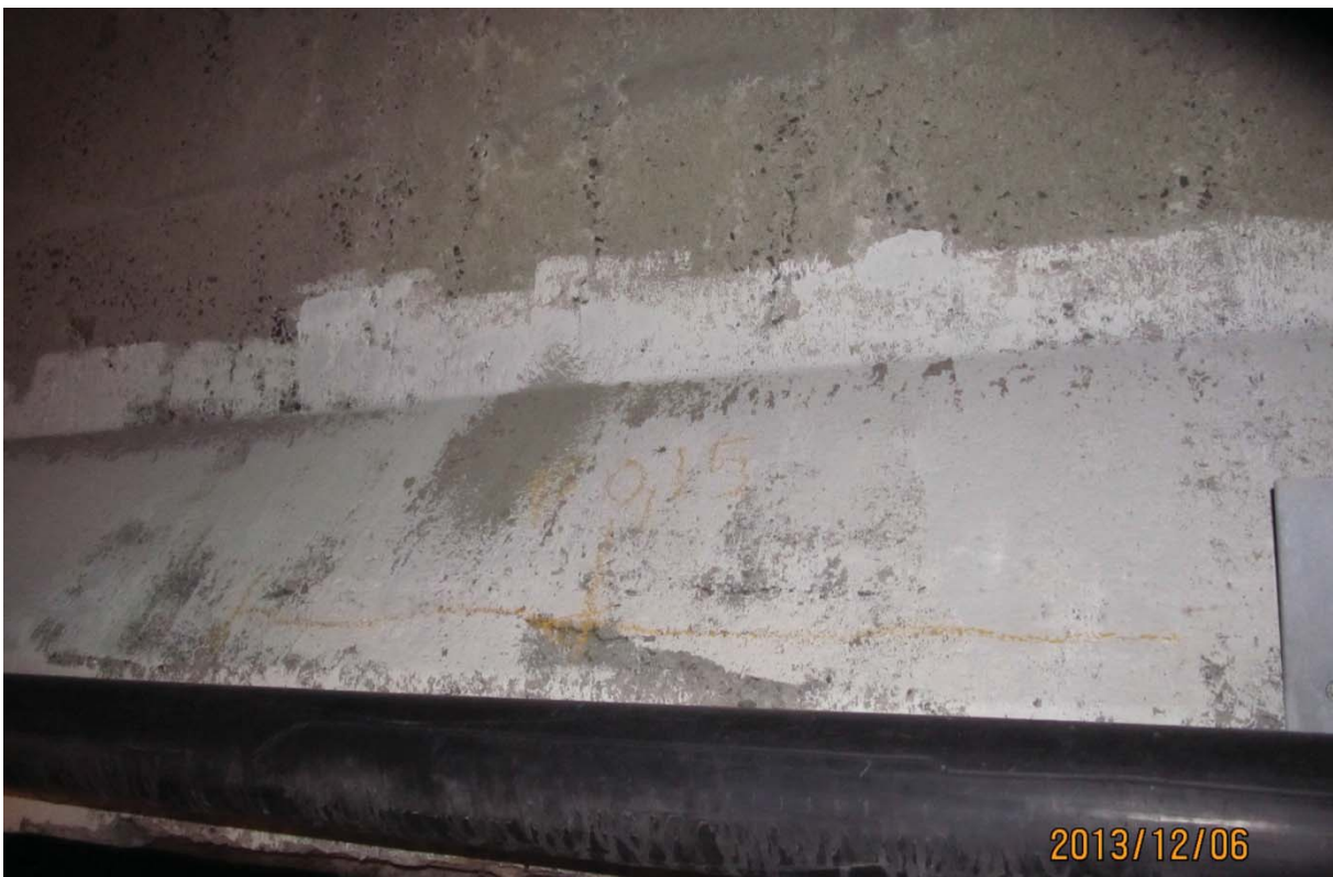
S5.PC.34W-35W.P7.b – 6625 (fissure horizontale semelle inférieure - extrémité ouest face amont)
