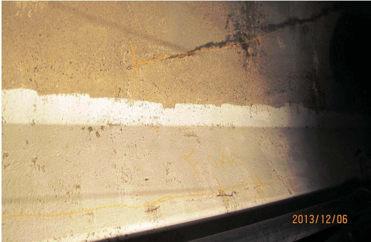
S5.PC.34W-35W.P7.c – 6627 (fissure horizontale semelle inférieure - centre est face amont)
