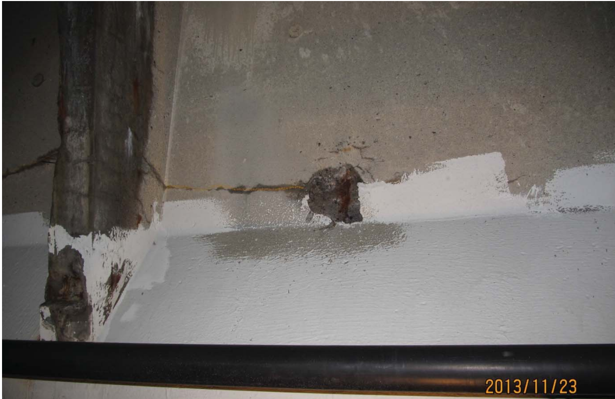
S5.PC.13W-14W.P7.e – 6412 (âme – extrémité est face amont)
