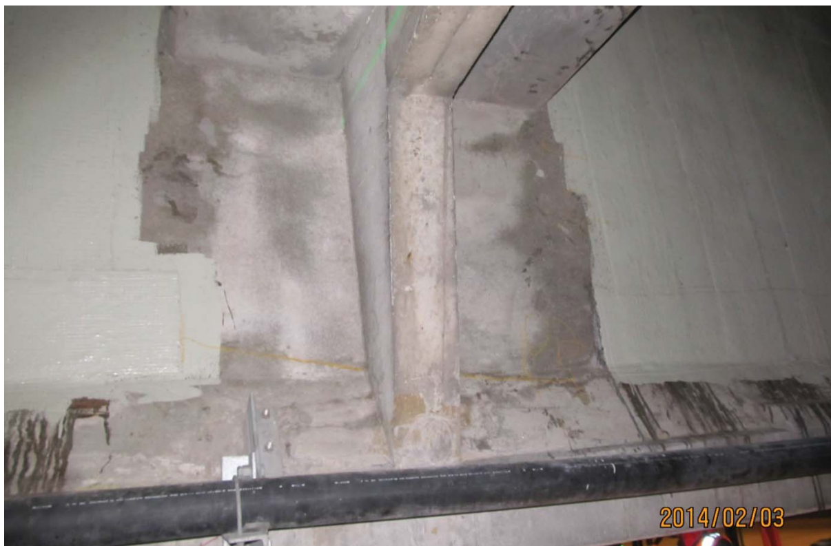
S7.PC.11E-12E.P7.b – 0231 (câble #20 – centre est face aval)
