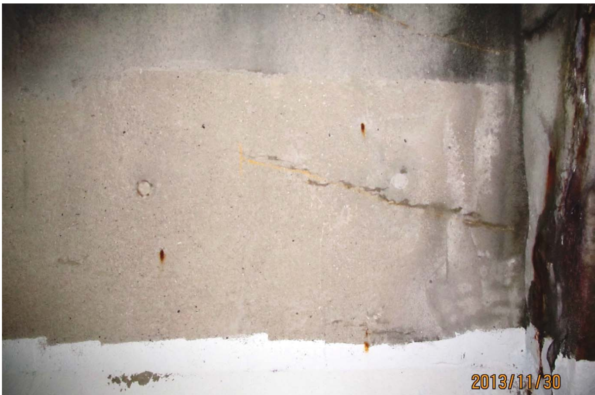
S5.PC.7W-8W.P7.c – 6534 (câbles #22 et #23 – extrémité ouest face amont)
