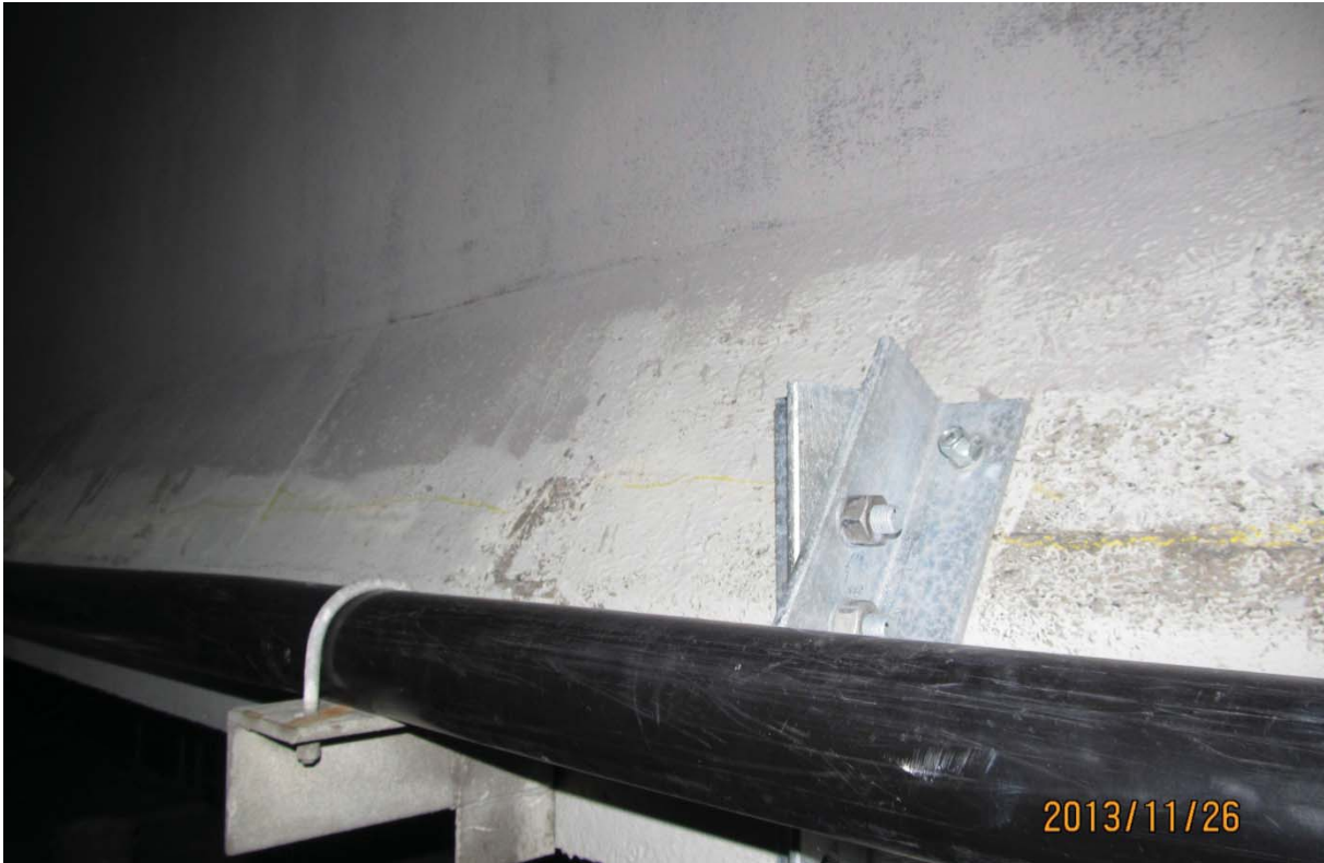
S5.PC.27W-28W.P7.e – 6424 (fissure horizontale semelle inférieure – extrémité est face amont)
