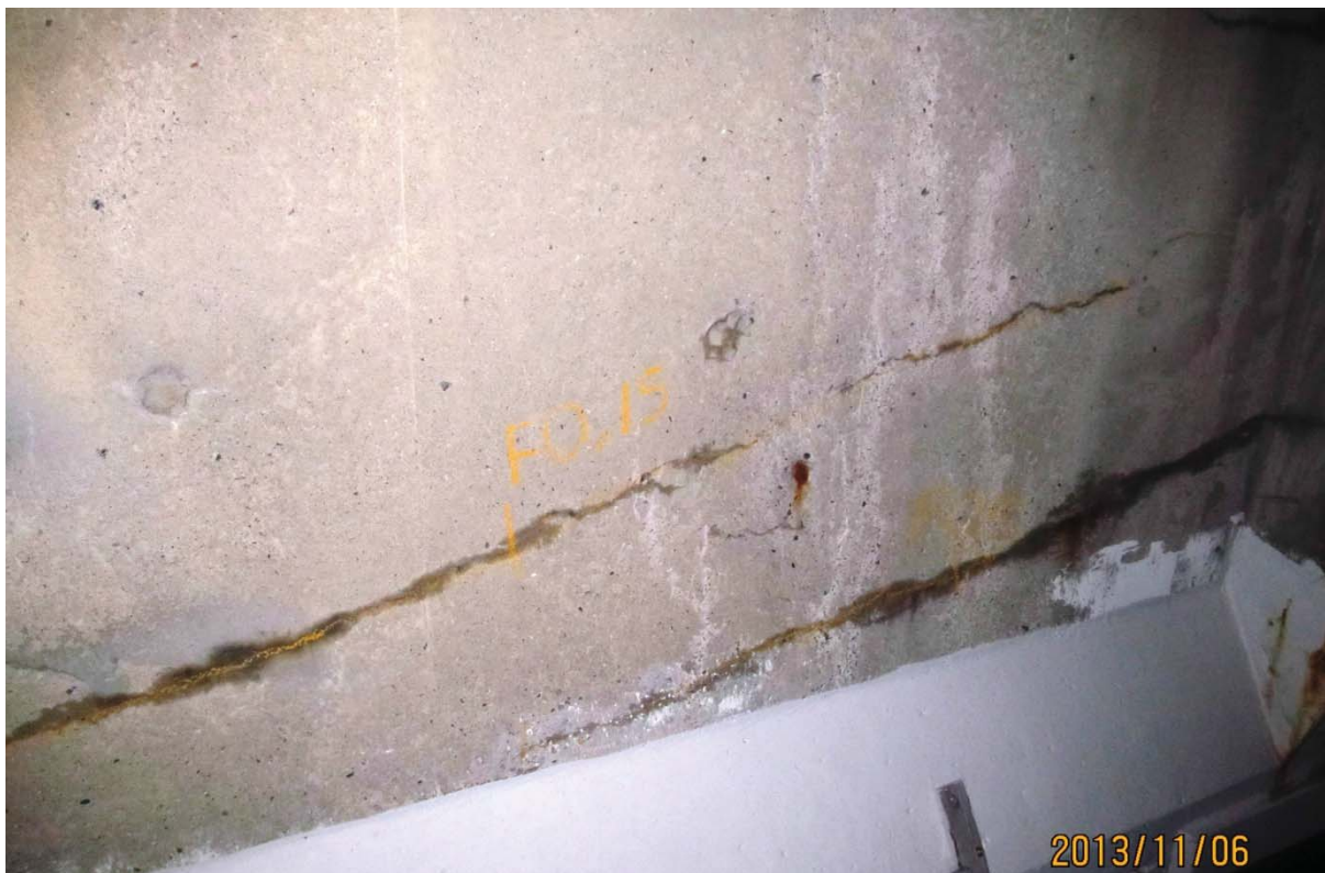
S5.PC.17W-18W.P7.g – 6133 (câble #22 – centre est face amont)
