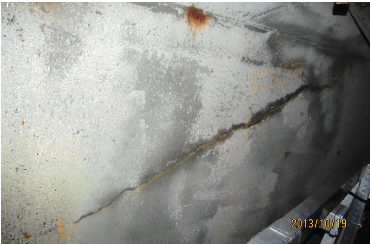
S5.PC.35W-36W.P7.d – 5844 (câble #19 - extrémité est face amont)
