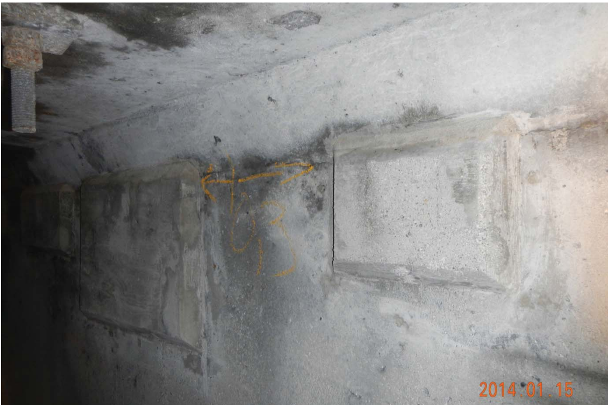
S5.PC. 12W-13W.P7.d – 7375 (fissure horizontale au gousset supérieur - centre face amont)
