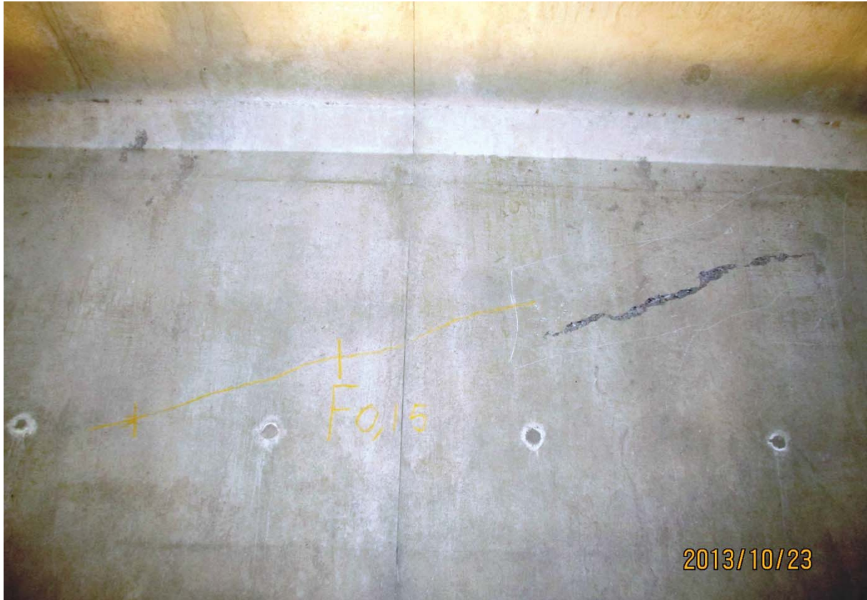
S5.PC.15W-16W.P1.c – 5897 (câble #19 - extrémité est face amont)
