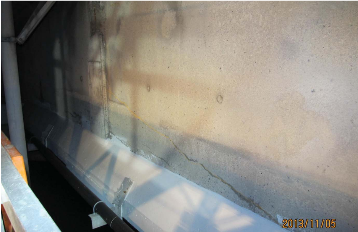
S5.PC.17W-18W.P7.e – 6122 (câbles #15 et #17 – extrémité ouest face amont)
