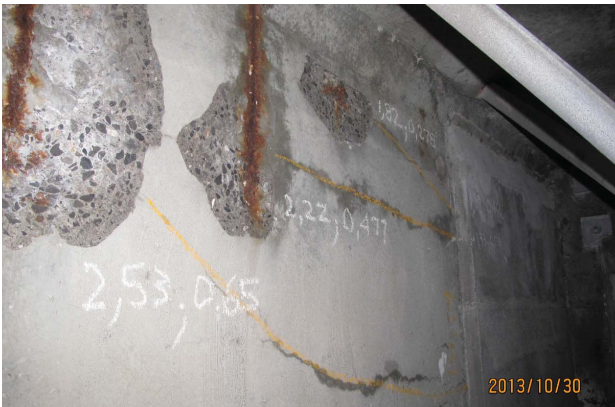
S5.PC.18W-19W.P7.f – 5994 (âme – extrémité est face amont)
