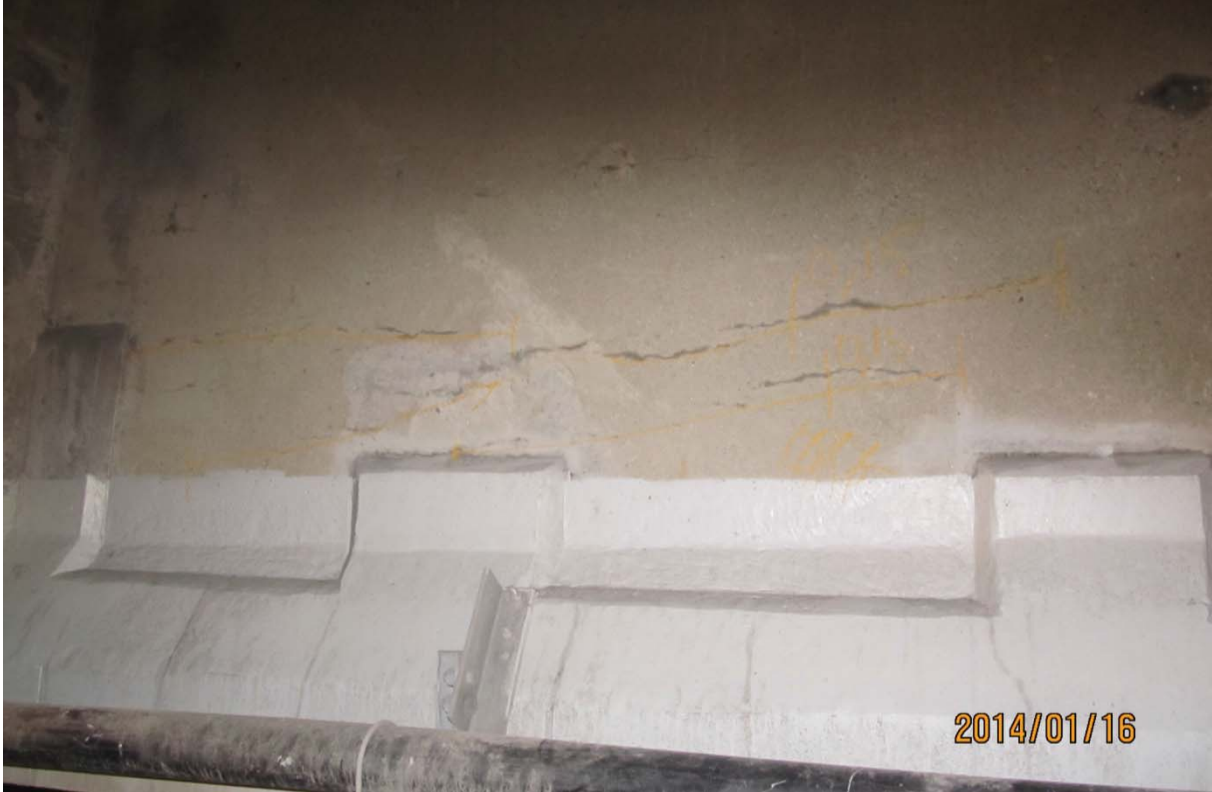
S7.PC.10E-11E.P1.c – 0168 (âme – centre ouest face aval)
