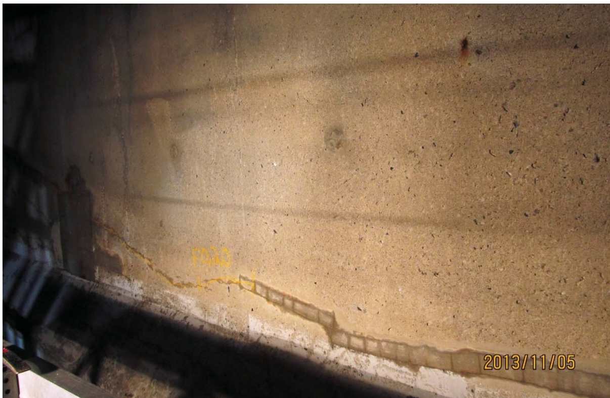
S5.PC.16W-17W.P7.c – 6095 (âme – extrémité ouest face amont)
