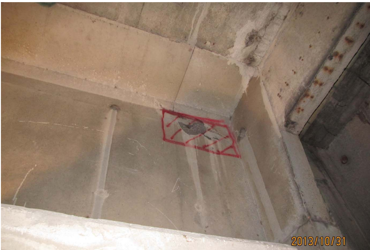
S5.PC.35W-36W.P1.f – 6067 (âme – extrémité est face amont)
