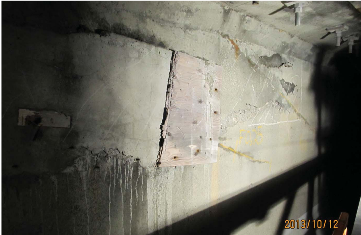
S5.PC.41W-42W.P1.c – 5750 (câbles #19 et #20 - extrémité est face aval)
