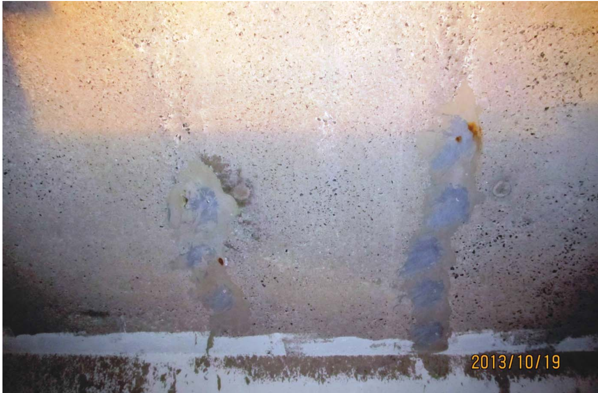
S5.PC.30W-31W.P7.c – 5858 (fissures verticales sur l'âme - centre ouest face amont)
