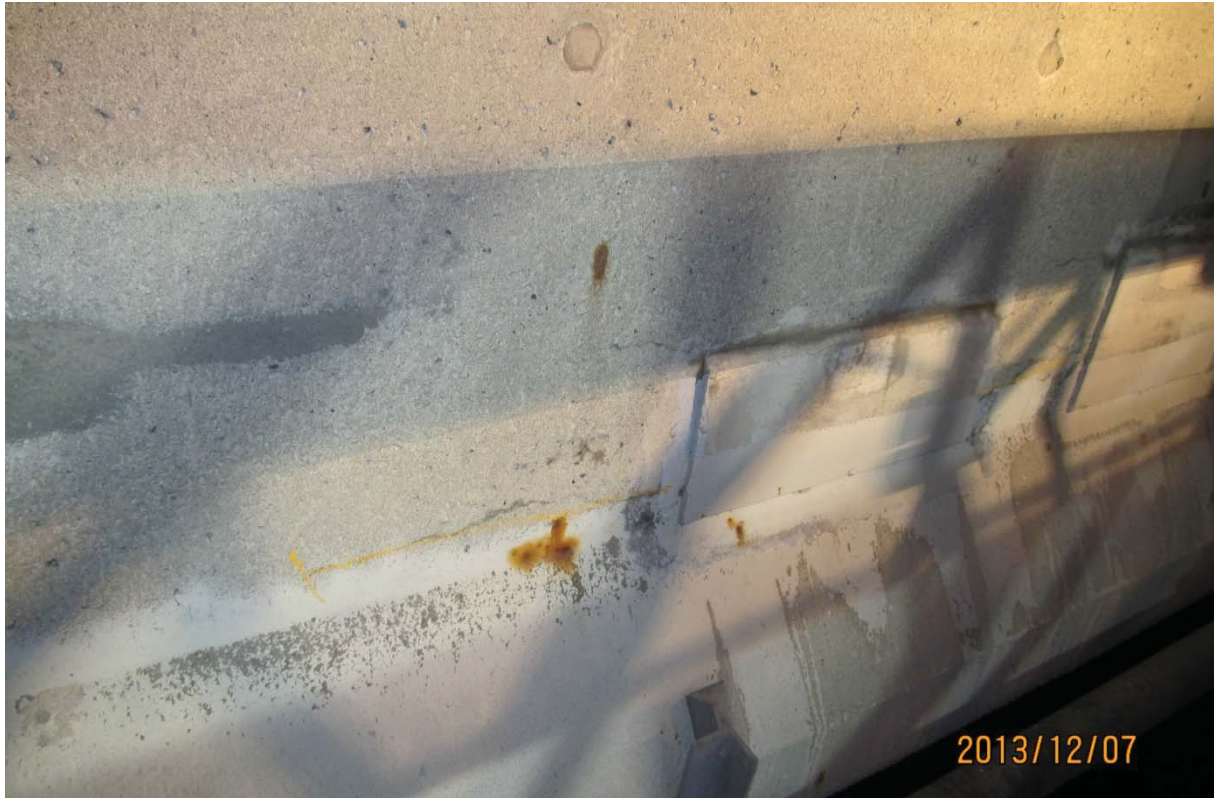
S5.PC.14W-15W.P1.c – 6648 (âme fissure horizontale - extrémité ouest face aval)
