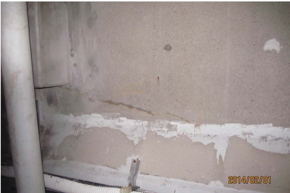
S5.PC.32W-33W.P7.d – 0213 (câble #22 – centre ouest face amont)
