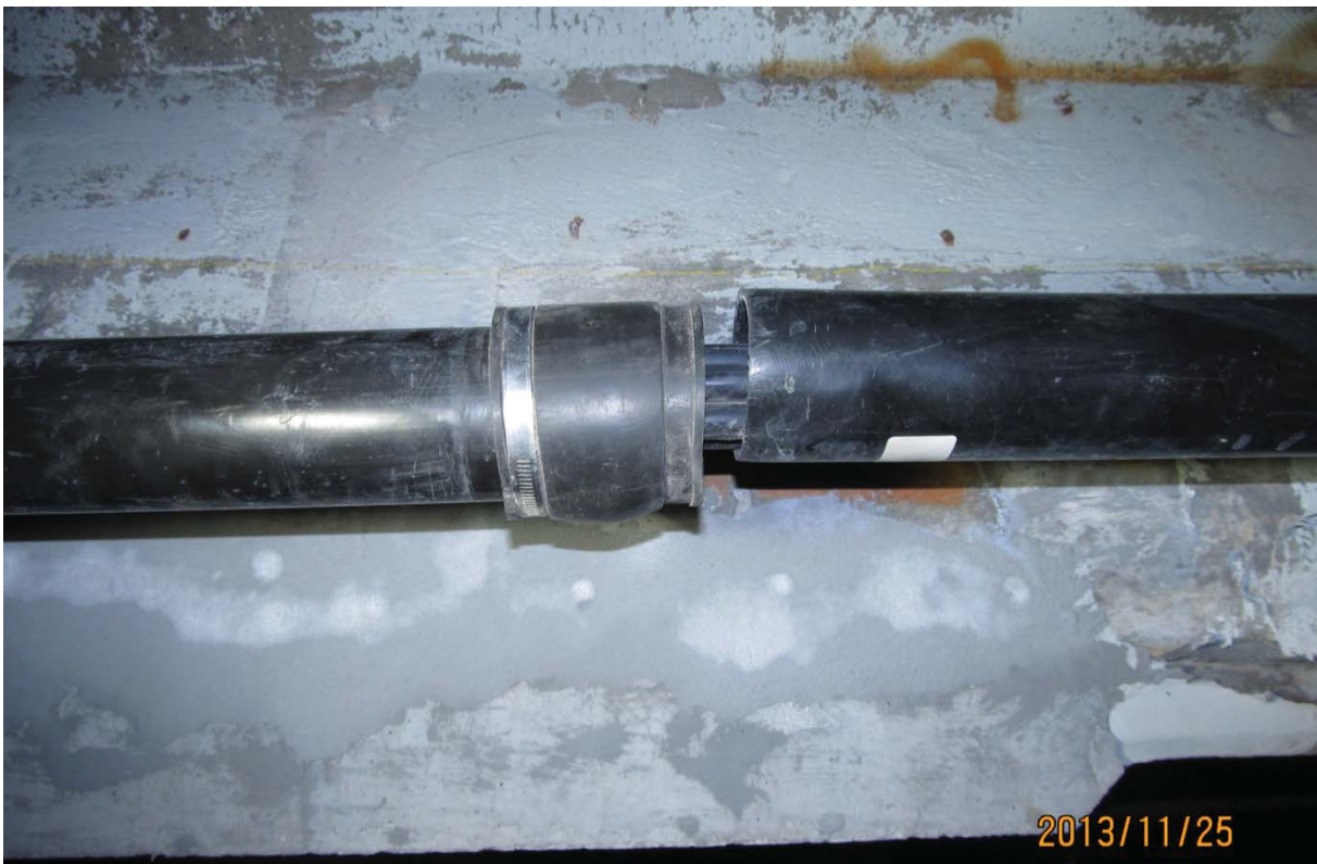
S5.PC.27W-28W.P7.b – 6420 (Post-tension extérieure gaine détachée – centre est face amont)
