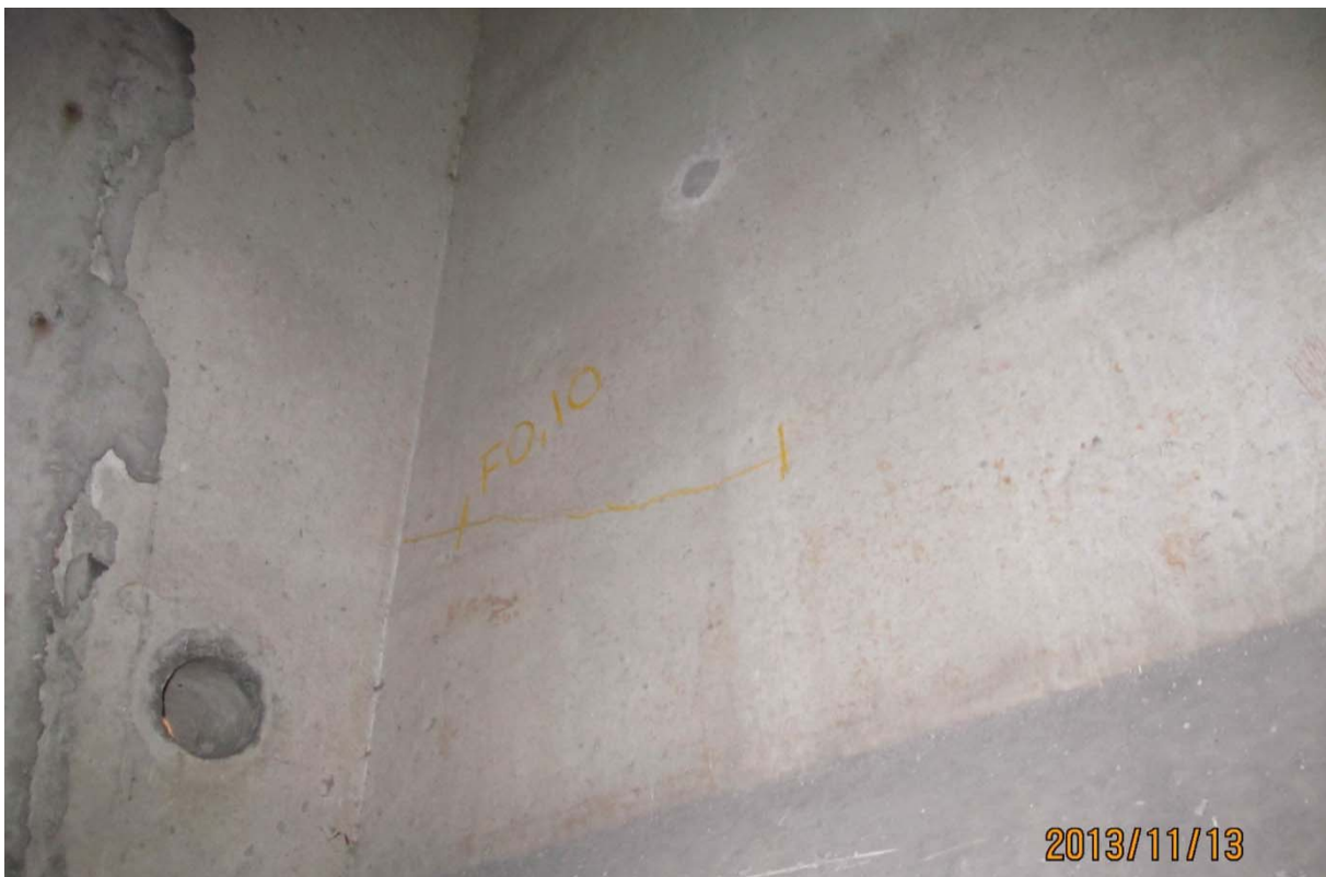
S5.PC.24W-25W.P7.f – 6273 (câble #22 – centre est face aval)
