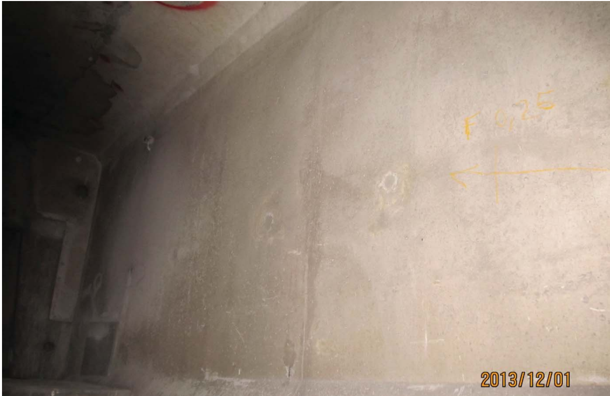
S7.PC.4E-5E.P7.c – 6545 (câbles #14 – extrémité est face aval)
