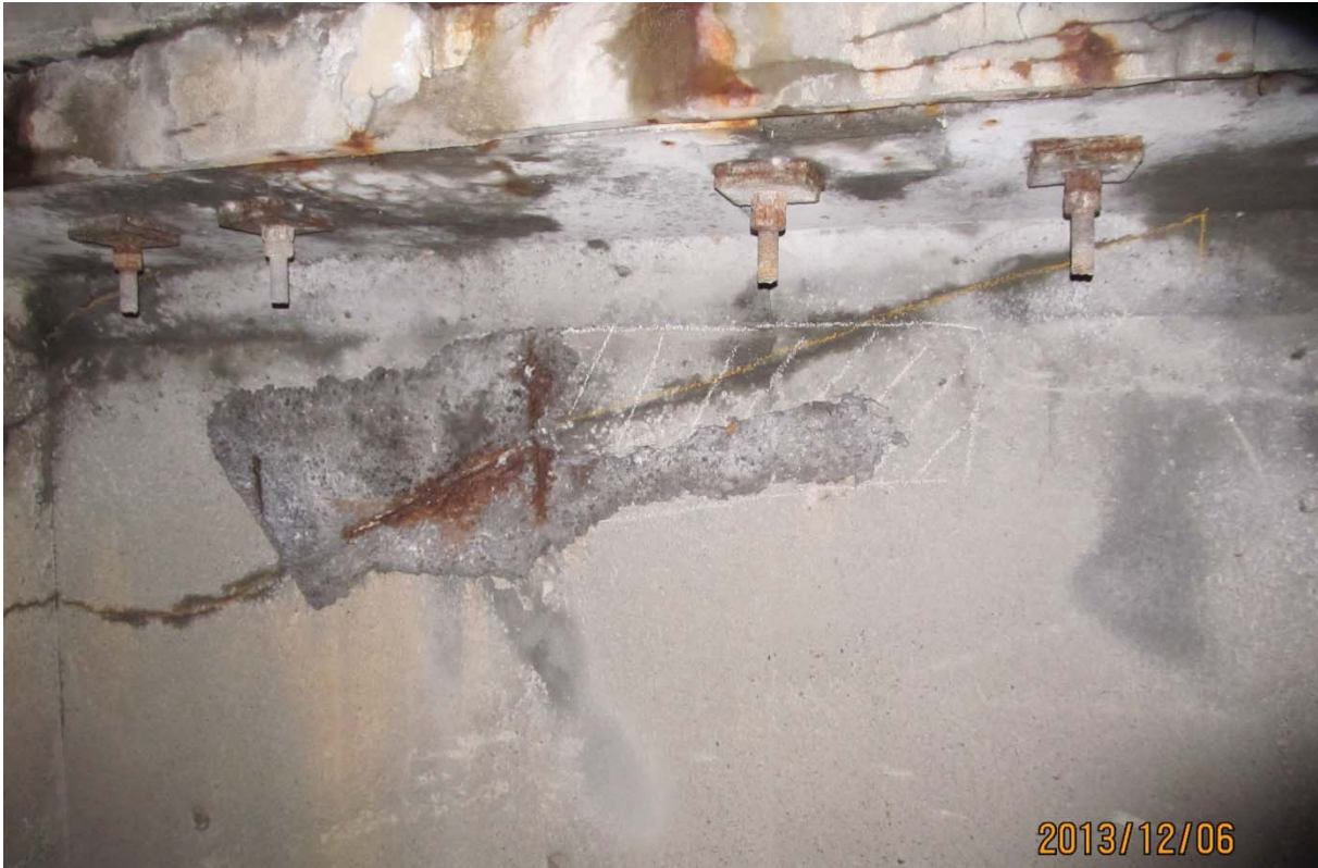
S5.PC.34W-35W.P7.e – 6631 (câble #23 – extrémité est face amont)
