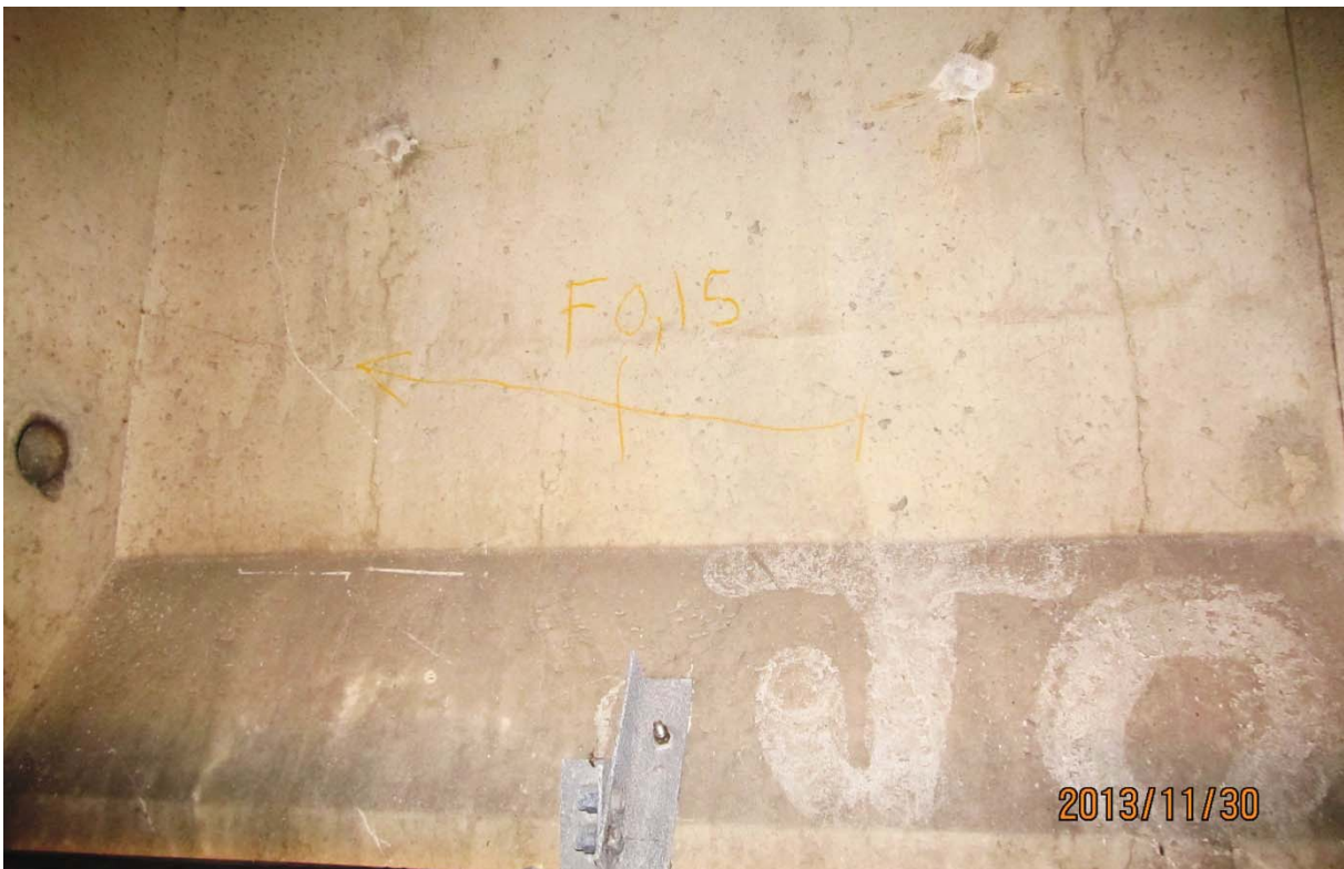
S5.PC.9W-10W.P7.f – 6512 (câble #22 – centre est face aval)
