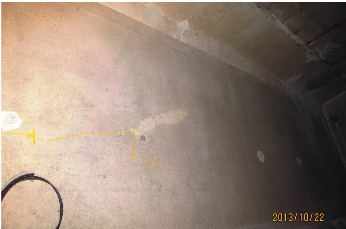
S7.PC.4E-5E.P1.f – 5888 (câble #15 - extrémité est face amont)
