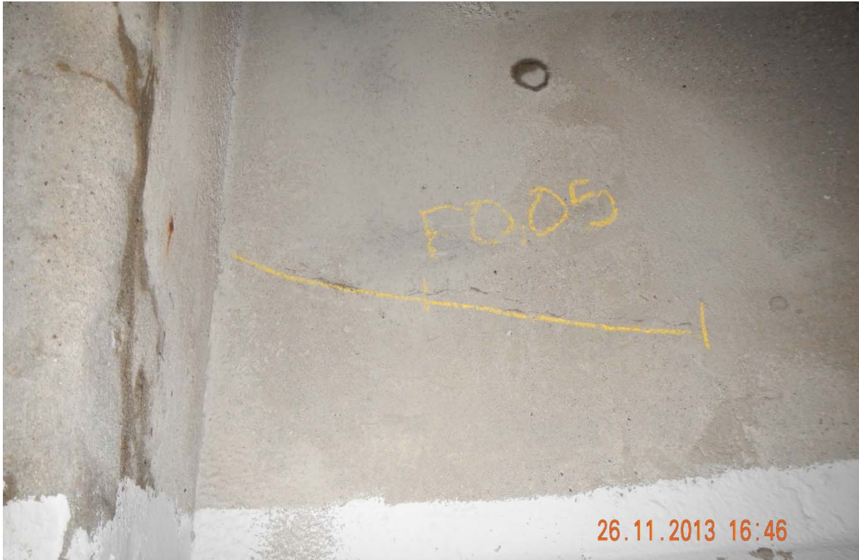
S5.PC.21W-20W.P7.e – 4392 (câble #22 – centre ouest face amont)
