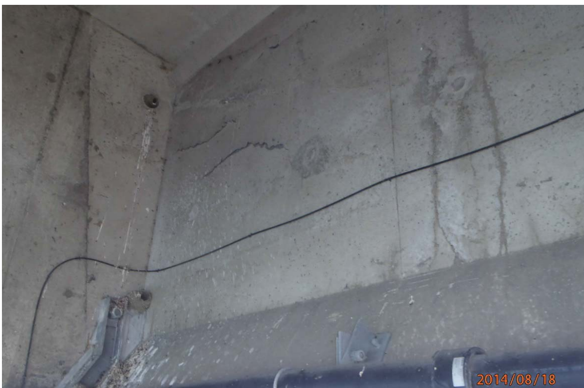
S5.PC.34W-35W.P7.j – PH.20140821_P7_34W-35W_061 (câble #24 – centre est face aval)
