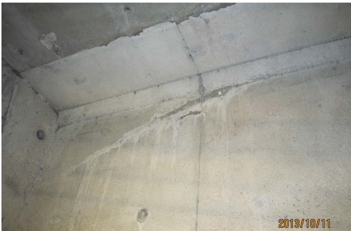
S5.PC.38W-39W.P1.d – 5737 (câble #23 - extrémité est face amont)
