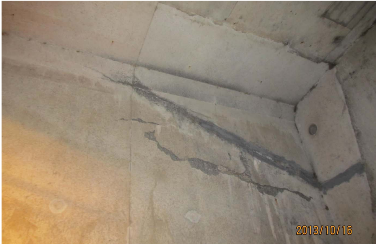
S5.PC.37W-38W.P1.g – 5799 (câble #23 - extrémité ouest face amont)
