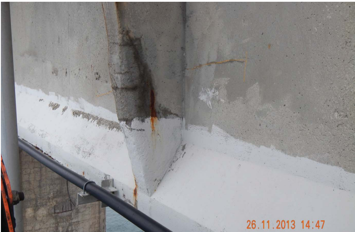
S5.PC.21W-20W.P7.f – 4371 (câble #22 – centre/extrémité est face amont)
