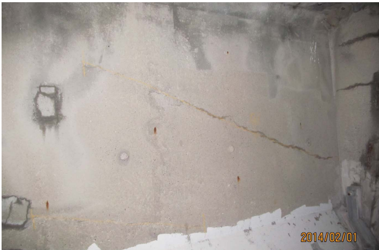
S5.PC.33W-34W.P7.c – 0207 (câbles #20 et #22 – extrémité ouest face amont)
