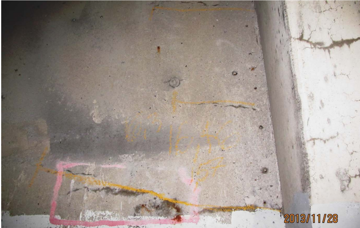
S5.PC.11W-12W.P7.b – 6491 (câbles #21, #22 et #23 – extrémité ouest face amont)
