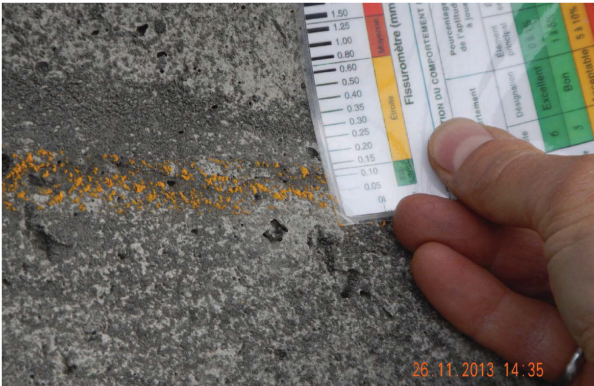
S5.PC.21W-20W.P7.d – 4369 (Fissure F5 détail - face amont)
