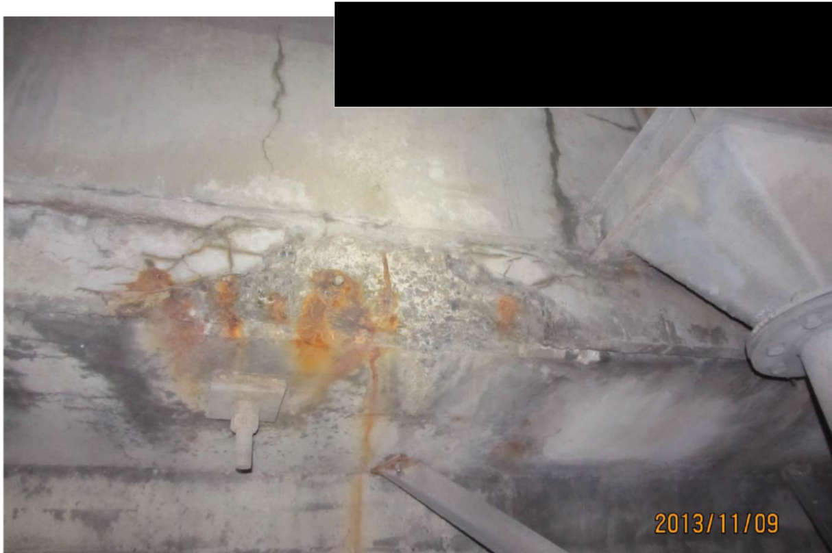
S5.PC.4W-5W.P1.e – 6203 (semelle supérieure – ancrage de la post-tension de la dalle face aval)
