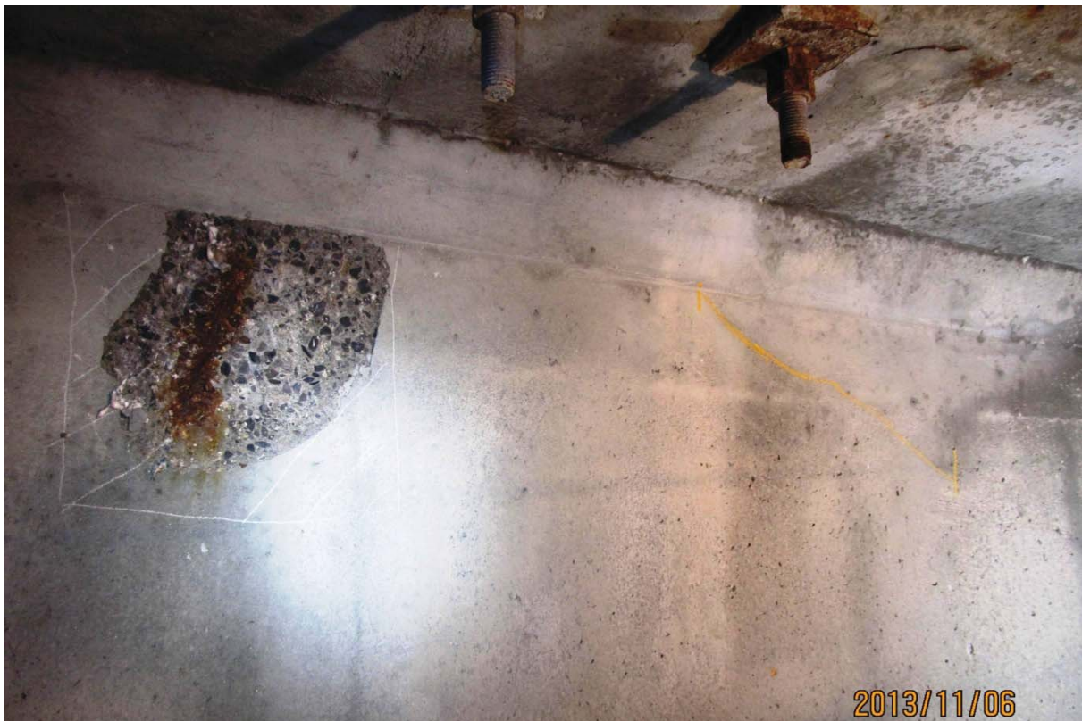
S5.PC.17W-18W.P7.b – 6128 (câble #17 – extrémité ouest face amont)
