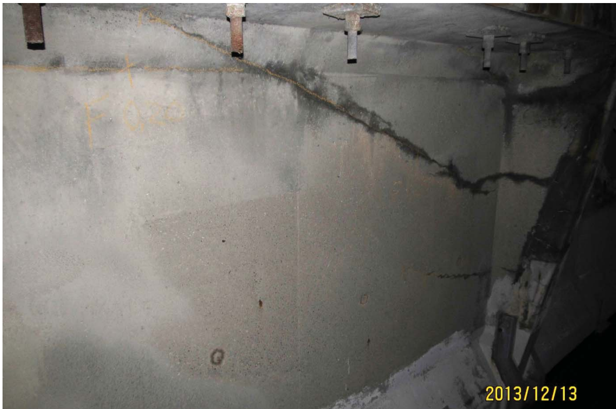
S5.PC.31W-32W.P7.b – 6785 (câble #23 - extrémité ouest face amont)
