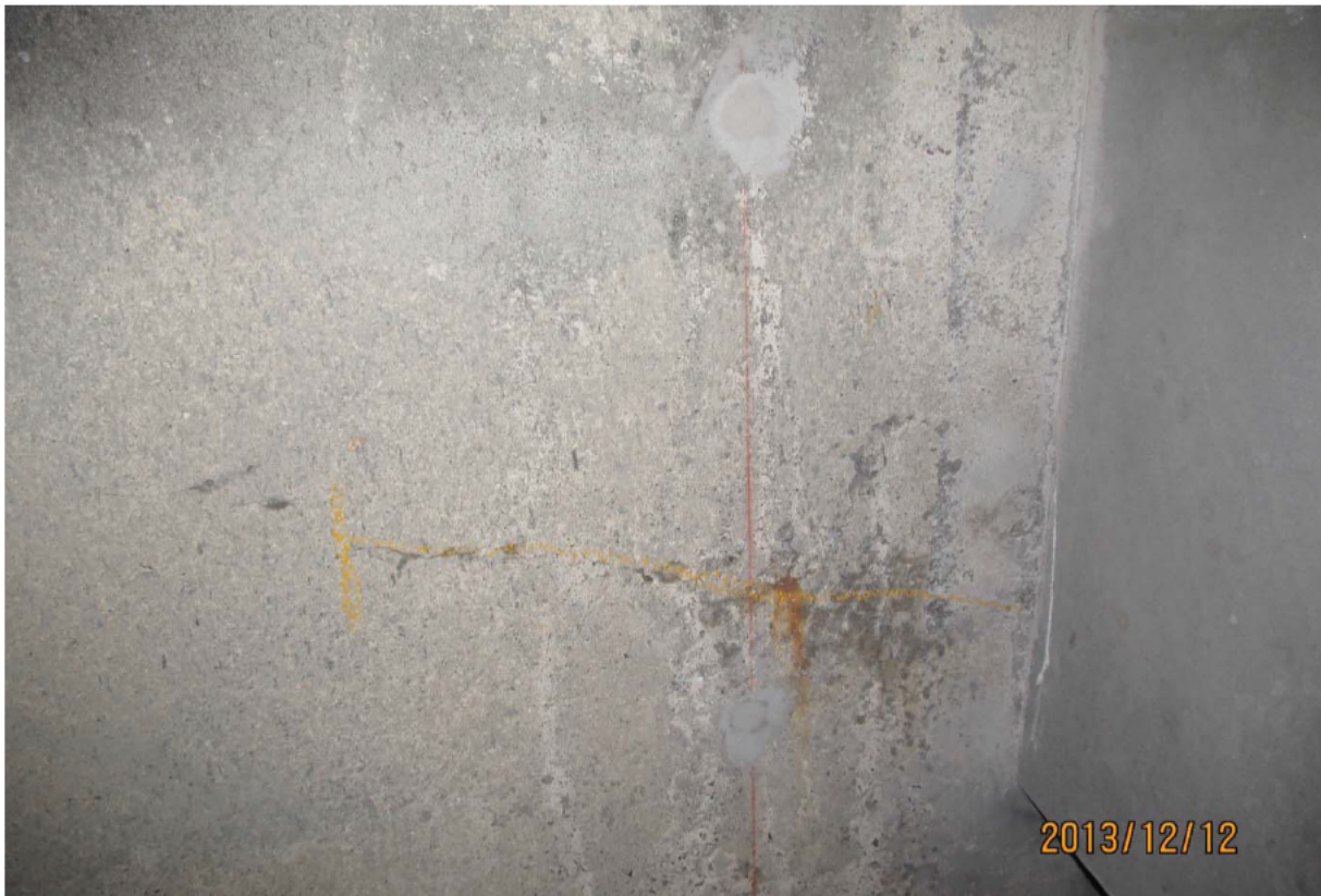
S5.PC.21W-22W.P7.b – 6764 (câble #22 – extrémité ouest face amont)
