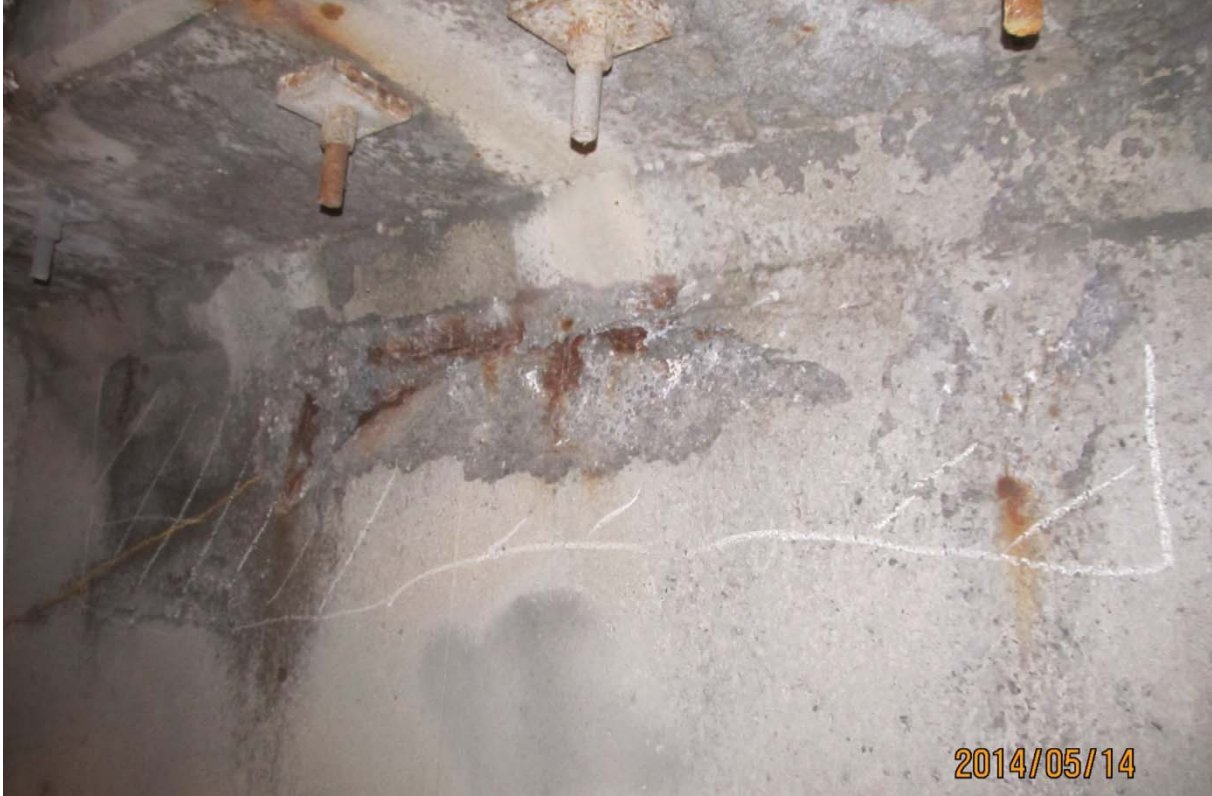
S5.PC.23W-24W.P1.a – 0486 (câble #23 - extrémité ouest face aval)
