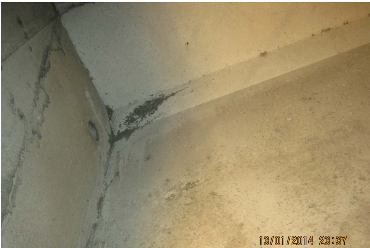
S5.PC.25W-26W.P1.b – 0270 (câble #24 - extrémité ouest face amont)
