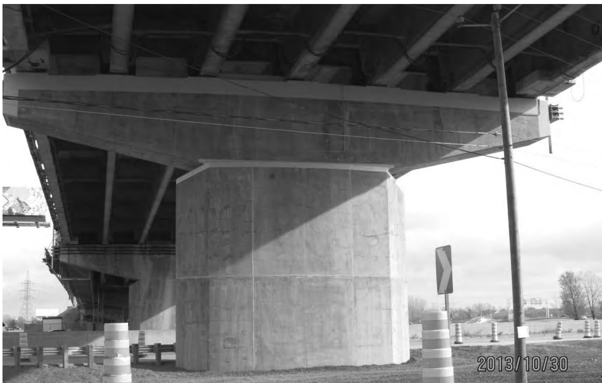
S7.PC.1.1.b – 5997 – Pile 10E (face ouest)
