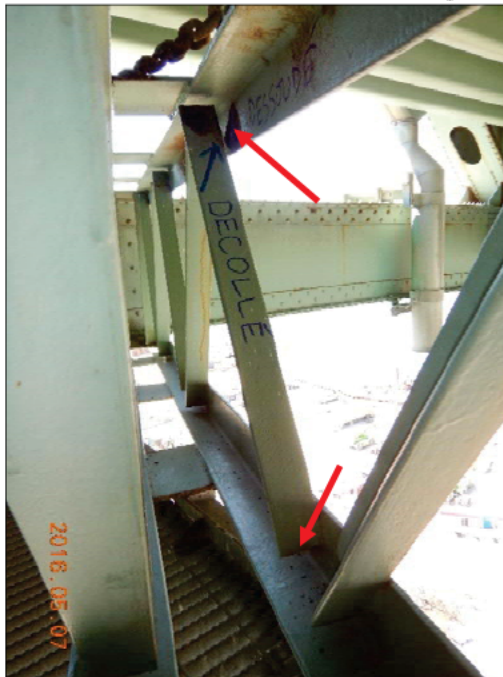
Photo 2015050 [REDACTED] 3908 : Axe 0.5W, Contreventement inférieur horizontal (L17-L16) Soudure sectionnée à une extrémité de la diagonale et soudure fissurée à l'autre extrémité (cornière)
