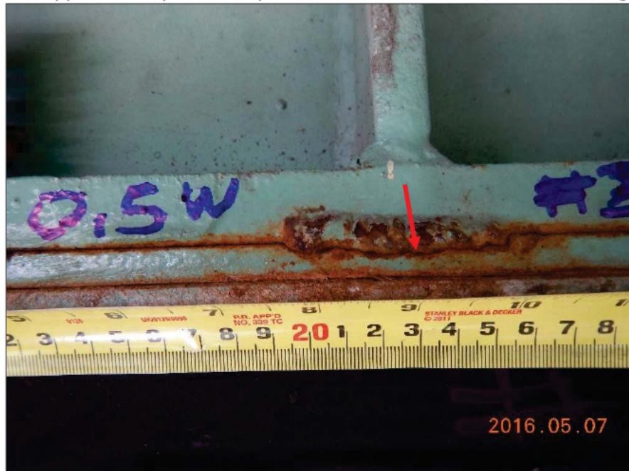
Photo 2015050 3890 : Axe 0.5W, Appareil d'appui à ressorts, groupe amont, série Est Appareil d'appui à la 3 e position à partir de la ferme amont, face Est, soudure fissurée
