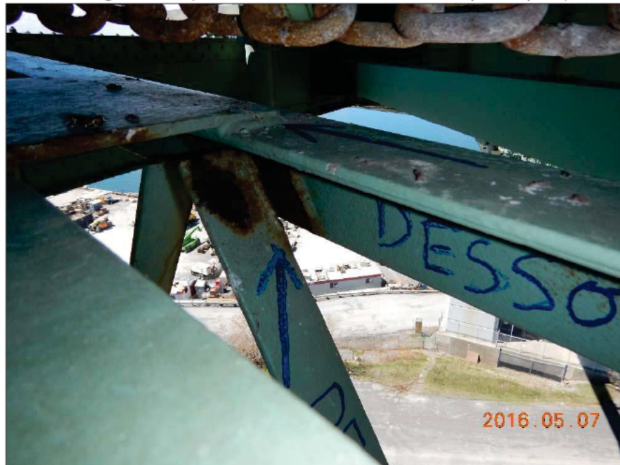
Photo 20150507 [REDACTED]_B905 : Axe 0.5W, Contreventement inférieur horizontal (L17-L16) Soudure sectionnée à une extrémité de la diagonale (cornière)
