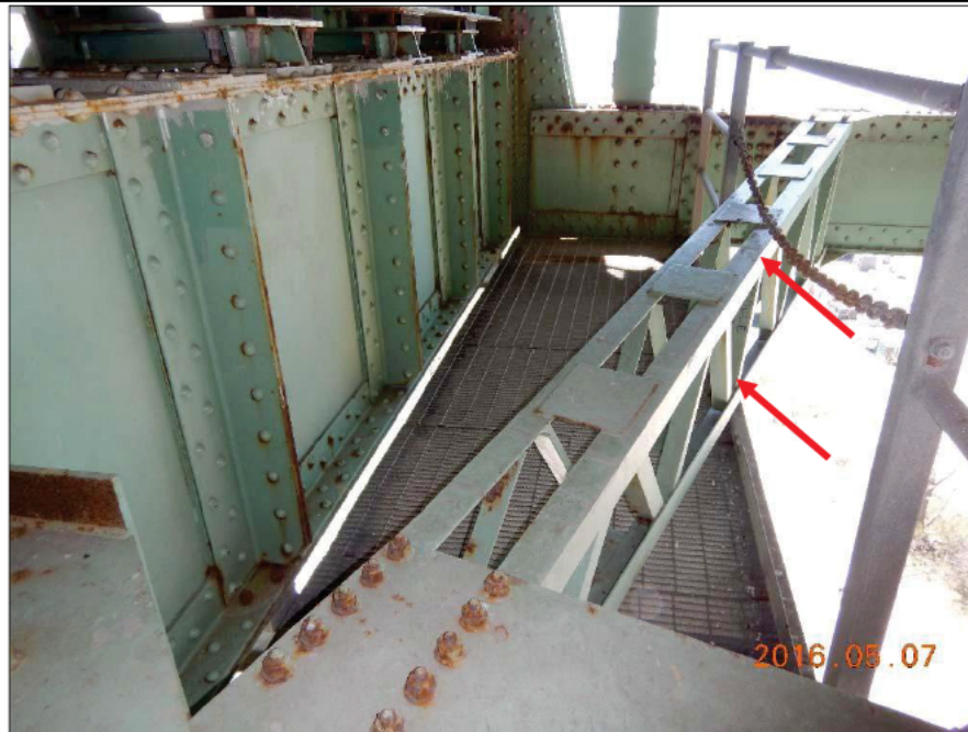
Photo 2015050 [REDACTED]_3910 : Axe 0.5W, Contreventement inférieur horizontal (L17-L16) Vue générale (avec localisation des défauts spécifiques)
