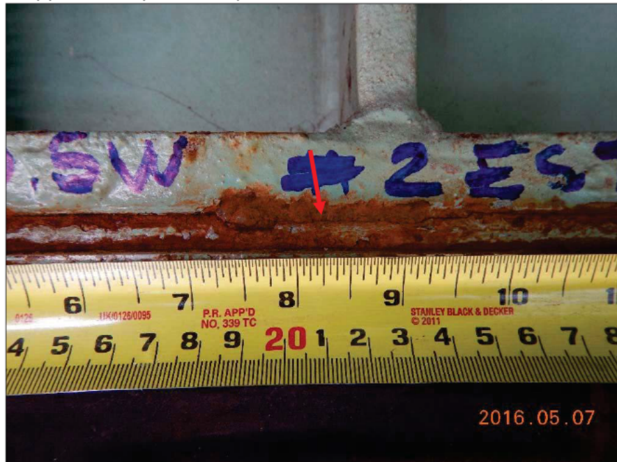
Photo 20150507 [REDACTED] 3888 : Axe 0.5W, Appareil d'appui à ressorts, groupe amont, série Est Appareil d'appui à la 2 e position à partir de la ferme amont, face Est, soudure fissurée
