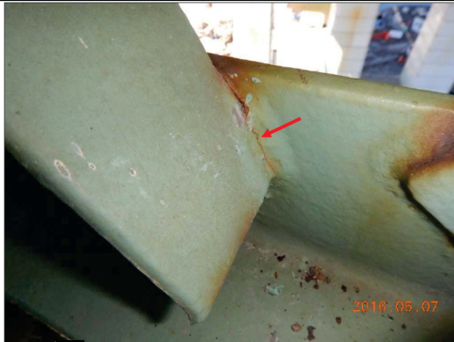
Photo 2015050 [REDACTED] 3909 : Axe 0.5W, Contreventement inférieur horizontal (L17-L16) Soudure fissurée à une extrémité (cornière)
