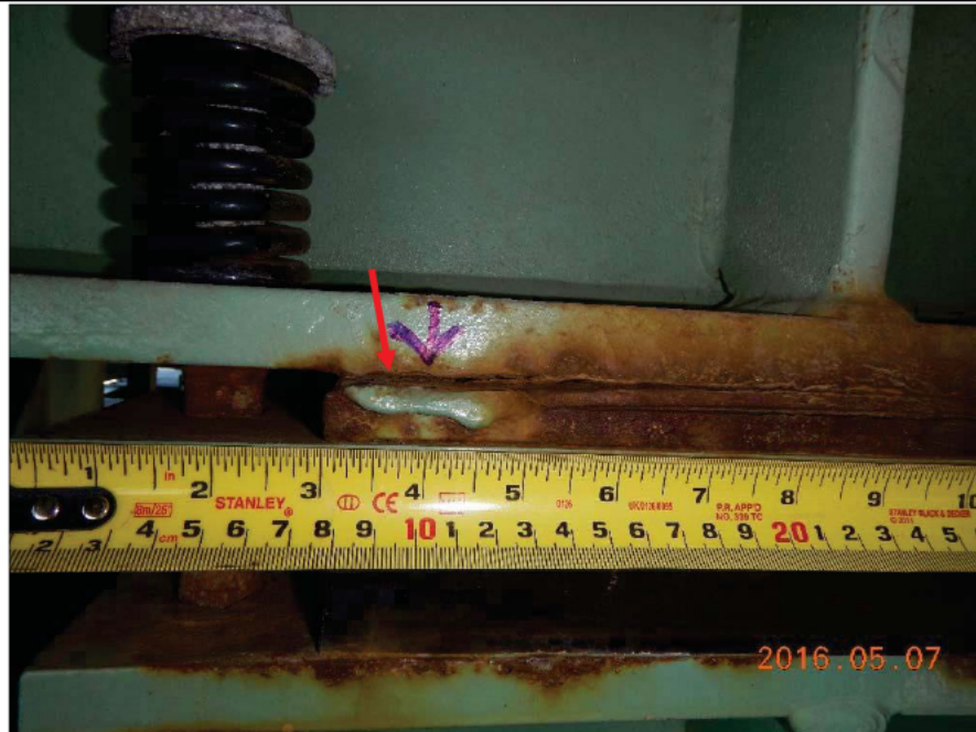
Photo 20150507 [redacted] 3914 : Axe 0.5W, Appareil d'appui à ressorts, groupe aval, série Ouest Appareil d'appui à la 18 e position à partir de la ferme amont, face Est, soudure fissurée
