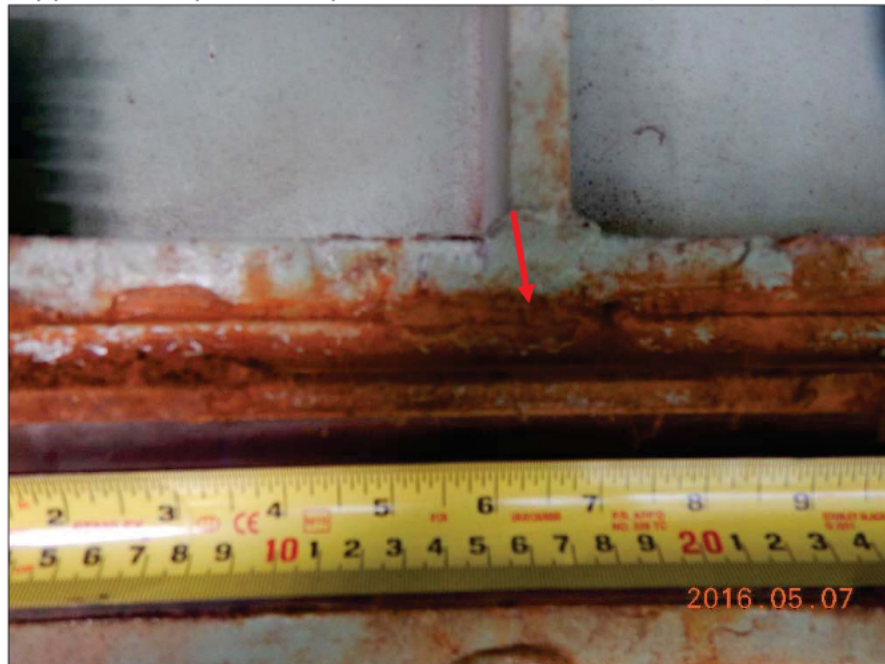
Photo 20150507 [REDACTED] 3884 : Axe 0.5W, Appareil d'appui à ressorts, groupe amont, série Est Appareil d'appui à la 1 re position à partir de la ferme amont, face Est, soudure fissurée
