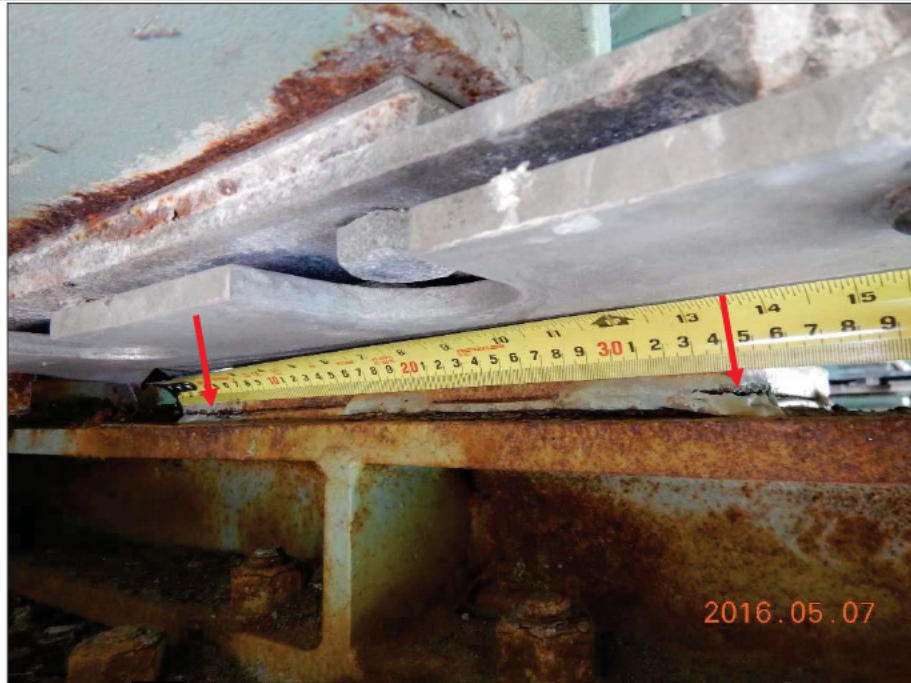
Photo 2015050 [REDACTED] 3852 : Axe 0.5E, Appareil d'appui mobile, groupe aval, série Est Appareil d'appui à la 10 e position à partir de la ferme amont, face amont, soudures fissurées
