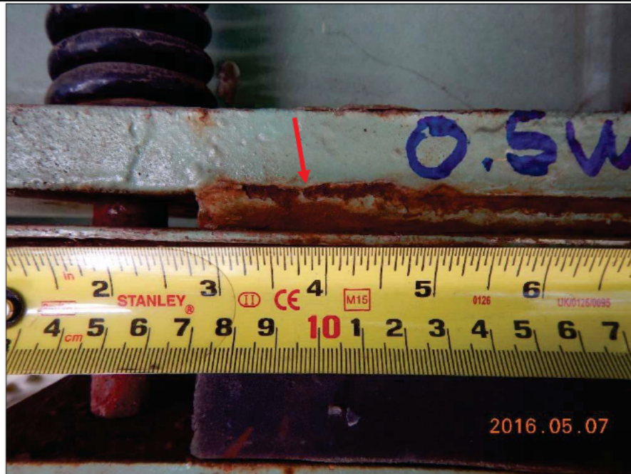
Photo 2015050 [REDACTED] 3887 : Axe 0.5W, Appareil d'appui à ressorts, groupe amont, série Est Appareil d'appui à la 2 e position à partir de la ferme amont, face Est, soudure fissurée
