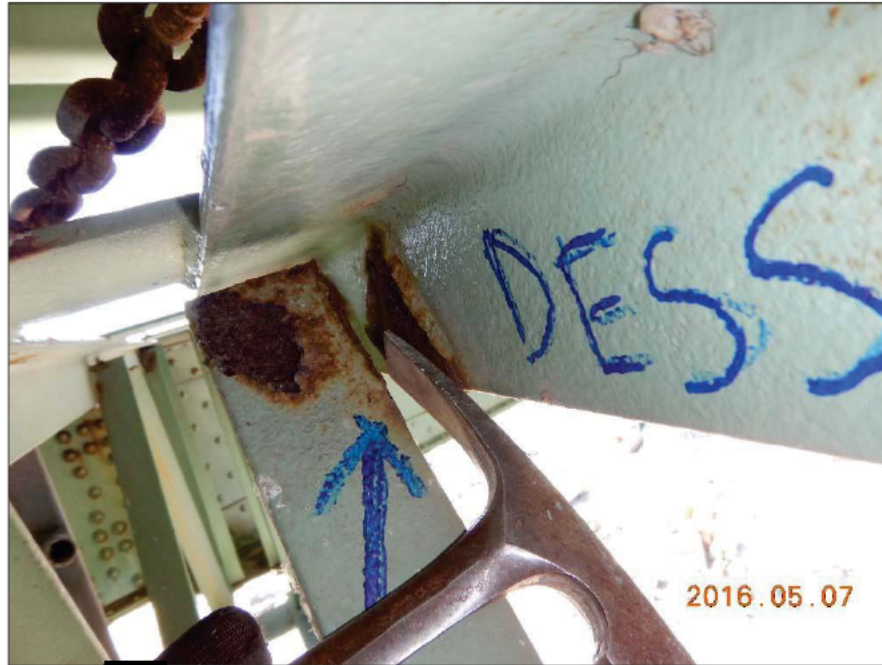
Photo 2015050 [REDACTED] 3906 : Axe 0.5W, Contreventement inférieur horizontal (L17-L16) Soudure sectionnée à une extrémité de la diagonale (cornière)
