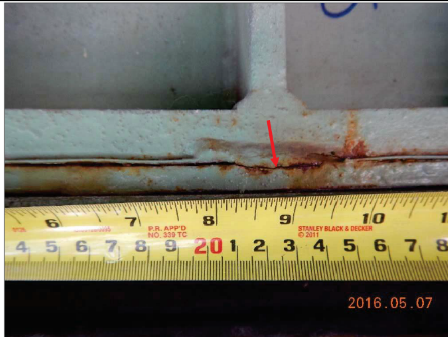
Photo 2015050 [redacted] 3897 : Axe 0.5W, Appareil d'appui à ressorts, groupe aval, série Est Appareil d'appui à la 16 e position à partir de la ferme amont, face Est, soudure fissurée
