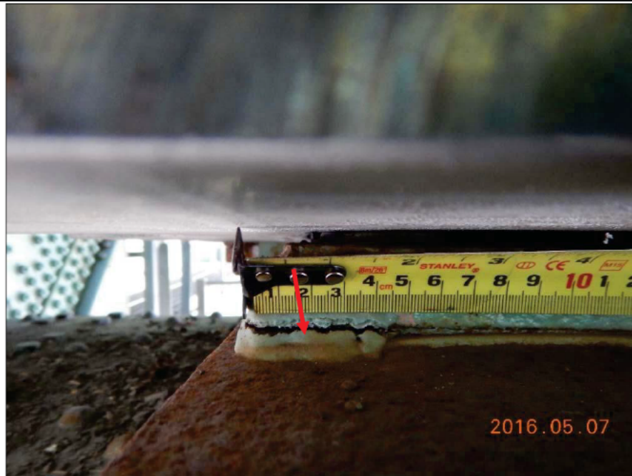
Photo 20150507 [REDACTED] 3851 : Axe 0.5E, Appareil d'appui mobile, groupe aval, série Est Appareil d'appui à la 10 e position à partir de la ferme amont, face Est, soudure fissurée
