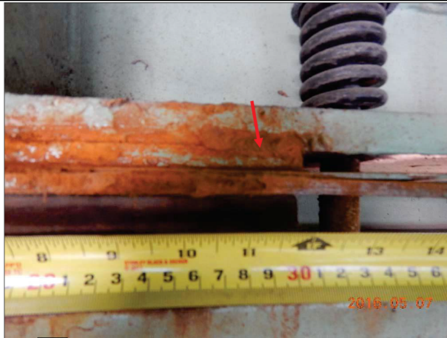
Photo 2015050 [REDACTED] 3885 : Axe 0.5W, Appareil d'appui à ressorts, groupe amont, série Est Appareil d'appui à la 1 re position à partir de la ferme amont, face Est, soudure fissurée
