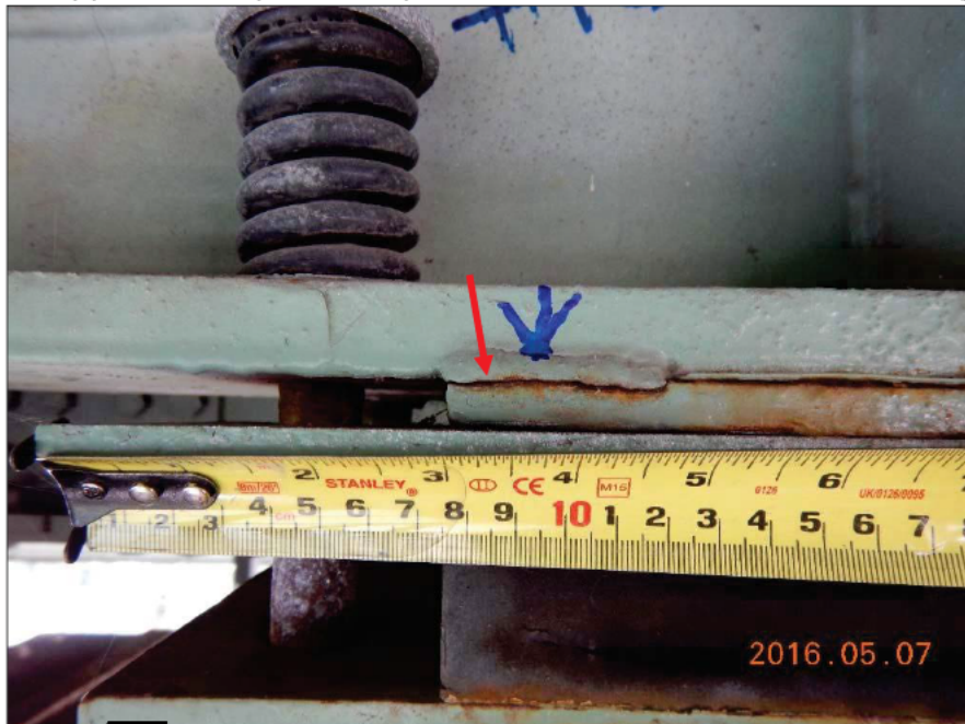
Photo 20150507 [REDACTED]_3896 : Axe 0.5W, Appareil d'appui à ressorts, groupe aval, série Est Appareil d'appui à la 16 e position à partir de la ferme amont, face Est, soudure fissurée
