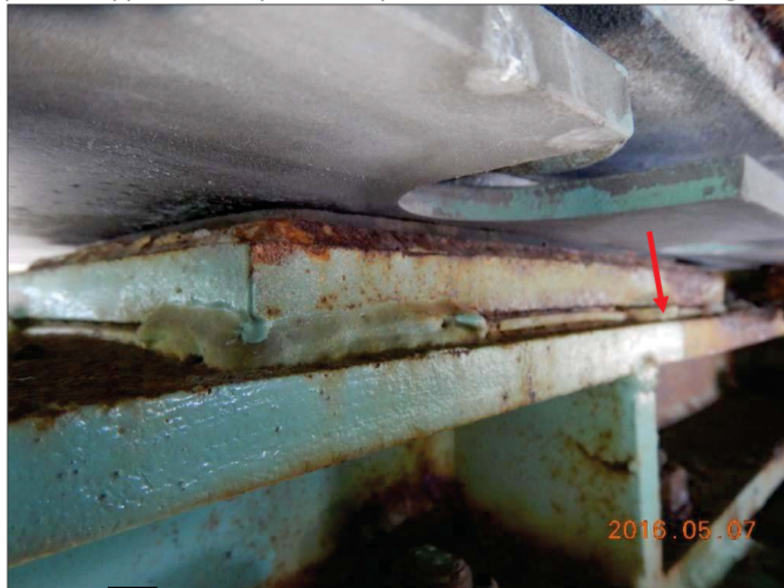
Photo 2015050 [REDACTED] 3847 : Axe 0.5E, Appareil d'appui mobile, groupe aval, série Est Appareil d'appui à la 10 e position à partir de la ferme amont, face aval, soudure fissurée
