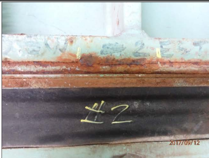
Photo 20170912_AF_1228 : Axe 0.5W, Appareil d'appui à ressorts, groupe amont, série Est Appareil d'appui à la 2 e position à partir de la ferme amont, face Est, soudure fissurée
