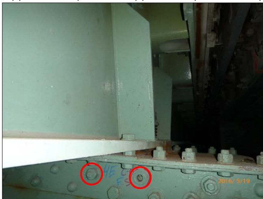
Photo 20160518_NP_0141 : Axe 4E, Ferme int. Aval, Assemblage supérieur U0, vue extérieure, face Amont Deux (2) boulons coupés et laissés en place
