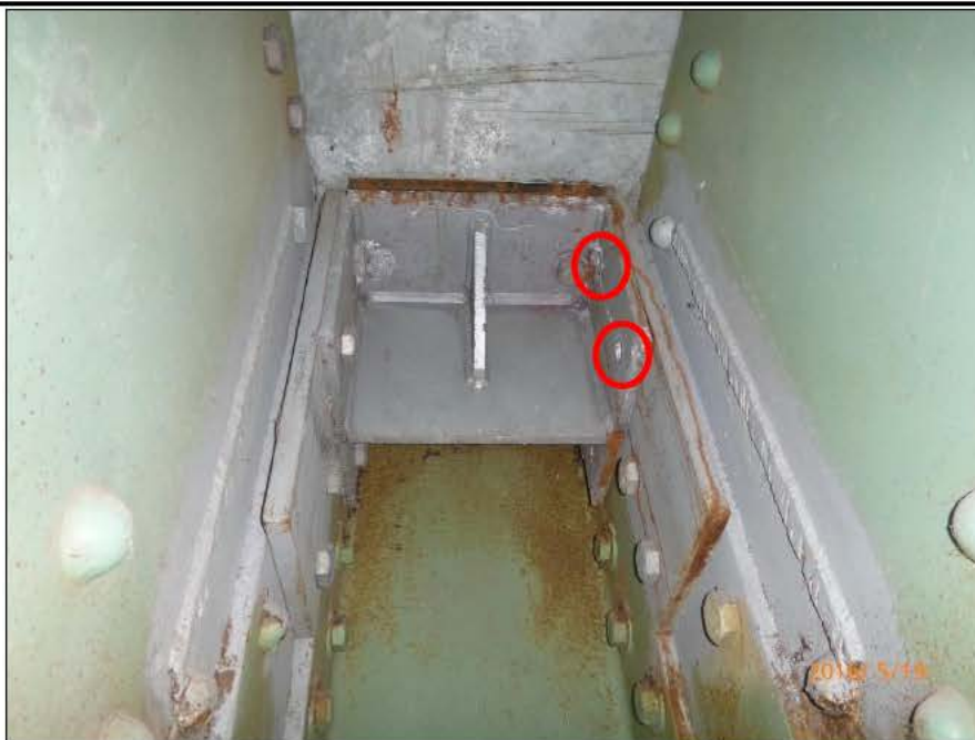
Photo 20160518_NP_0137 : Axe 4E, Ferme int. Aval, Assemblage supérieur U0, vue intérieure, face Montréal Deux (2) boulons manquants du côté Amont
