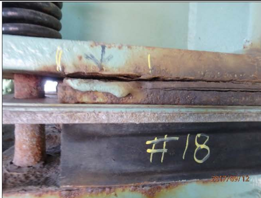
Photo 20170912_AF_1247 : Axe 0.5W, Appareil d'appui à ressorts, groupe aval, série Ouest Appareil d'appui à la 18 e position à partir de la ferme amont, face Est, soudure fissurée
