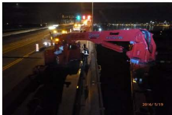
Figure 2 : Exemple d'inspection détaillée des joints et des éléments sensibles, en camion-nacelle sur le tablier
