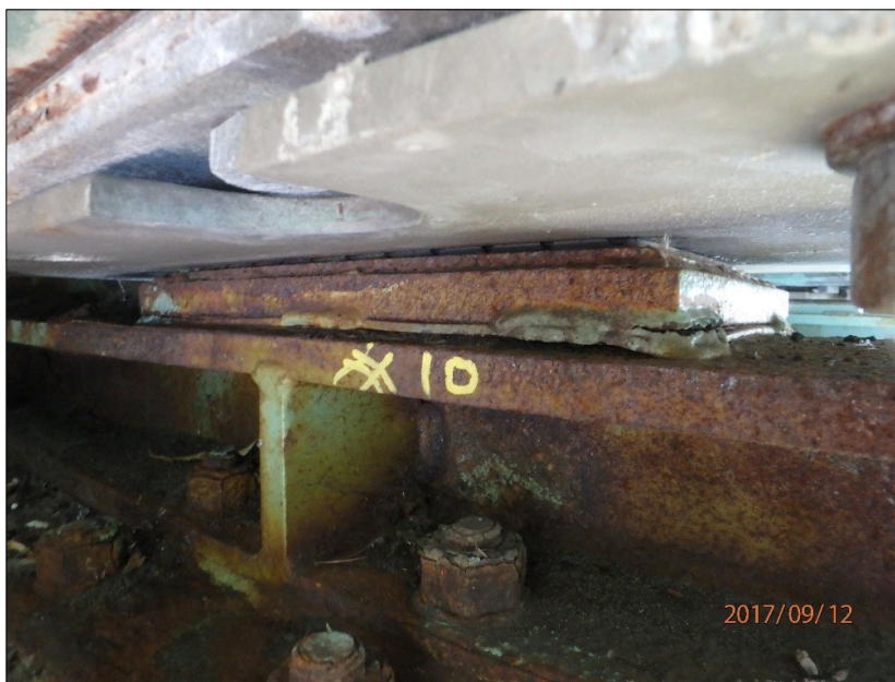
Photo 20170912_AF_1207 : Axe 0.5E, Appareil d'appui mobile, groupe aval, série Est Appareil d'appui à la 10 e position à partir de la ferme amont, face amont, soudure fissurée
