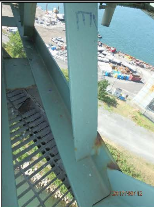
Photo 20170912_AF_1239 : Axe 0.5W, Contreventement inférieur horizontal (L17-L16) Soudure sectionnée à une extrémité de la diagonale (cornière)
