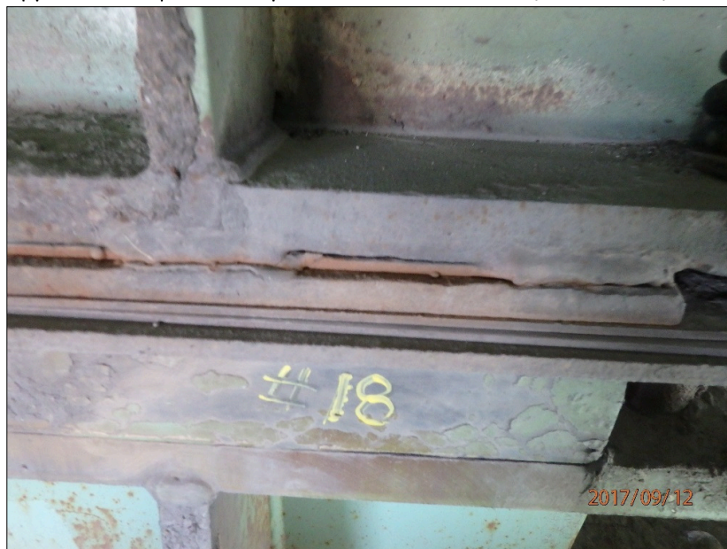
Photo 20170912_AF_1222 : Axe 0.5E, Appareil d'appui à ressorts, groupe aval, série Ouest Appareil d'appui à la 18 e position à partir de la ferme amont, face Ouest, soudure fissurée
