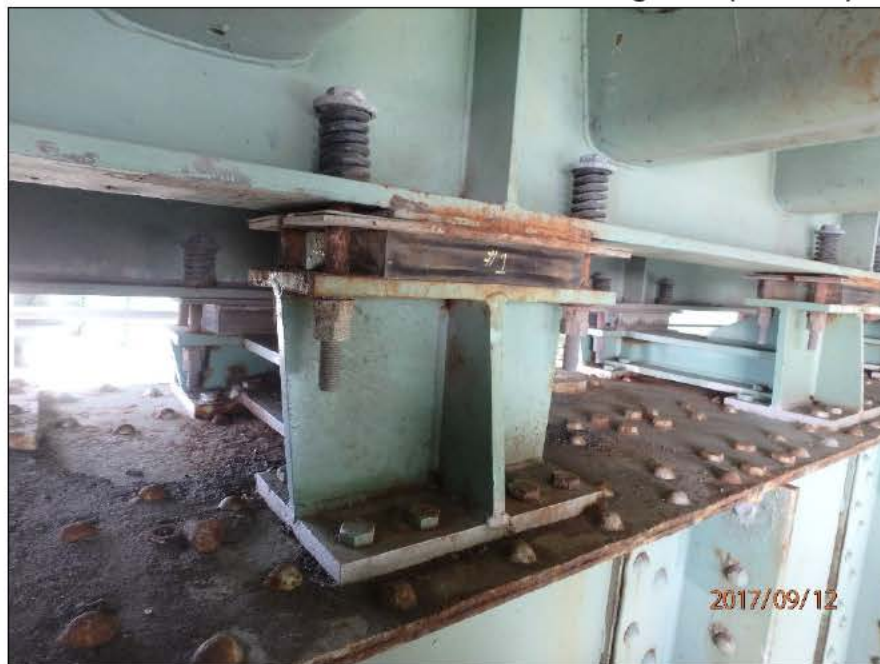
Photo 20170912_AF_1225 : Axe 0.5W, Appareil d'appui à ressorts, groupe amont, série Est Appareil d'appui à la 1 re position à partir de la ferme amont, face Est, vue générale
