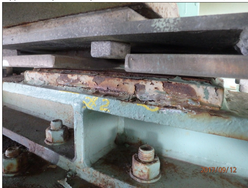
Photo 20170912_AF_1204 : Axe 0.5E, Appareil d'appui mobile, groupe amont, série Est Appareil d'appui à la 2 ème position à partir de la ferme amont, face Est, soudure fissurée
