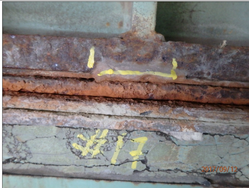
Photo 20170912_AF_1220 : Axe 0.5E, Appareil d'appui à ressorts, groupe aval, série Ouest Appareil d'appui à la 17 e position à partir de la ferme amont, face Ouest, soudure fissurée
