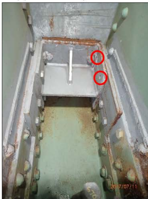
Photo 20170710_HA_4182 : Axe 4E, Ferme int. Aval, Assemblage supérieur U0, vue intérieure, face Montréal Deux (2) boulons manquants du côté Amont
