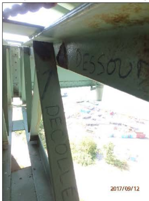
Photo 20170912_AF_1237 : Axe 0.5W, Contreventement inférieur horizontal (L17-L16) Soudure sectionnée à une extrémité de la diagonale (cornière)
