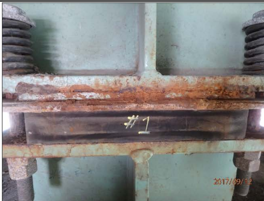
Photo 20170912_AF_1226 : Axe 0.5W, Appareil d'appui à ressorts, groupe amont, série Est Appareil d'appui à la 1 re position à partir de la ferme amont, face Est, soudure fissurée
