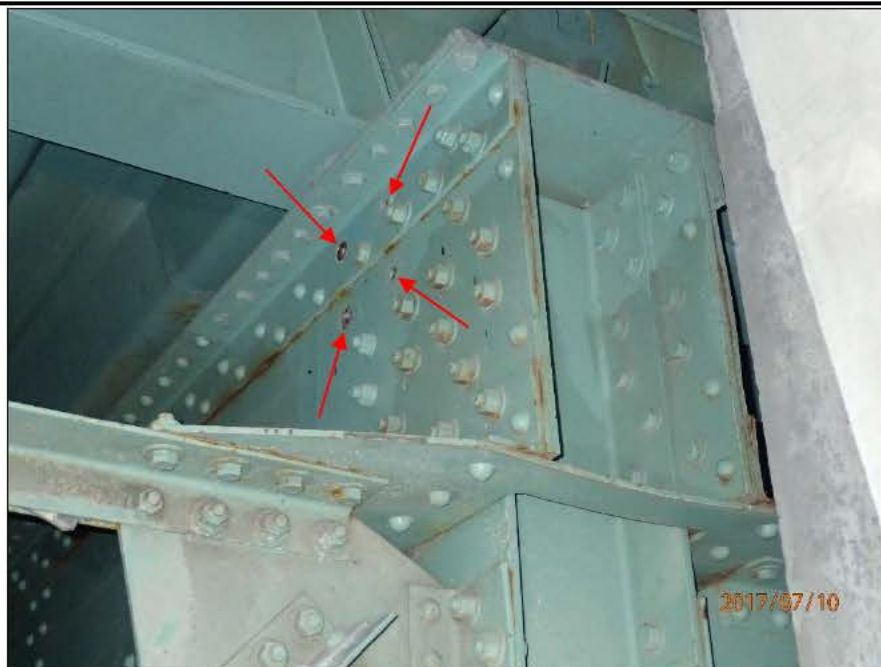
Photo 20170710_HA_4153 : Axe 4E, Ferme int. Aval, Assemblage supérieur U0, vue extérieure, face Amont Quatre (4) boulons manquants du côté Amont
