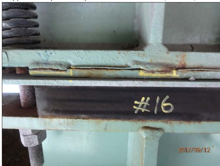
Photo 20170912_AF_1234 : Axe 0.5W, Appareil d'appui à ressorts, groupe aval, série Est Appareil d'appui à la 16 e position à partir de la ferme amont, face Est, soudure fissurée
