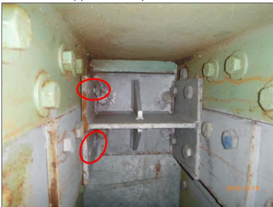
Photo 20160518_NP_0138 : Axe 4E, Ferme int. Aval, Assemblage supérieur U0, vue intérieure, dessous Trois (3) boulons manquants et un (1) boulon coupé et laissé en place du côté Amont
