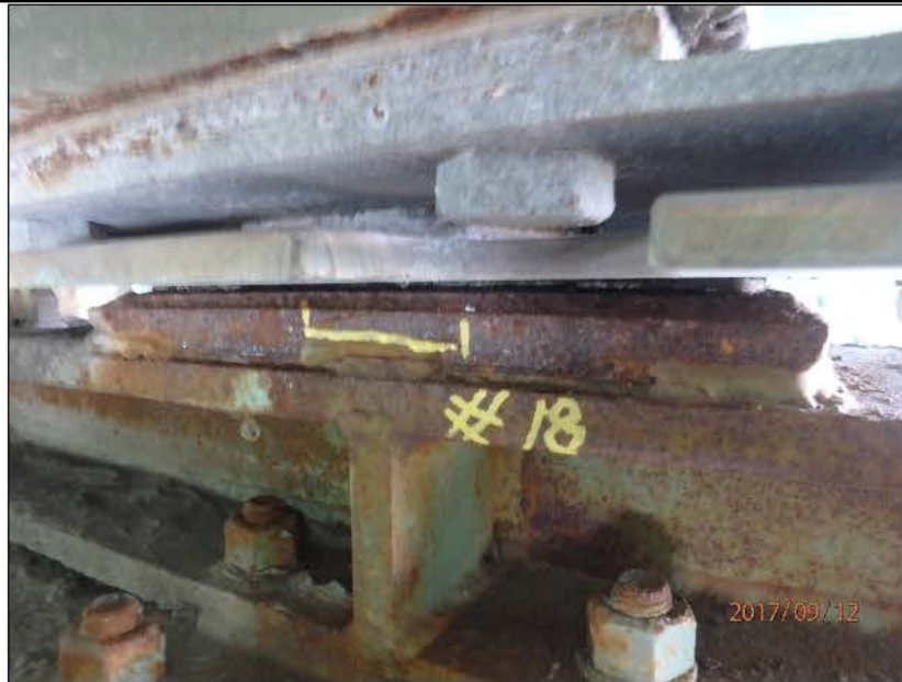
Photo 20170912_AF_1210 : Axe 0.5E, Appareil d'appui mobile, groupe aval, série Est Appareil d'appui à la 18 e position à partir de la ferme amont, face Est, soudure fissurée
