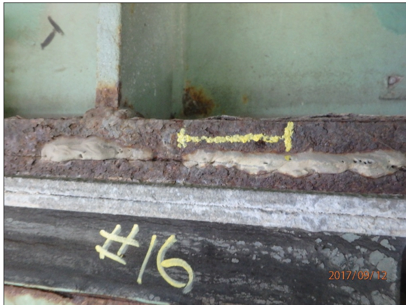
Photo 20170912_AF_1218 : Axe 0.5E, Appareil d'appui à ressorts, groupe aval, série Ouest Appareil d'appui à la 16 e position à partir de la ferme amont, face Ouest, soudure fissurée
