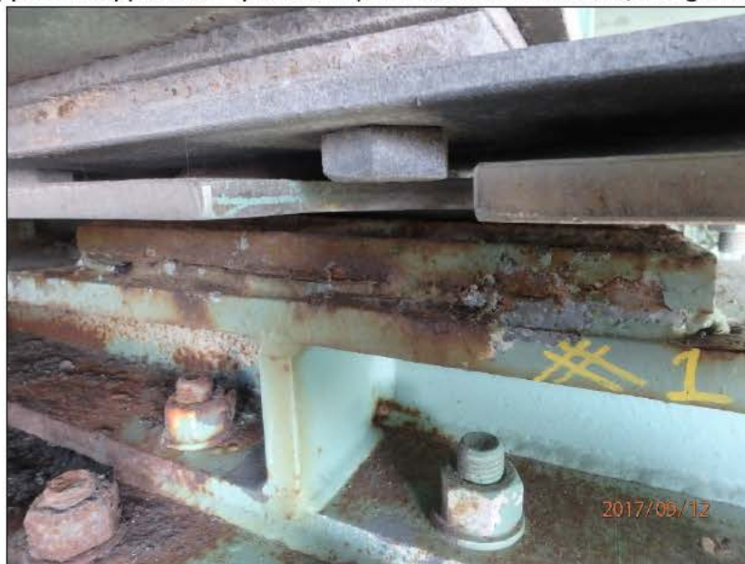
Photo 20170912_AF_1201 : Axe 0.5E, Appareil d'appui mobile, groupe amont, série Est Appareil d'appui à la 1 e position à partir de la ferme amont, face amont, soudure fissurée
