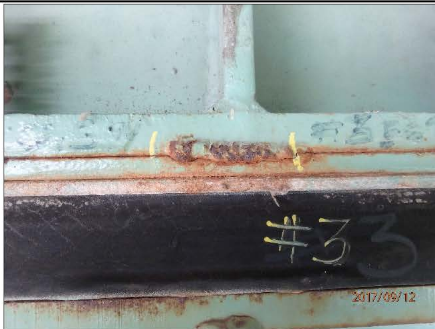
Photo 20170912_AF_1230 : Axe 0.5W, Appareil d'appui à ressorts, groupe amont, série Est Appareil d'appui à la 3 e position à partir de la ferme amont, face Est, soudure fissurée
