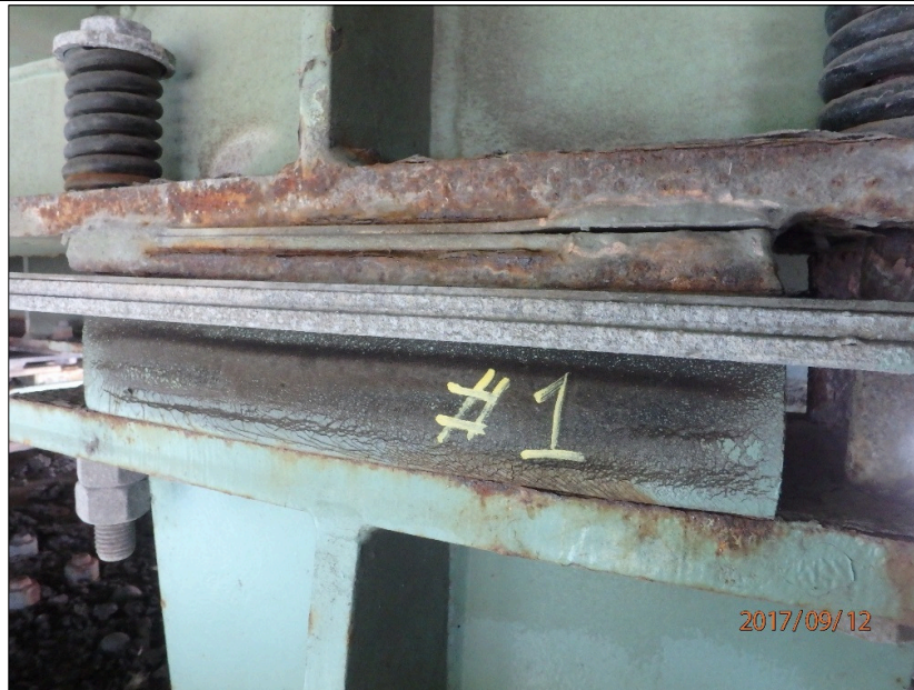
Photo 20170912_AF_1214 : Axe 0.5E, Appareil d'appui à ressorts, groupe amont, série Ouest Appareil d'appui à la 1 ère position à partir de la ferme amont, face Ouest, soudure fissurée
