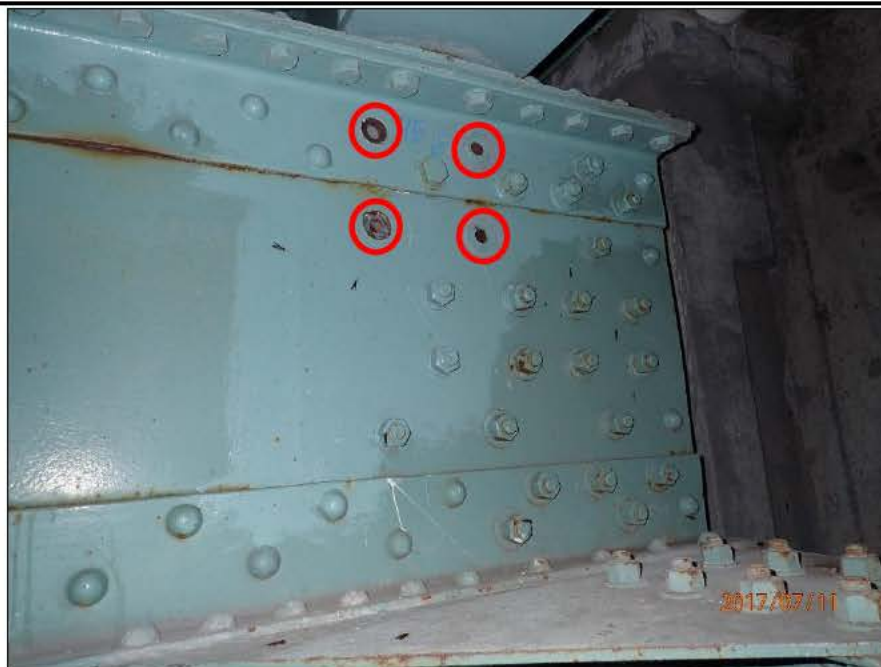
Photo 20170710_HA_4177 : Axe 4E, Ferme int. Aval, Assemblage supérieur U0, vue extérieure, face Amont Quatre (4) boulons manquants du côté Amont
