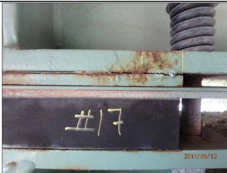
Photo 20170912_AF_1245 : Axe 0.5W, Appareil d'appui à ressorts, groupe aval, série Ouest Appareil d'appui à la 17 e position à partir de la ferme amont, face Est, soudure fissurée
