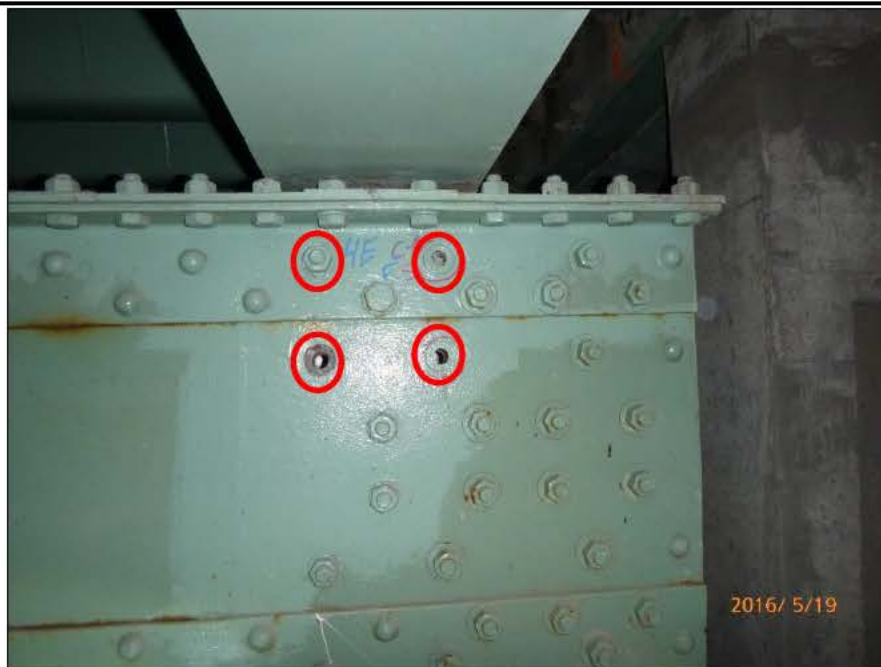
Photo 20160518_NP_0139 : Axe 4E, Ferme int. Aval, Assemblage supérieur U0, vue extérieure, face Amont Deux (2) boulons manquants et deux (2) boulons coupés et laissés en place
