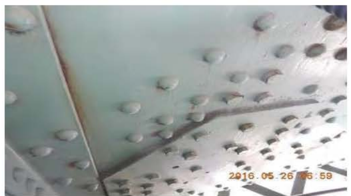
Photo plaque amont, face intérieure:
