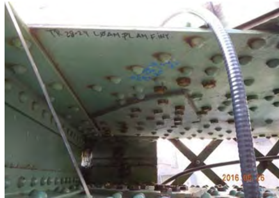
Photo plaque amont, face intérieure:
