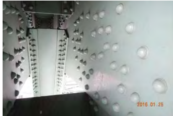
Photo plaque amont, face intérieure:
