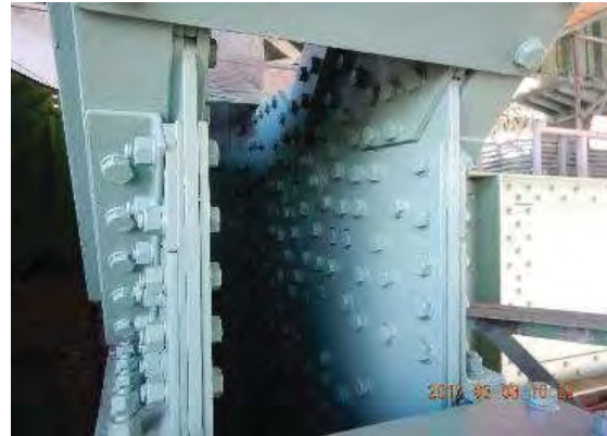
Photo plaque amont, face intérieure:
