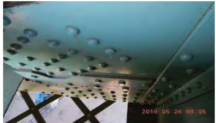
Photo plaque amont, face intérieure:
