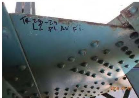
Photo plaque amont, face intérieure:
