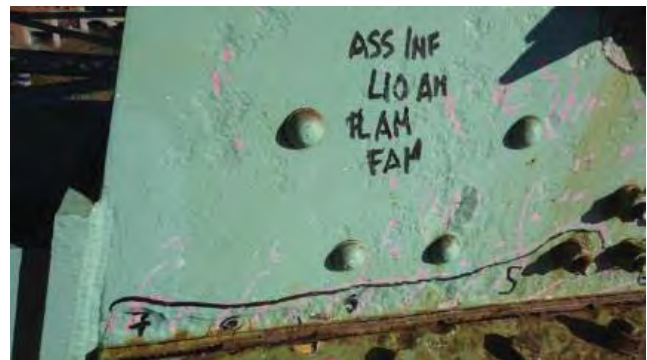
Photo plaque amont, face intérieure:
