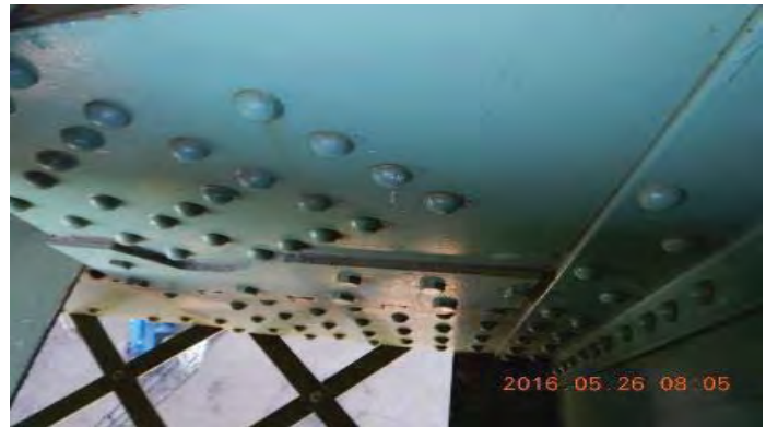
Photo plaque amont, face intérieure:
