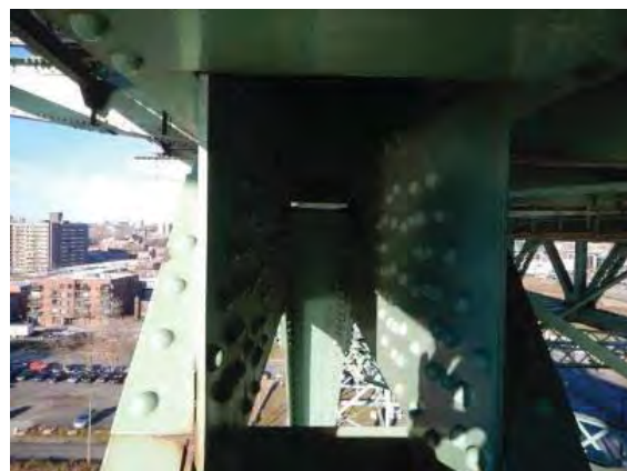
Photo plaque amont, face intérieure:
