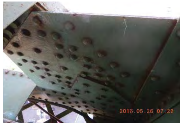
Photo plaque amont, face intérieure:
