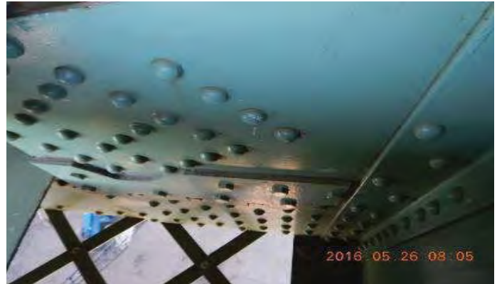
Photo plaque amont, face intérieure:
