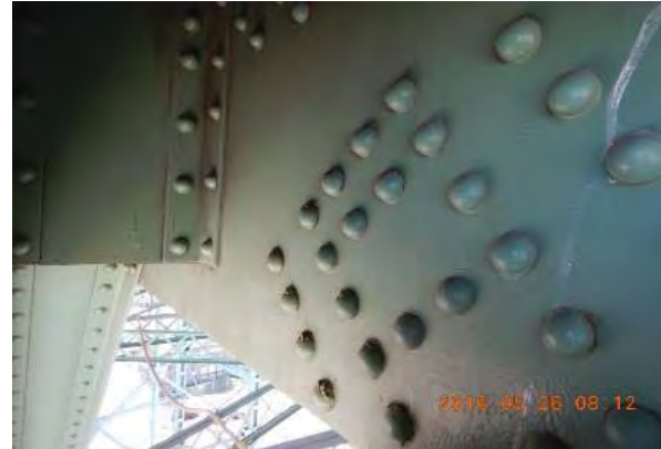
Photo plaque amont, face intérieure:
