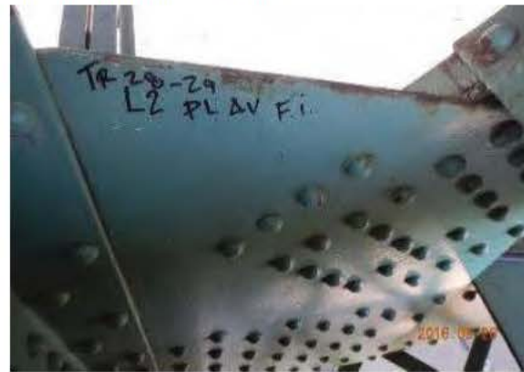
Photo plaque amont, face intérieure:
