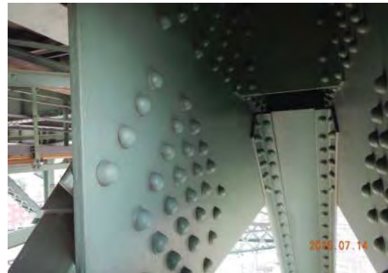
Photo plaque amont, face intérieure:
