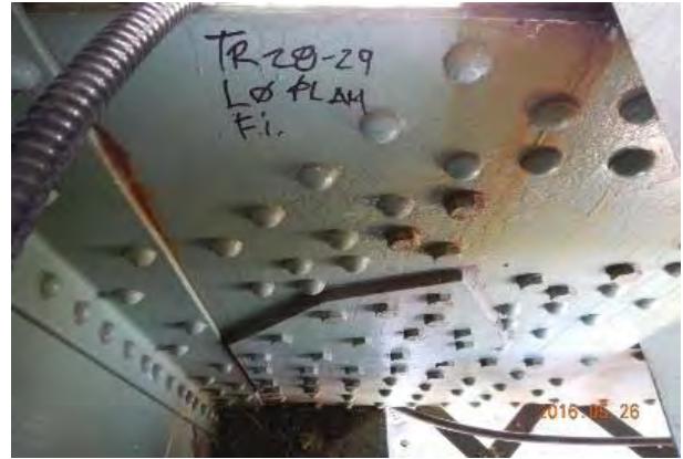
Photo plaque amont, face intérieure:
