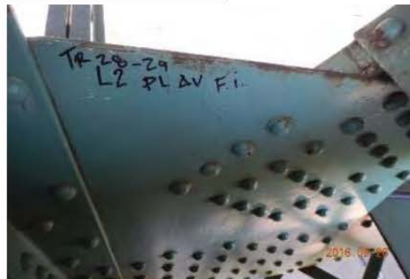
Photo plaque amont, face intérieure:
