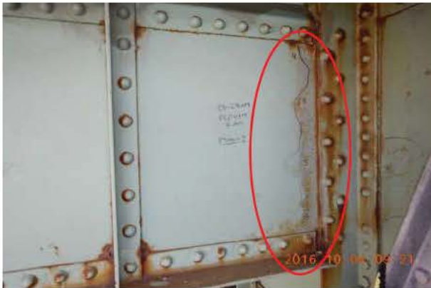
Photo sud amont
