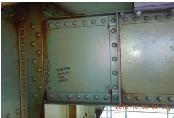
Photo sud amont
