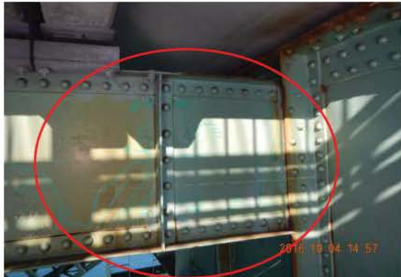
Photo sud amont
