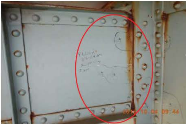
Photo sud amont
