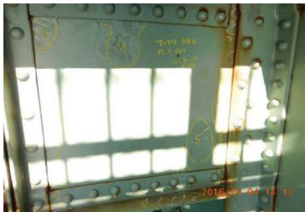
Photo sud amont
