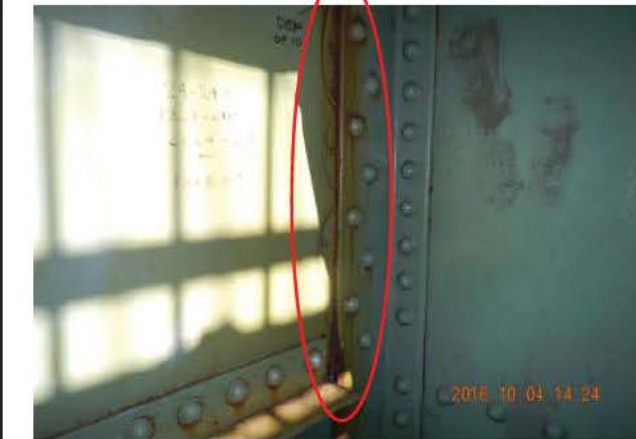
Photo sud amont
