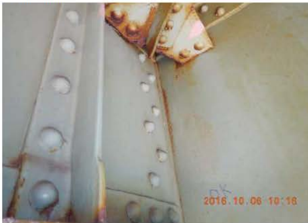
Photo sud amont
