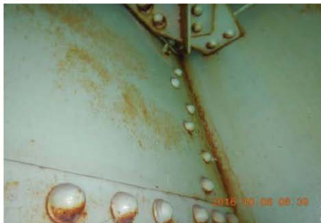
Photo sud amont
