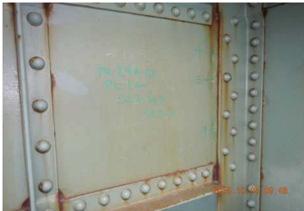
Photo sud amont
