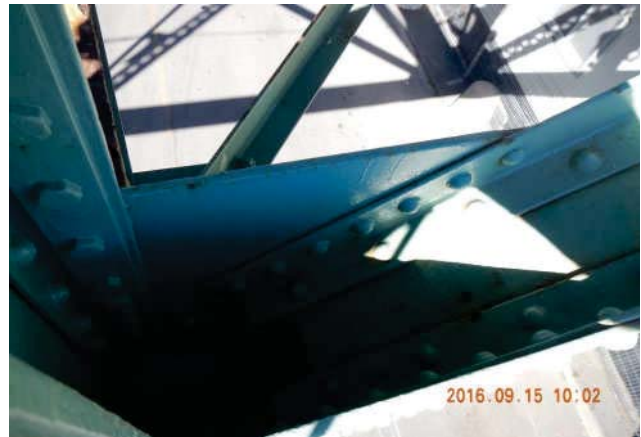
Photo plaque amont, face intérieure
