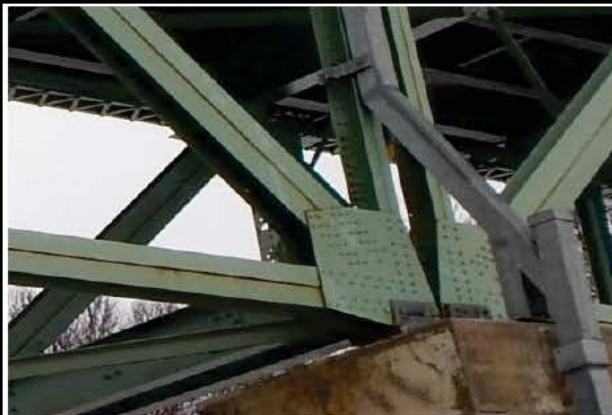
Photo 1: Nœud L0, face Nord JC_5_20160126_JM_8540
