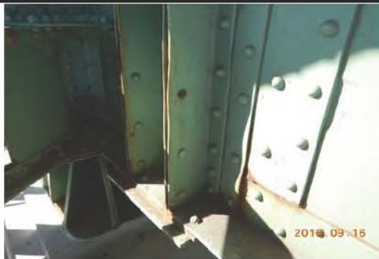
Photo 1: Poutre de levage JC_4_160916_8698
