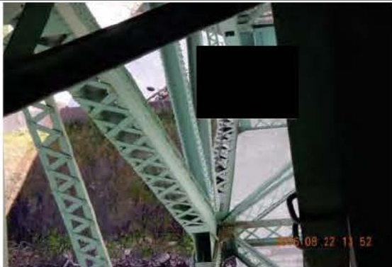
Photo 1: Corde inférieure L0-L2 JC_4_160822_JM_0565
