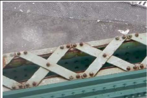
Photo 2: Corde inférieure JC_4_160822_EM_9000
