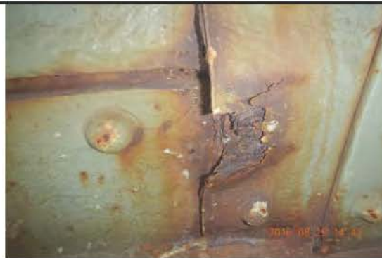
Photo 1: Poutre de levage 1
