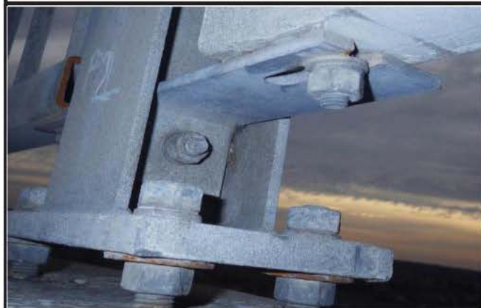
Photo 1: Dispositif de retenue
