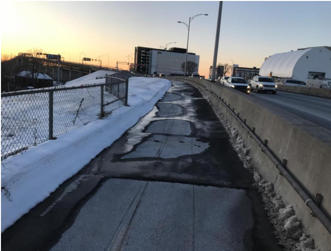
Figure 19 : Bordure de neige fondante laissant sur la piste des coulisses d'eau propices au gel
