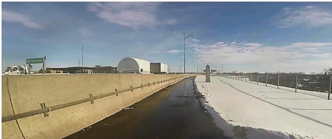
Figure 13 : Surface mouillée et non drainée à la section 1 du pont Jacques-Cartier
